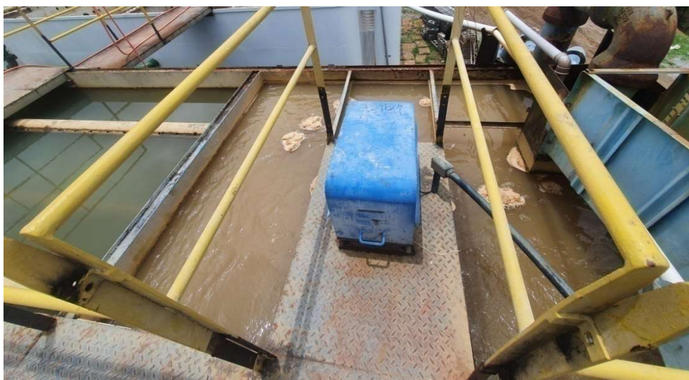
Tanque de floculação do Módulo 1
