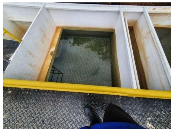
Tanque de decantação do Módulo 3.
