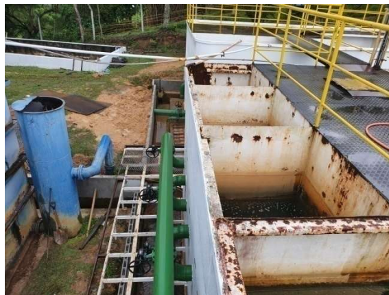
Filtros do Módulo 2
