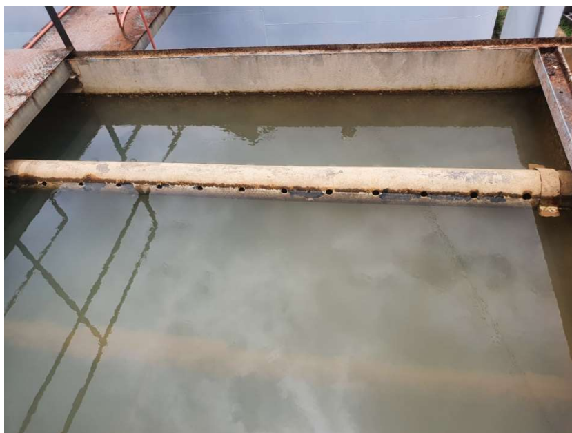
Tanque de decantador do Módulo 1.
