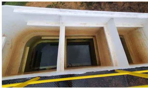
Filtros do Módulo 3.
