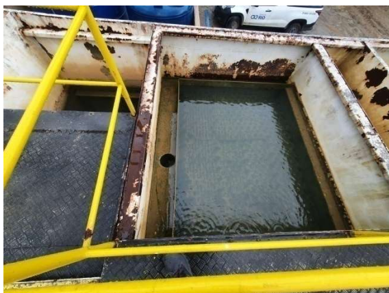
Tanque de decantação do Módulo 2.
