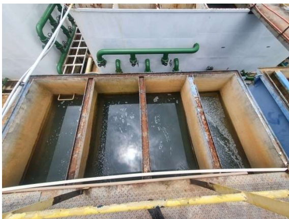
Filtros do Módulo 1.
