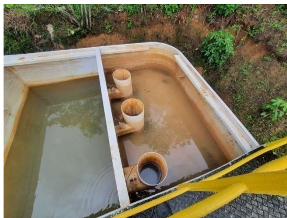
Tanque de floculação do Módulo 3.
