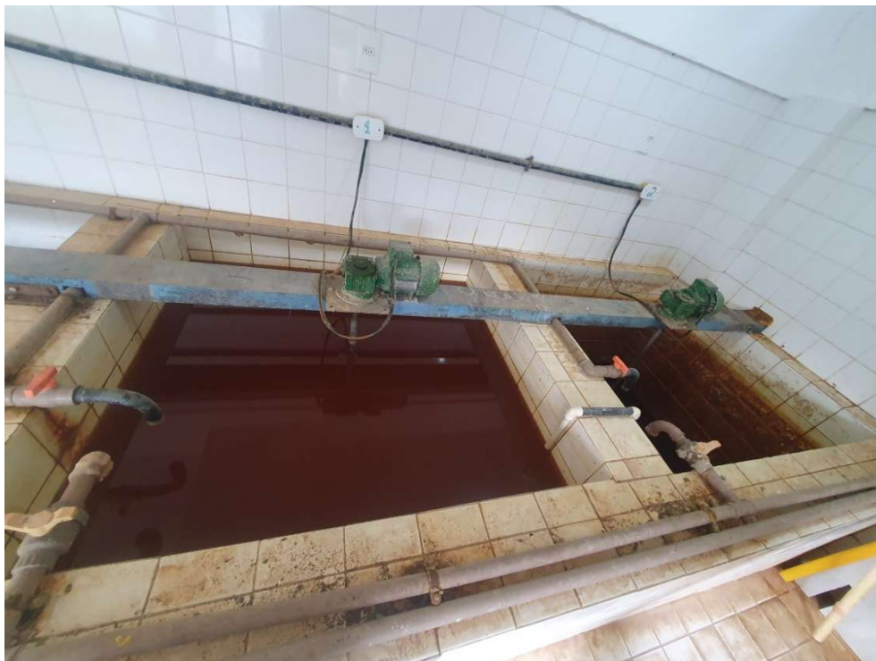
Tanque de armazenamento e preparo do coagulante
