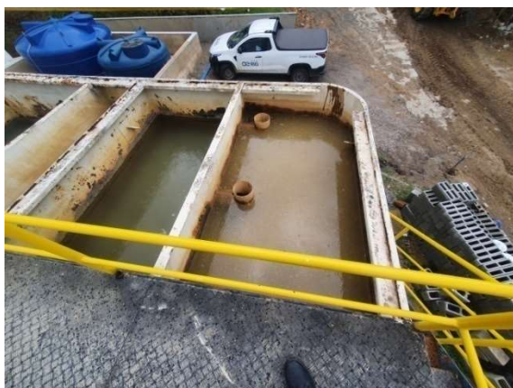
Tanque de floculação do Módulo 2.
