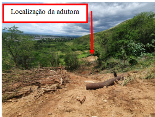
Foto nº 1 - Danos causados pela água no próprio logradouro do Reservatório Marapicu
