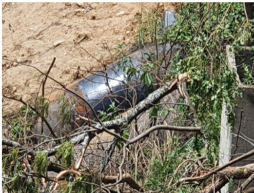
Foto nº 3 - Detalhe da Adutora de recalque pode-se observar o trecho onde ocorreu o remendo.
