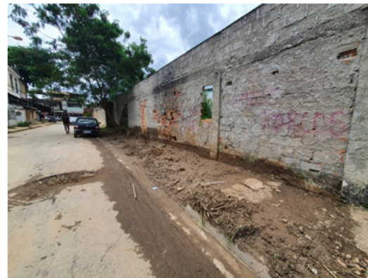
Foto nº 8 - Rua das Tulipas verifica-se que falta a conclusão da desobstrução e limpeza da calçada.
