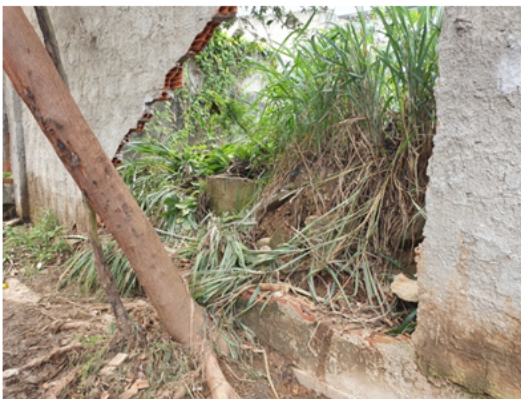
Foto nº 5 - Rua das Tulipas verifica-se que falta recuperação do muro danificado pela água.
