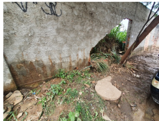
Foto nº 6 - Rua das Tulipas verifica-se que falta recuperação do muro danificado pela água.
