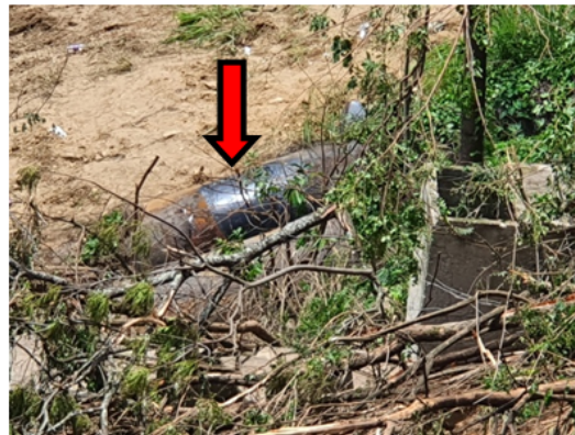
Foto nº 2 - Vista da Adutora de recalque pode-se observar o trecho onde ocorreu o remendo.
