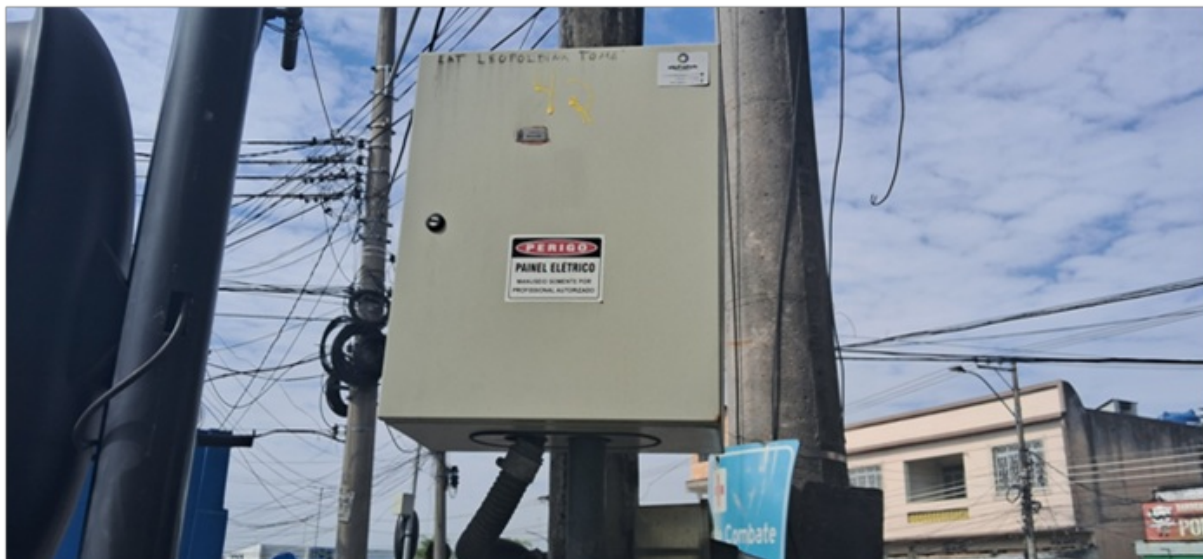
Foto 04 – Quadro elétrico de comando. Verifica-se ausência de identificação. Não foi permitida a visualização do interior.
