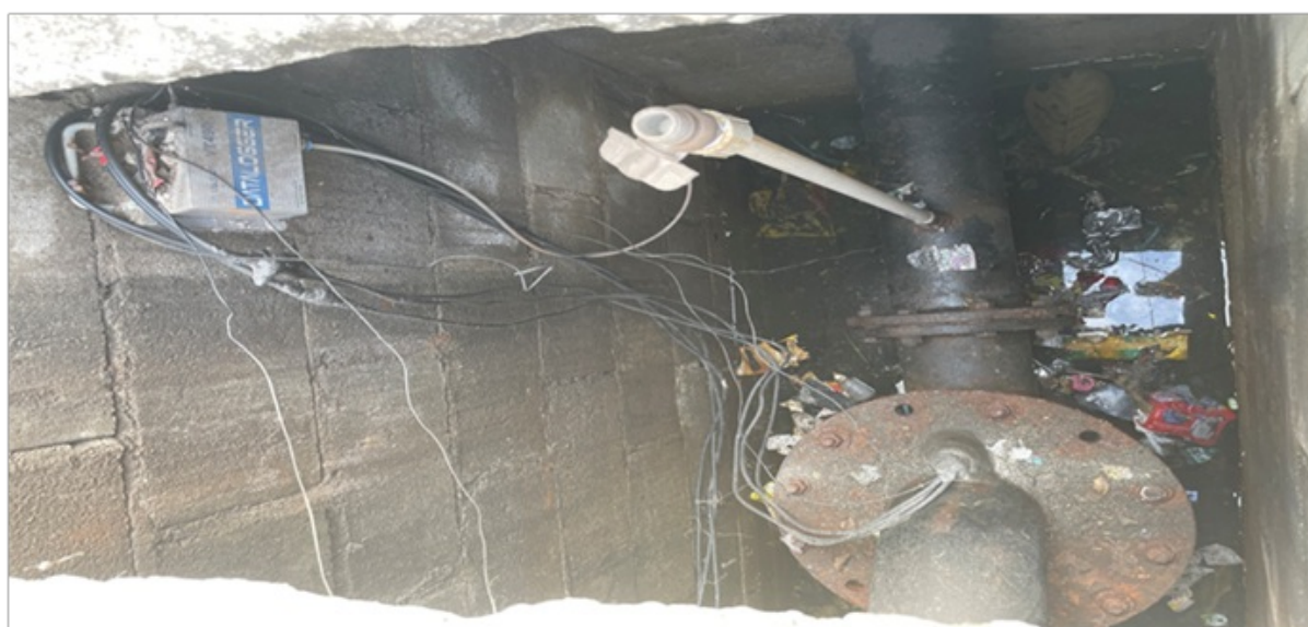
Foto 02 – Vista do interior do poço da bomba.
