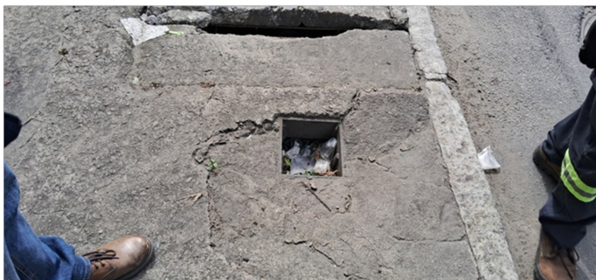
Foto 03 – Registro de retaguarda. Verifica-se ausência de tampa e sujidades.
