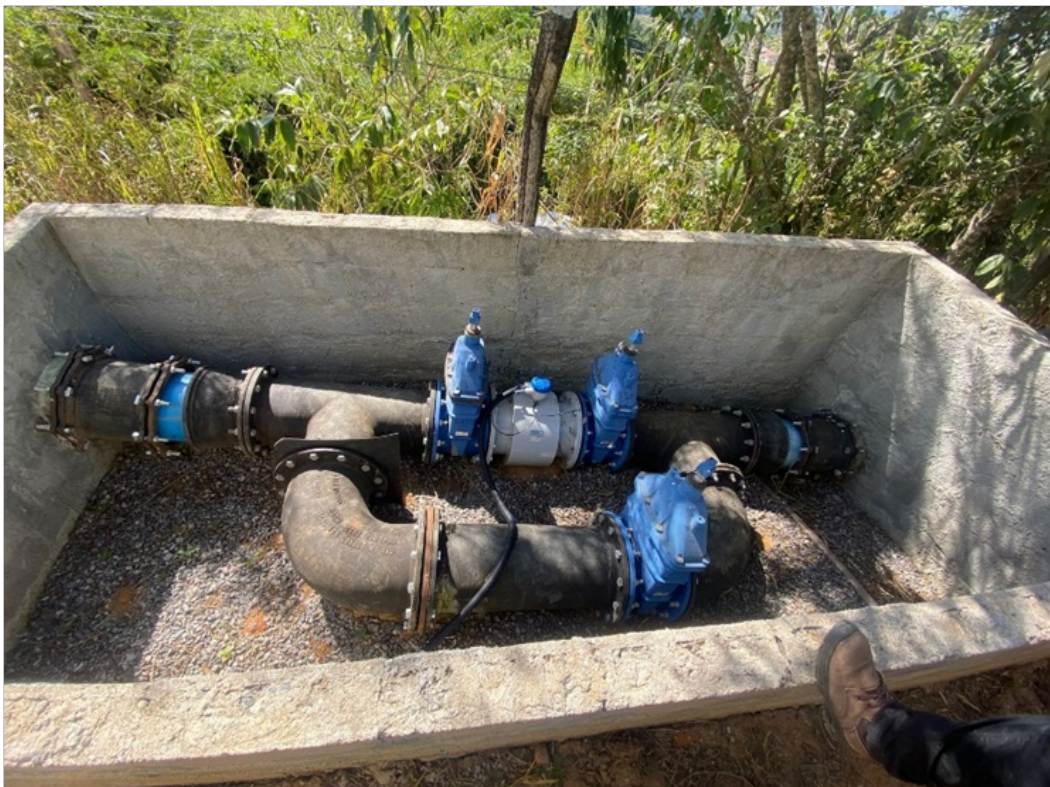
Foto 6 – Tubulação de distribuição com Macromedidor
