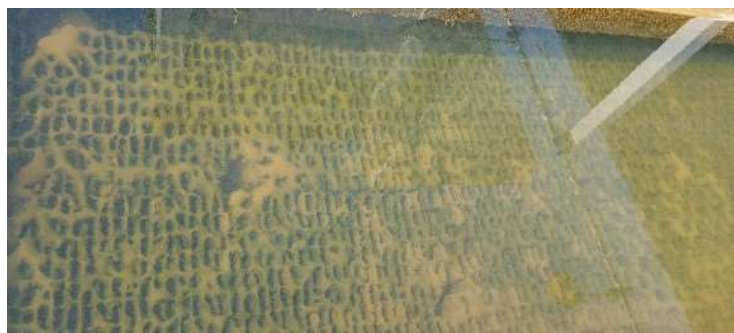
Falta de limpeza dos decantadores. Os efluentes são encaminhados para rede águas pluviais
