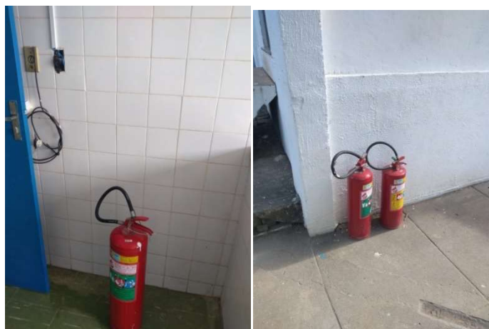
Equipamento instalado em desacordo Código de Segurança contra Incêndio e Pânico
