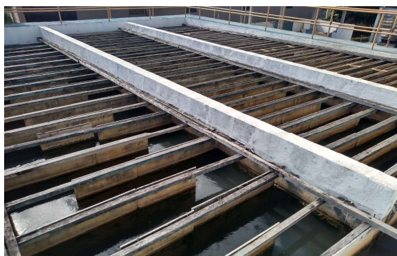
Falta de manutenção nos defletores (Placas de Madeira) do floculador
