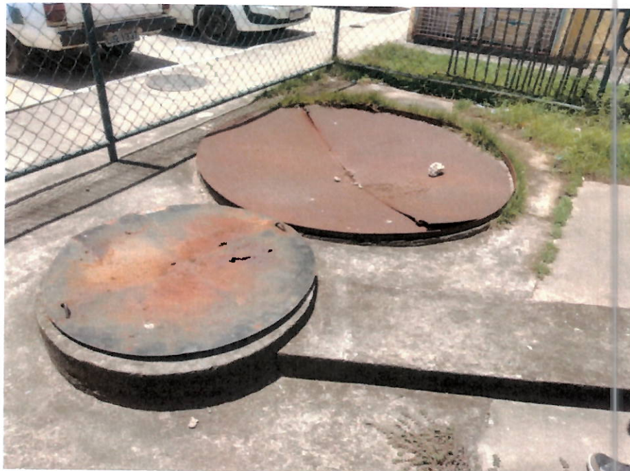
Foto 7 – Estação elevatória de esgoto e caixa retentora de resíduos sólidos (tratamento primário)
