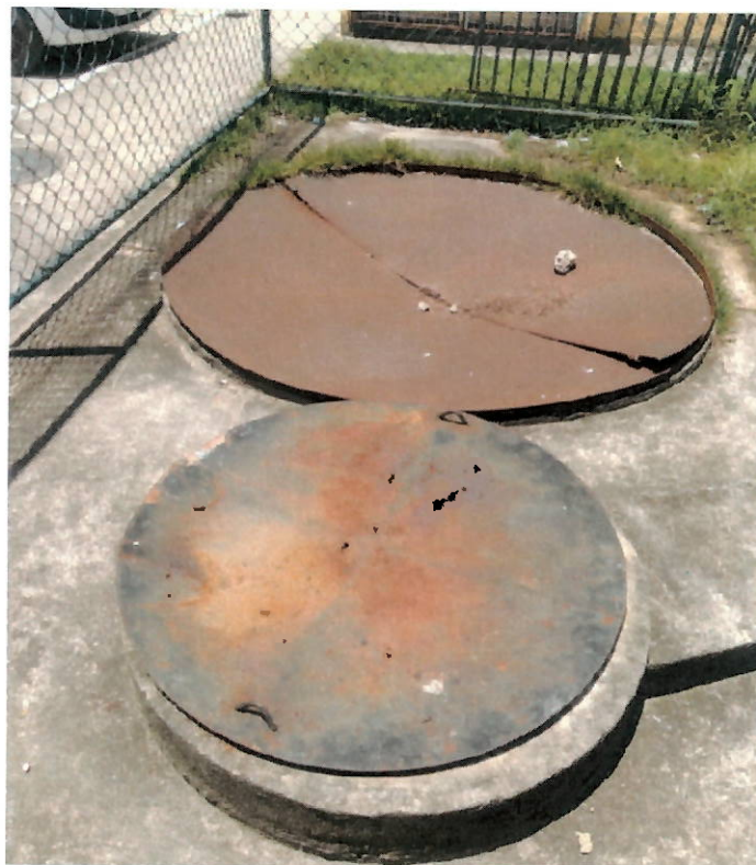
Foto 8 – Estação elevatória de esgoto e caixa retentora de resíduos sólidos (tratamento preliminar)
