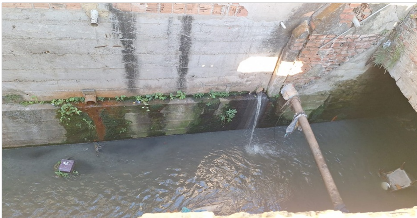
Foto 2 – Esgoto lançado no canal sem tratamento primário, irregular em qualquer época.
