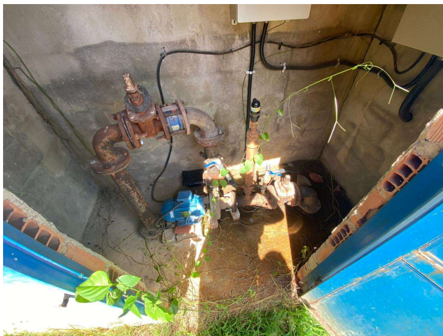
Parte interna da casa do Booster
