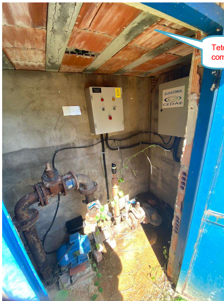
Parte interna da casa do Booster
