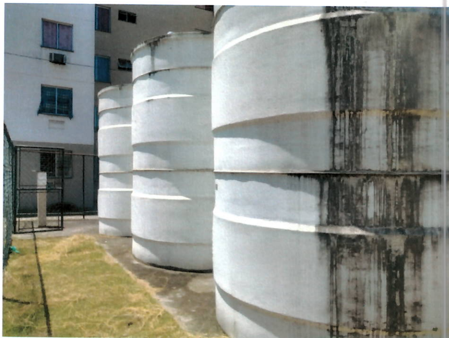
Foto 3 – Tanques anaeróbios em série (Chicanas)
