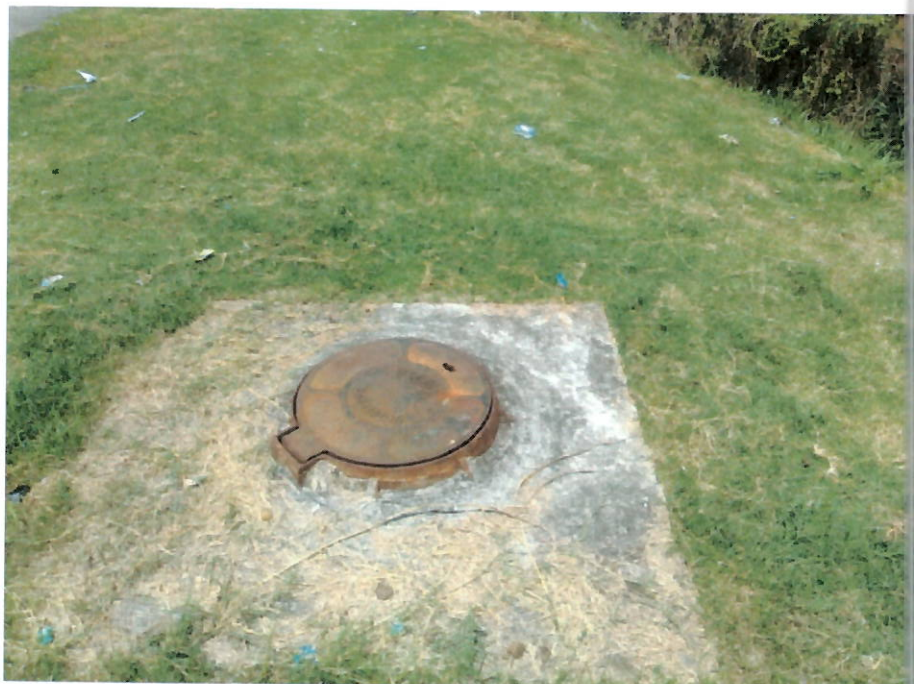
Foto 4 – Poço de visita
