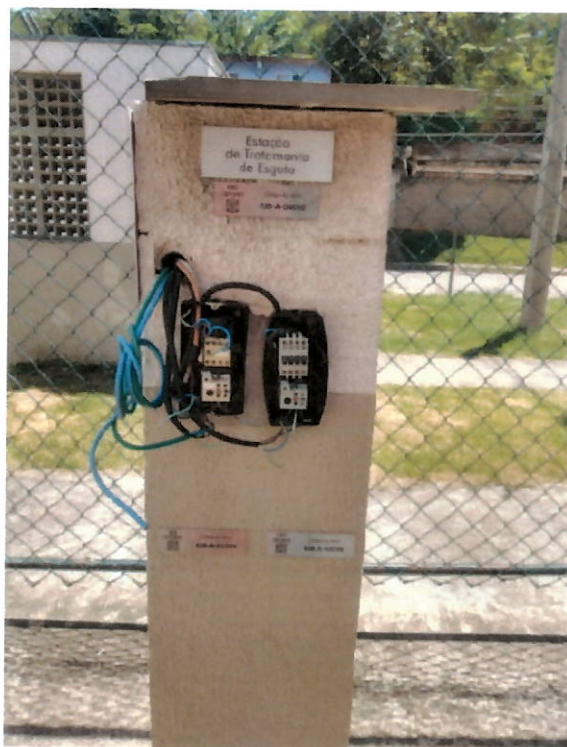
Foto 12 – Painel elétrico da ETE
