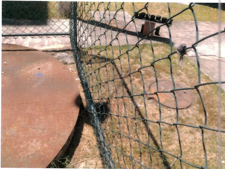
Foto 5 – Caixa retentora de resíduos sólidos (tratamento preliminar) e caixa de passagem
