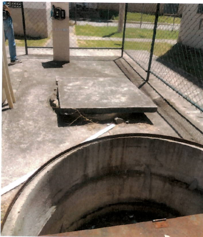
Foto 6 – Estação elevatória de esgoto e caixa retentora de resíduos sólidos (tratamento preliminar)
