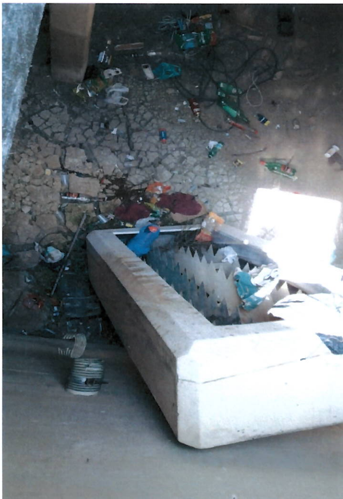
Foto 5 – Foto interna da ETE mostrando vertedor flutuante
