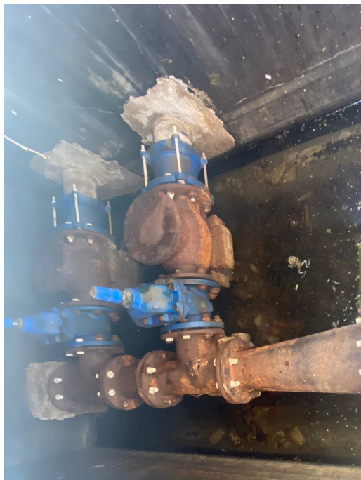
Caixa de Válvulas;
