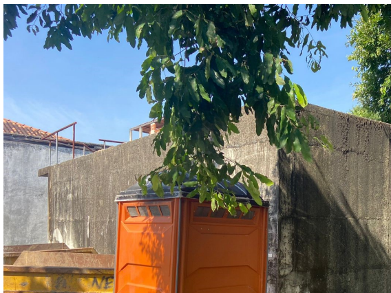
ETE desativada obra inacabada;
