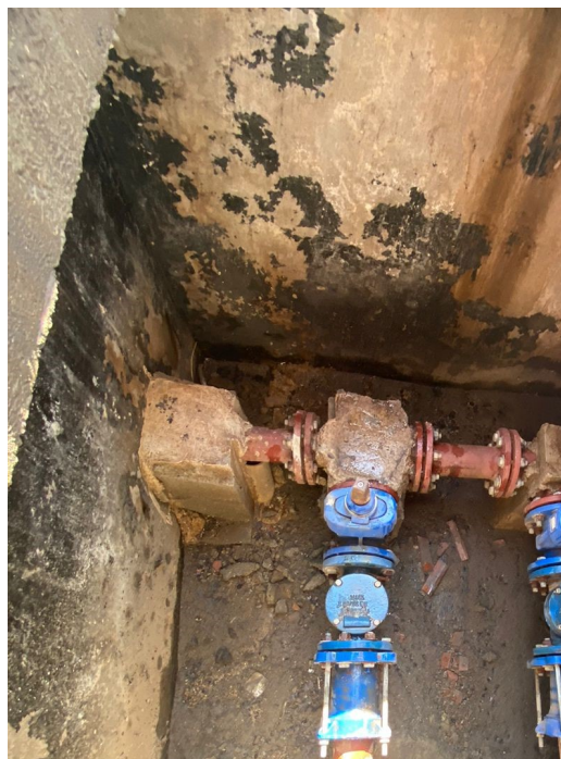
Caixa de válvulas, precisando de reforma;
