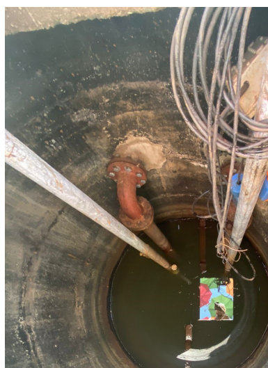
Poço das duas bombas fora de operação.
