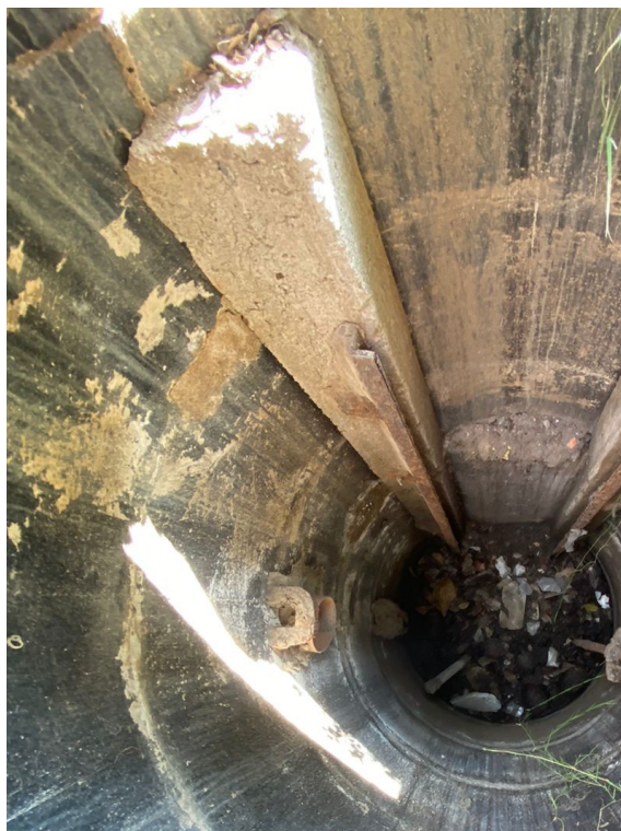
PV de entrada com grade de ferro fundido sem manutenção;
