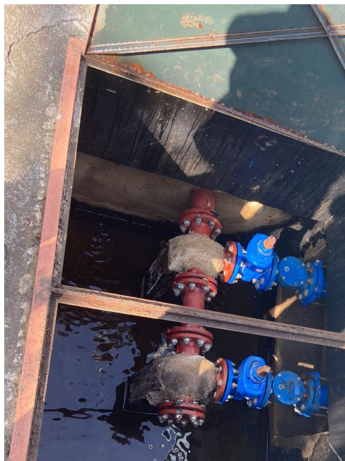
Caixa de válvulas;
