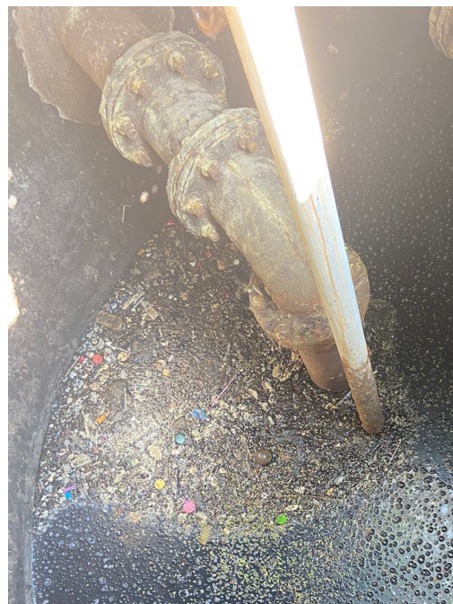
Poço das duas bombas fora de operação;
