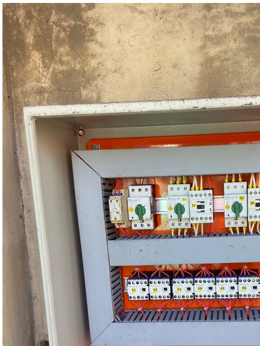
Painel elétrico desativado.;
