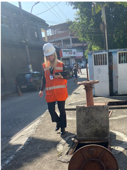
EEE A1 – desativada precisando de reforma
