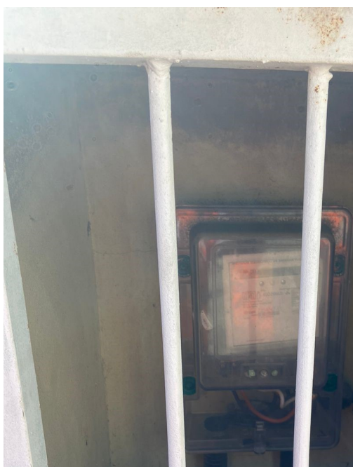
Cabine com painel elétrico desativado;
