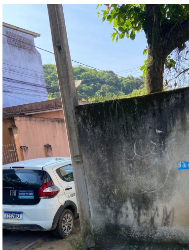
EEE desativada precisando de reforma;
