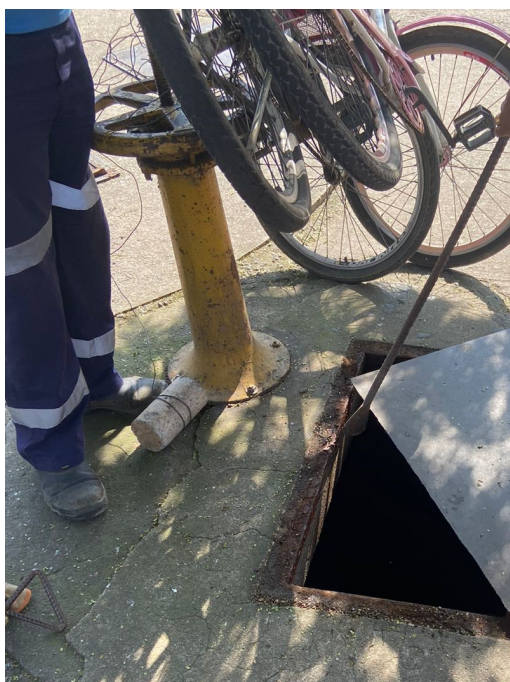
Bicicletas presas por corrente ao volante de uma das válvulas da EEE;
