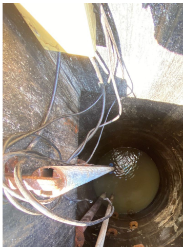
Poço das duas bombas desativados;
