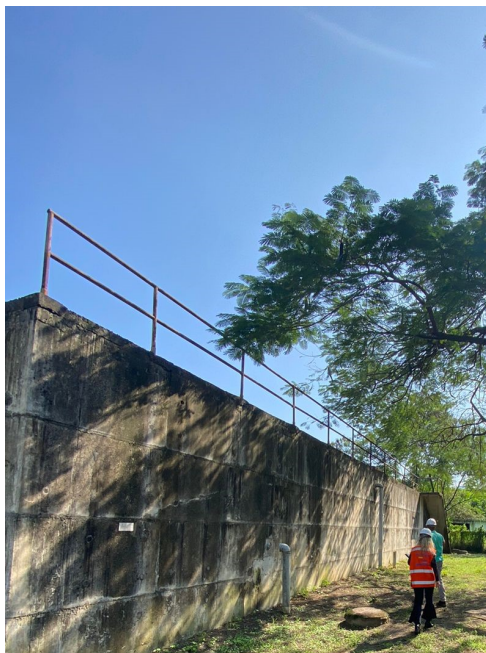
Lateral da ETE desativada, obra inacabada;
