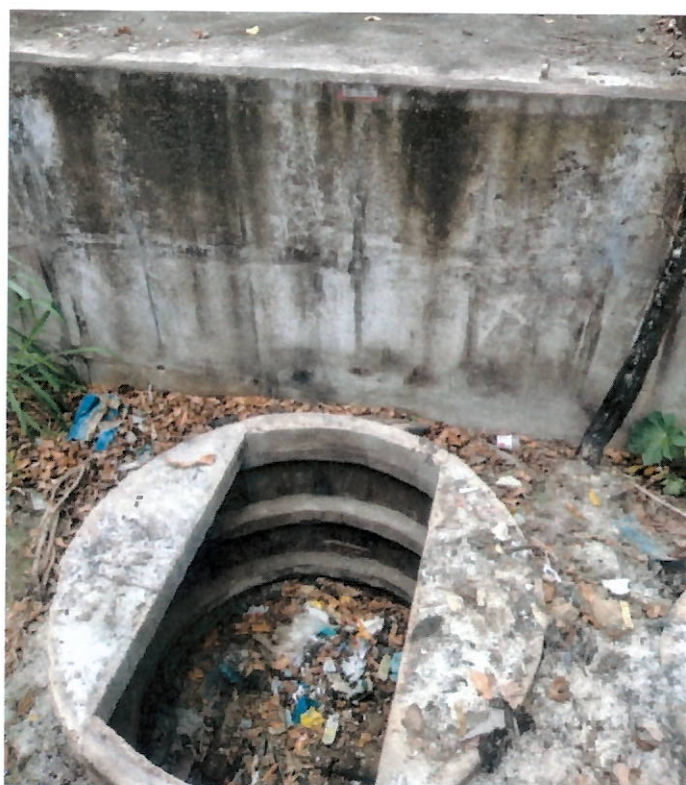
Foto 6 – Poço de visita
