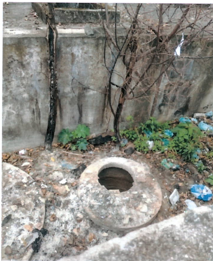
Foto 9 – Poço de visita
