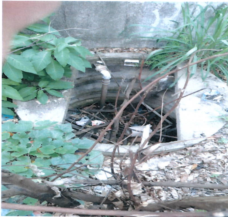
Foto 7 – Poço de bombeamento
