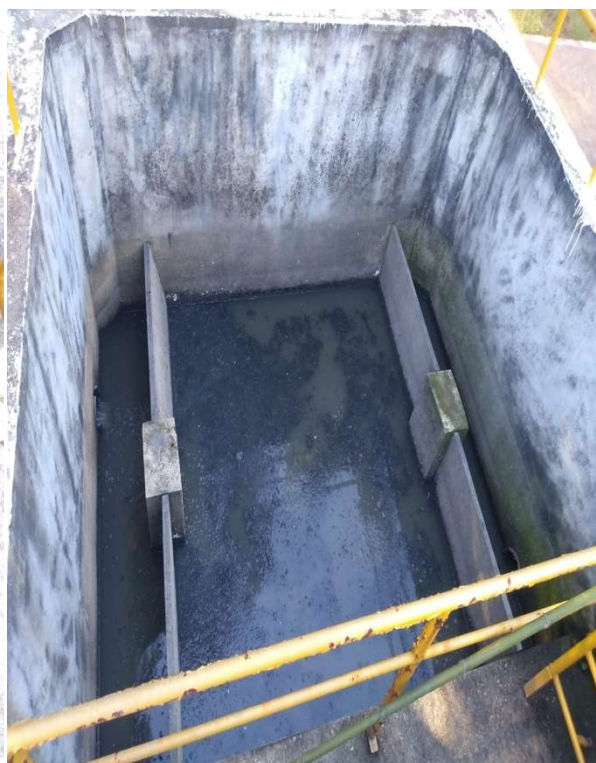
Caixa de gordura
