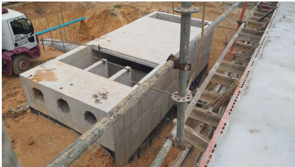
FOTO 42 – Reservatório de água de lavagem para os filtros novos
