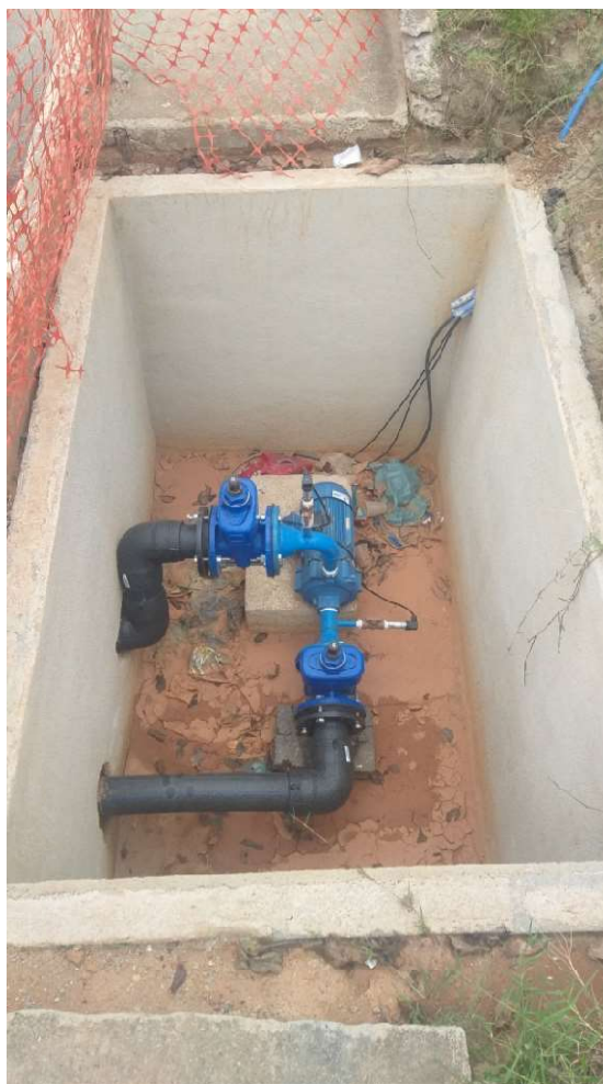
FOTO 4 - Bomba booster instalada
