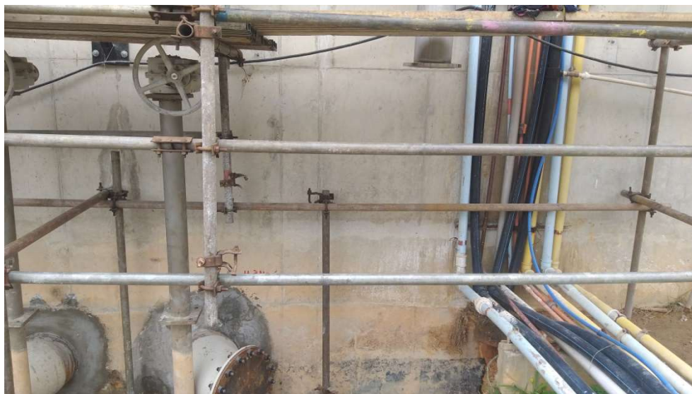
FOTO 24 – Conexões aguardando interligação com novo sistema de lavagem dos filtros existentes
