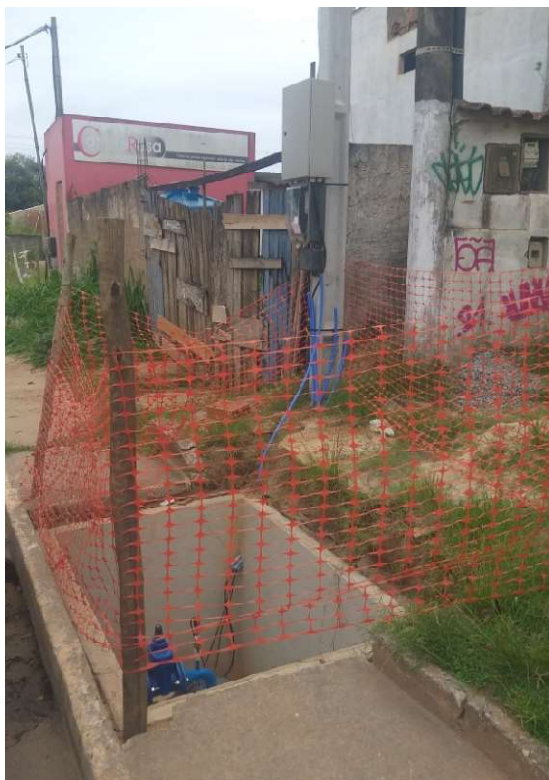
FOTO 2 - Instalação padrão de bomba booster (Arpoador)
