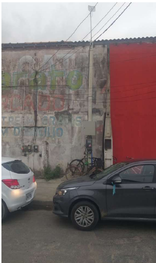
FOTO 9 – Quadro de energia, quadro de comando e antena para transmissão do sinal para o CCO
