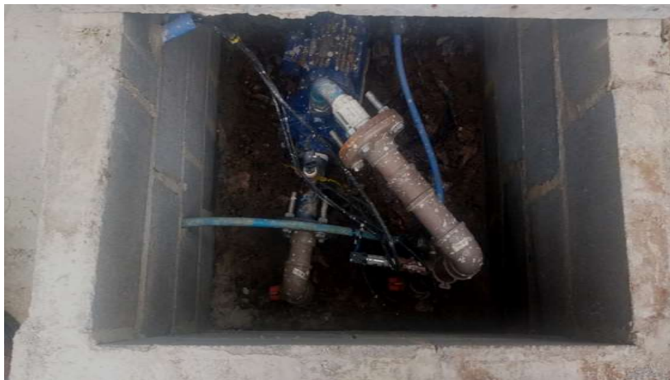
FOTO 15 - Vista de topo do Booster Casa Branca
