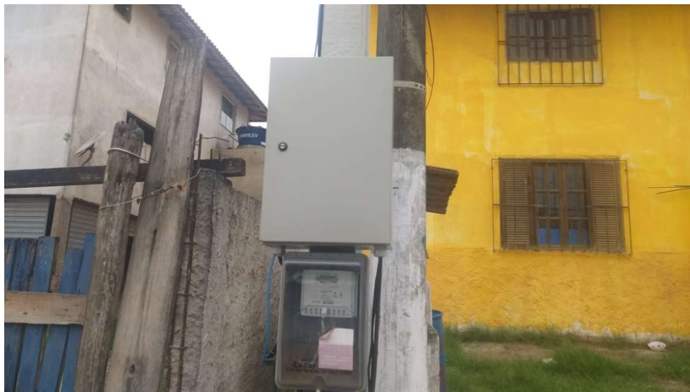
FOTO 3 - Alimentação e controle
