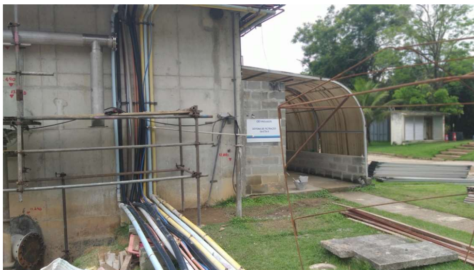
FOTO 27 – Identificação do Sistema de Filtração da ETA e acesso ao interior da ETA
