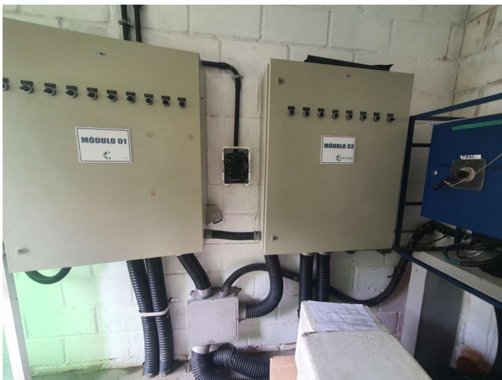
Painéis elétricos na sala destinada para depósito de EPI's.
