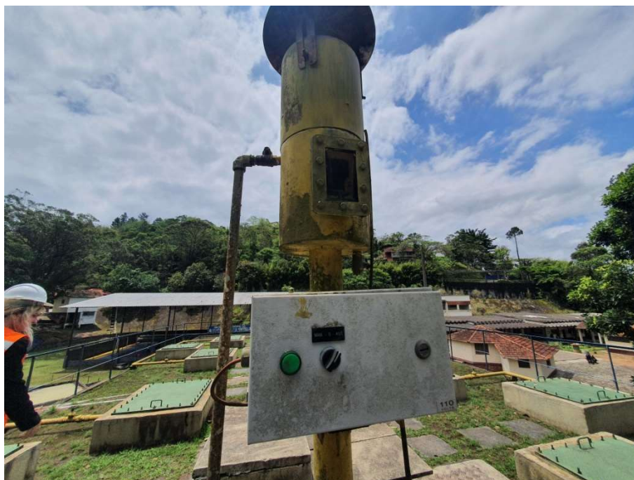
Sistema de queima de gás com acionamento automático
