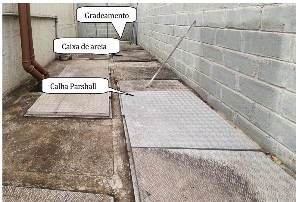
Tratamento Preliminar, composto por Gradeamento e Desarenador, coberto por tampas metálicas e de concreto.
