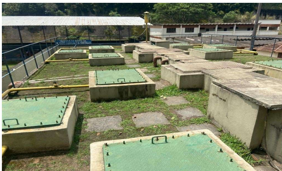
Parte superior do reator UASB com caixas de distribuição de esgoto lacradas
