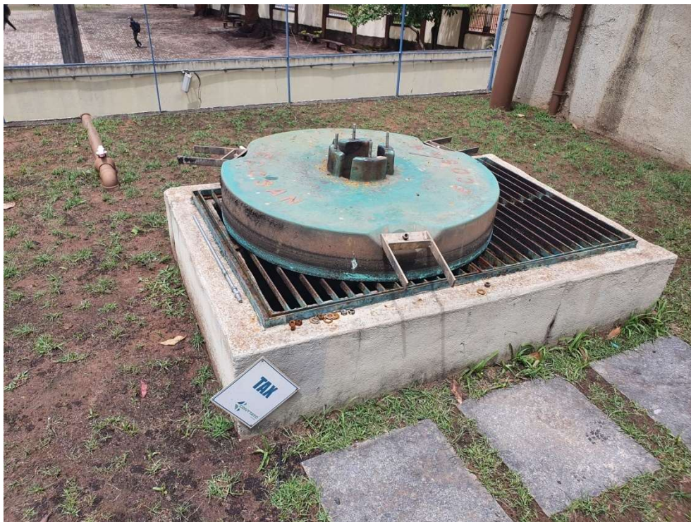
Parte superior do processo de aeração do Sistema UASB com pontos de corrosão
