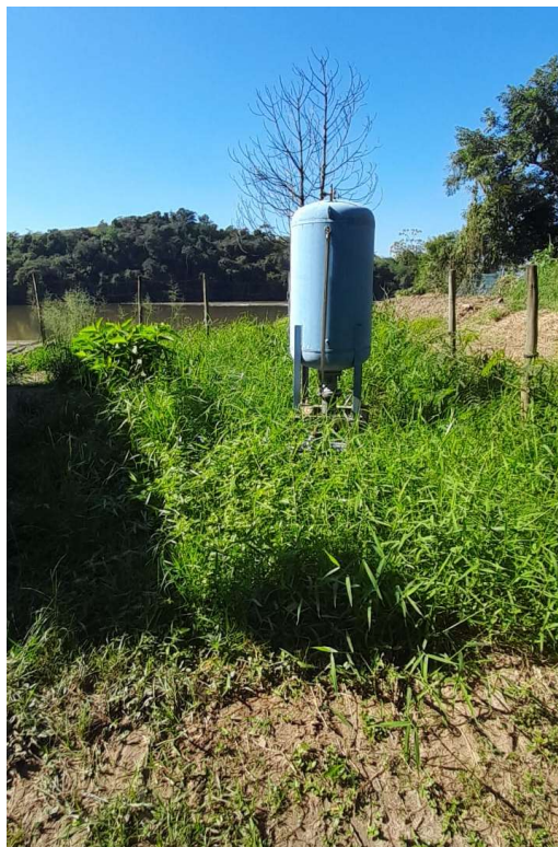
Tanque de Vaso Pressão Desativado
