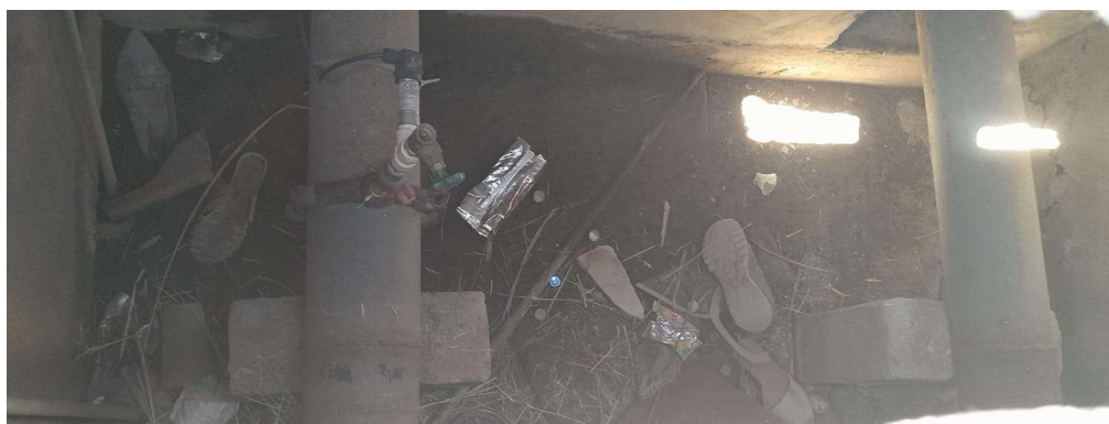
Dutos de Retaguarda
