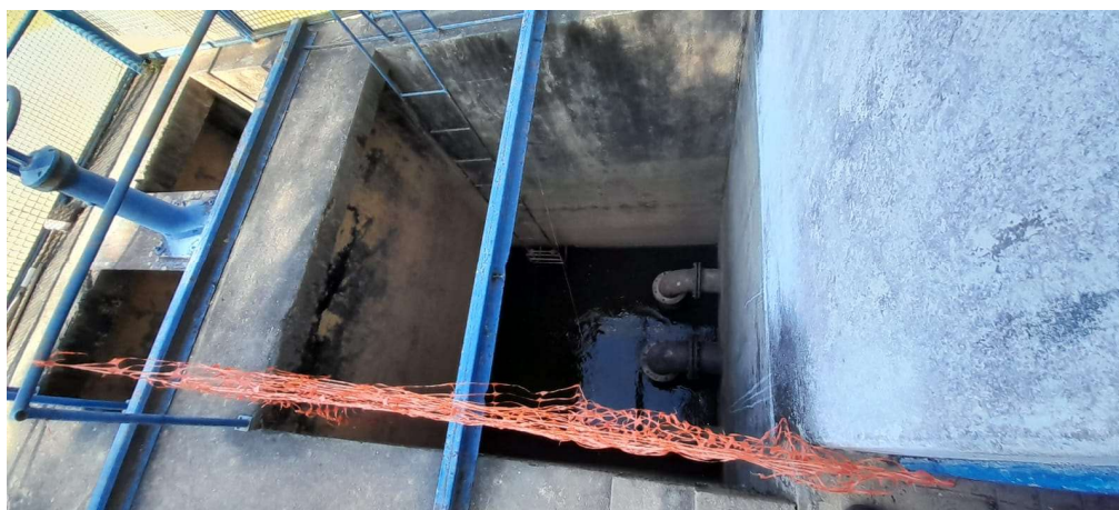
Crivo de bomba nº2; nº4; nº1
