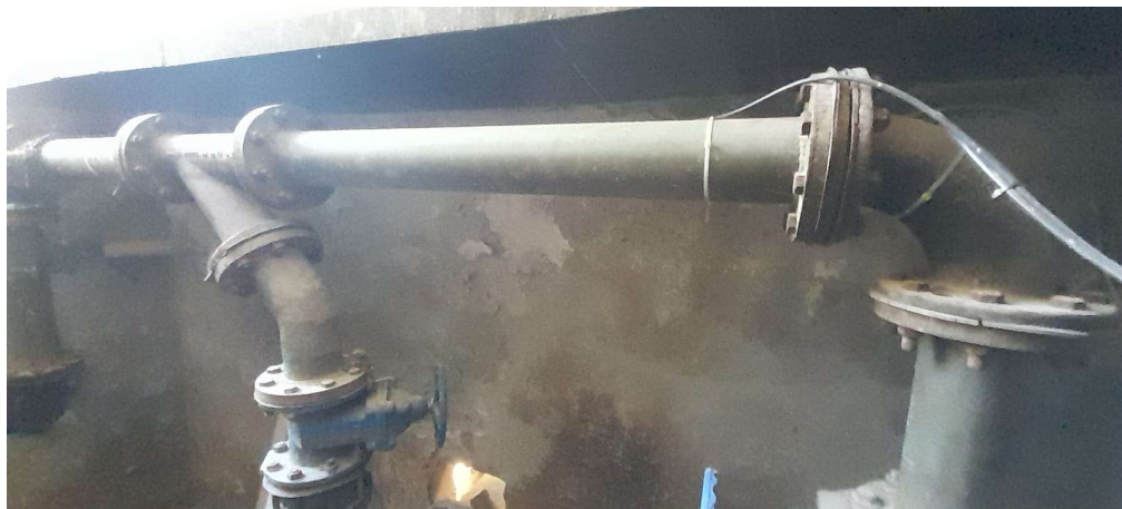
Dutos de Recalque
