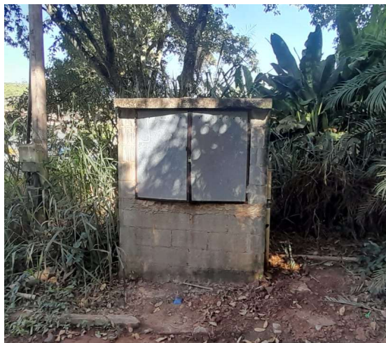
Booster Vale do Sol
