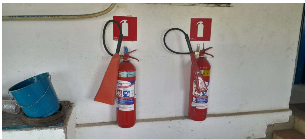
Extintores de Incêndio
