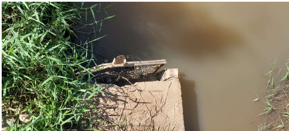
Gradeamento de entrada da Captação
