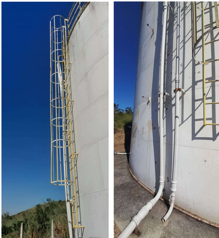
Escada do tipo Marinheiro, tubos recalque, haste para-raios
