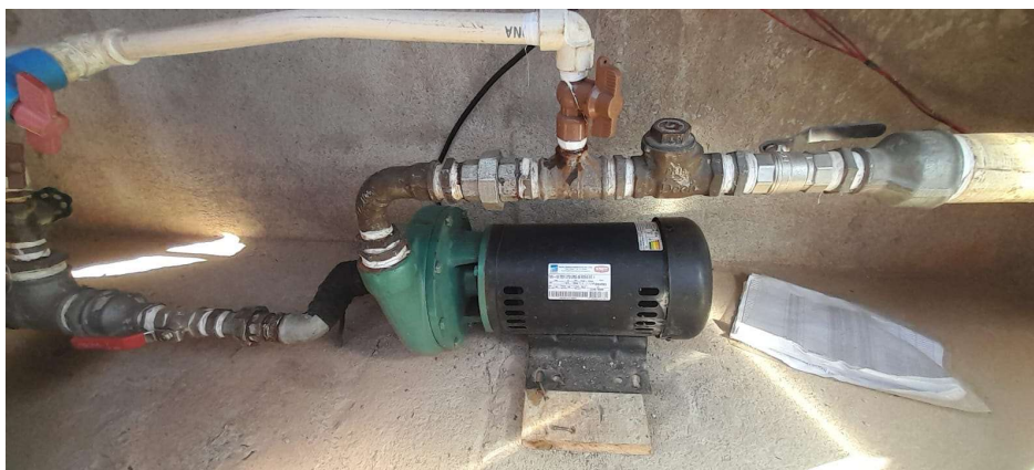
Conjunto Motobomba 4cv
