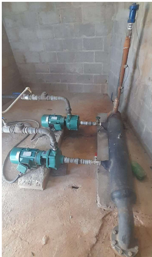
Reservatório de compensação de Sucção
