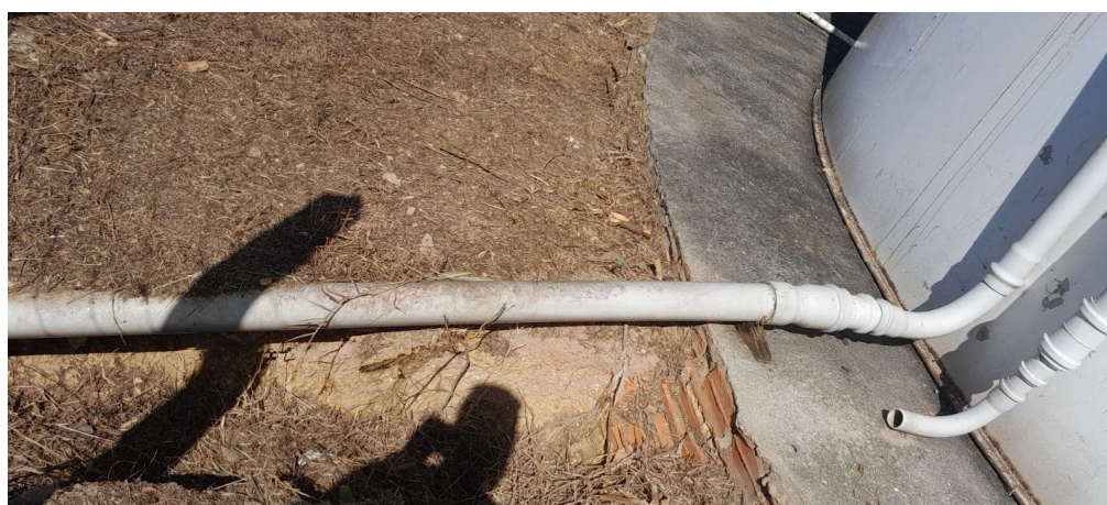
Tubos de recalque / Extravasor
