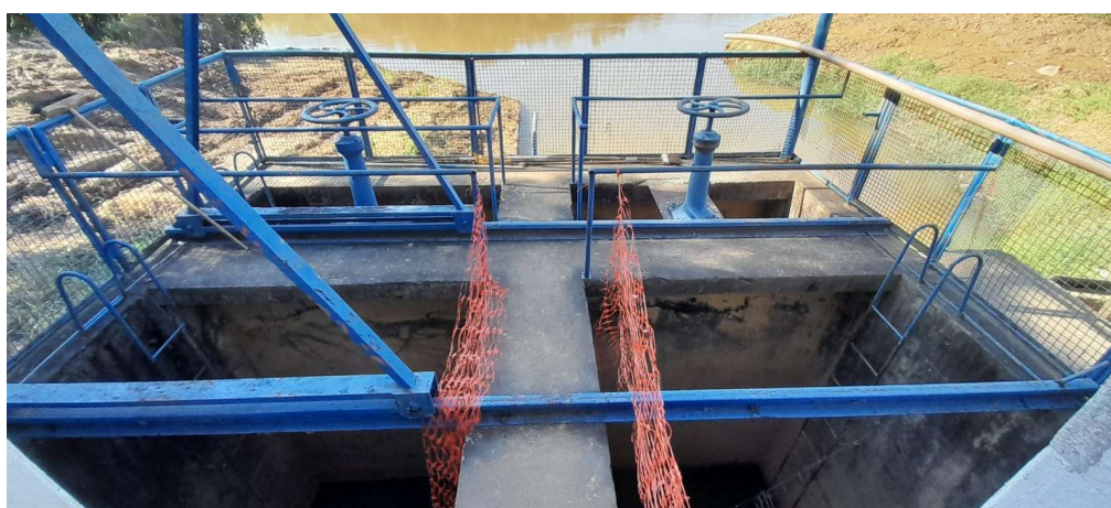
Válvulas da Câmara de Sedimentação
