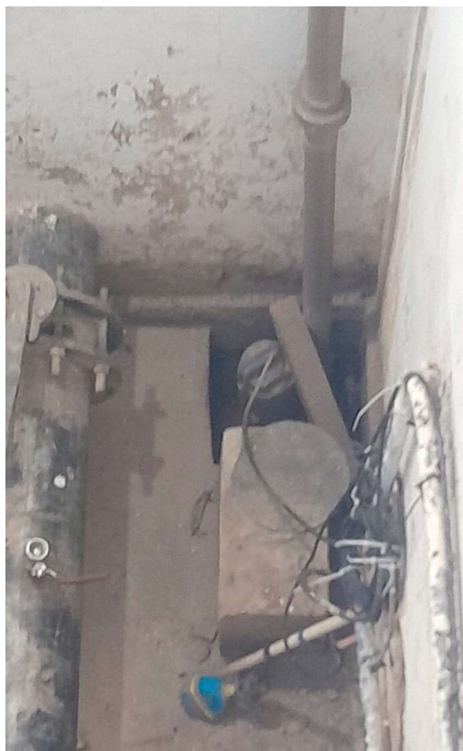
Bomba de Dreno
