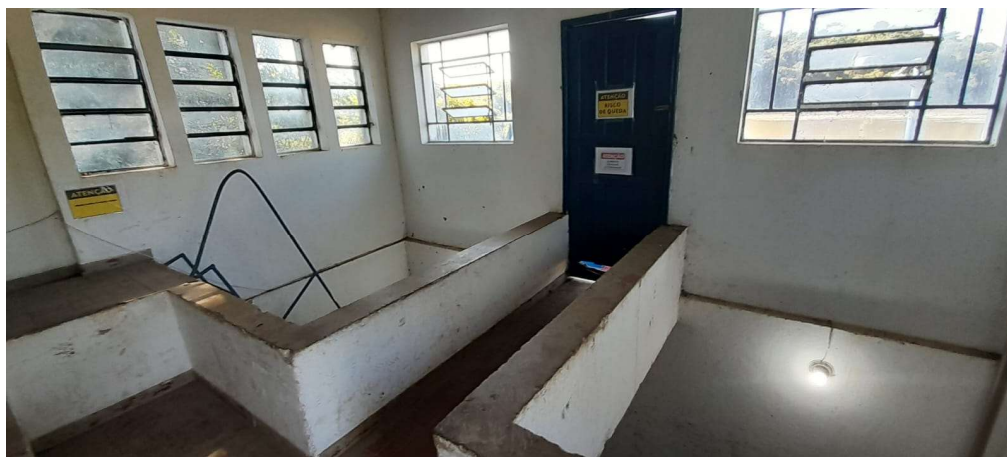
Acesso a Câmara de Sedimentação /Pé de Válvula com Crivo
