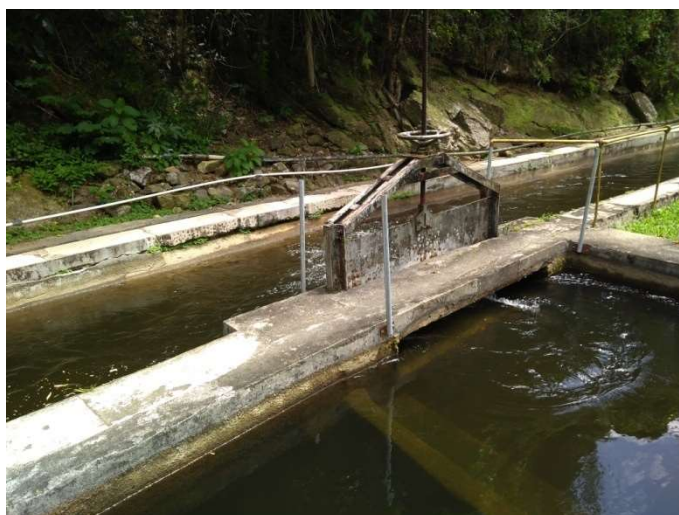
Foto 18 – Comporta da Saída dos Decantadores
