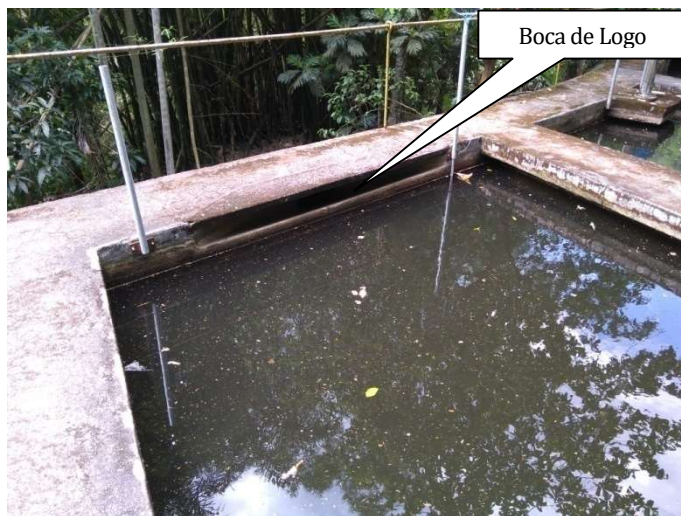
Foto 17 – Extravasor (Boca de Lobo) dos 12 Decantadores
