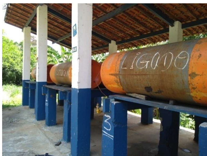
Foto 04 – Cilindros de Cloro Gás
