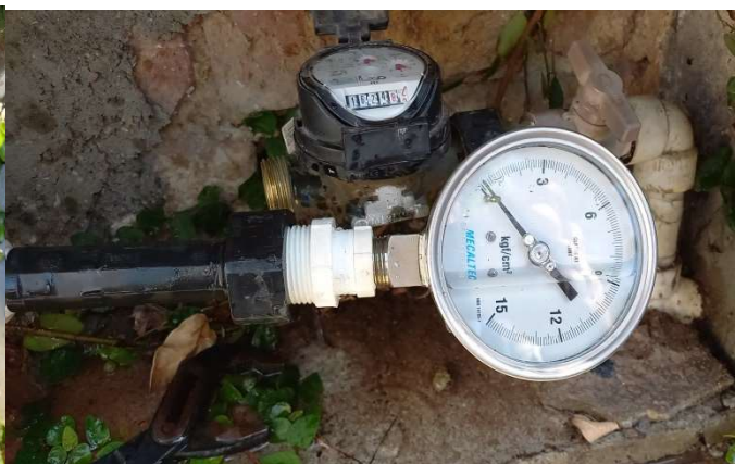
Pressão manométrica aferida – Rocha/RJ
