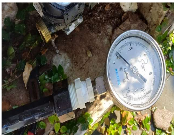
Pressão manométrica aferida – Rocha/RJ
