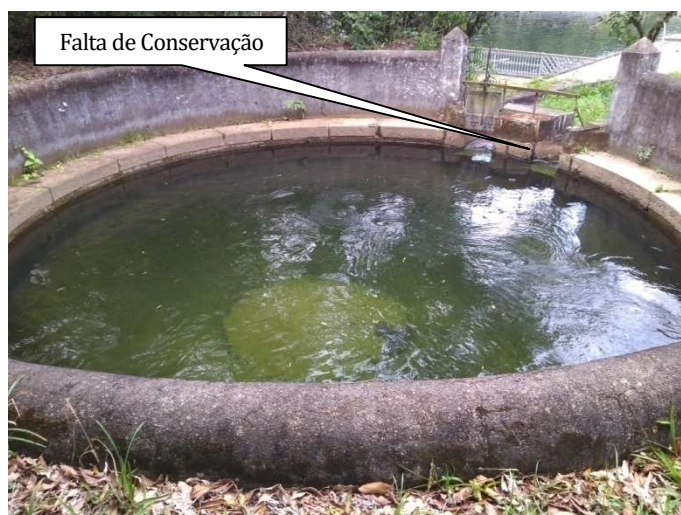
Foto 16 – Caixa de Areia antes dos Tanques
