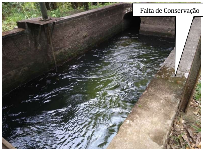
Foto 15 – Caixa de Areia antes dos Tanques
