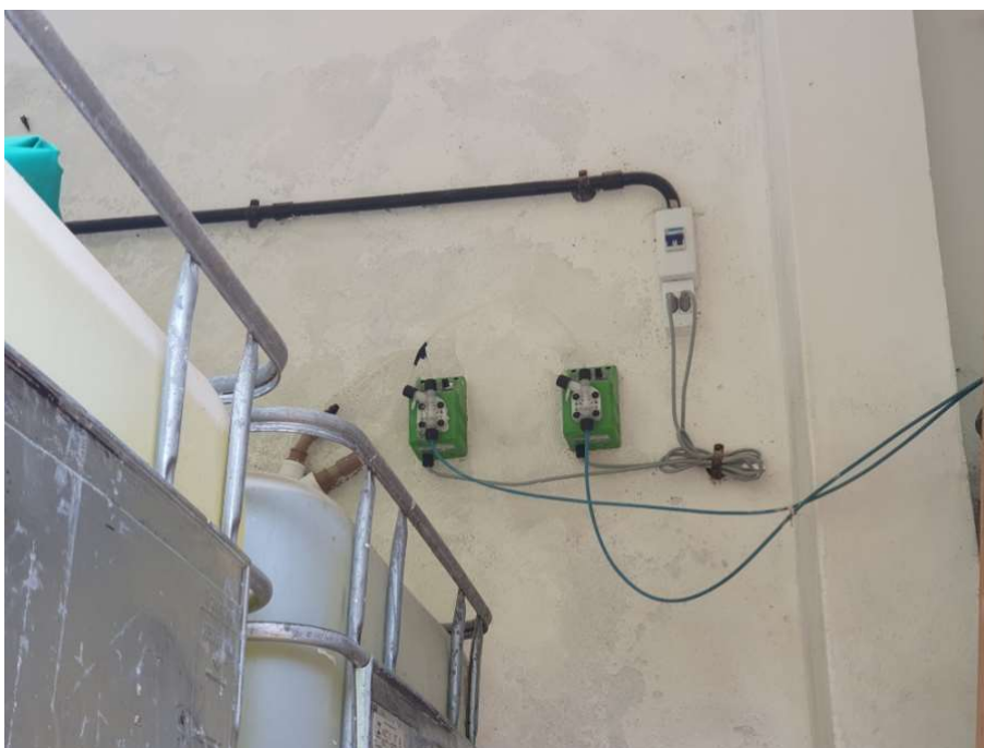
Dosador automático de cloro
