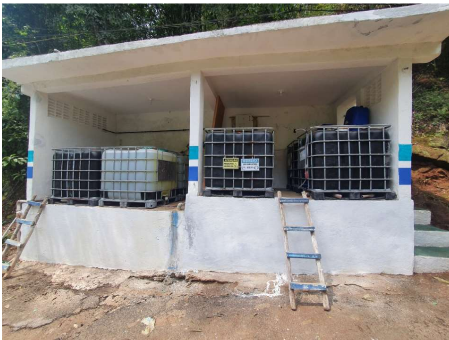
Armazenamento de Produtos Químicos
