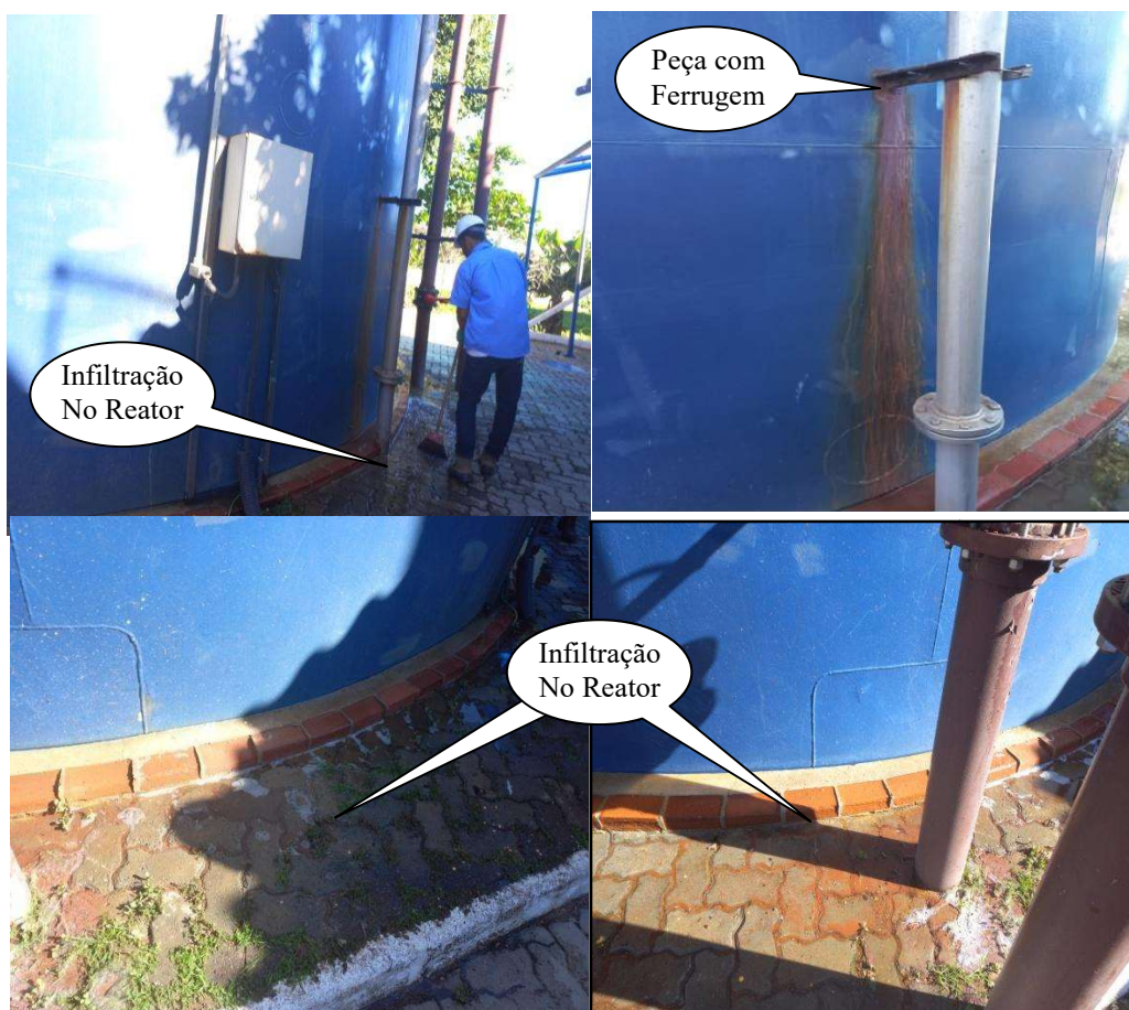
Figura 8 – Tratamento secundário no tanque RANOX: vazamento na base do tanque (visível processo de corrosão).
