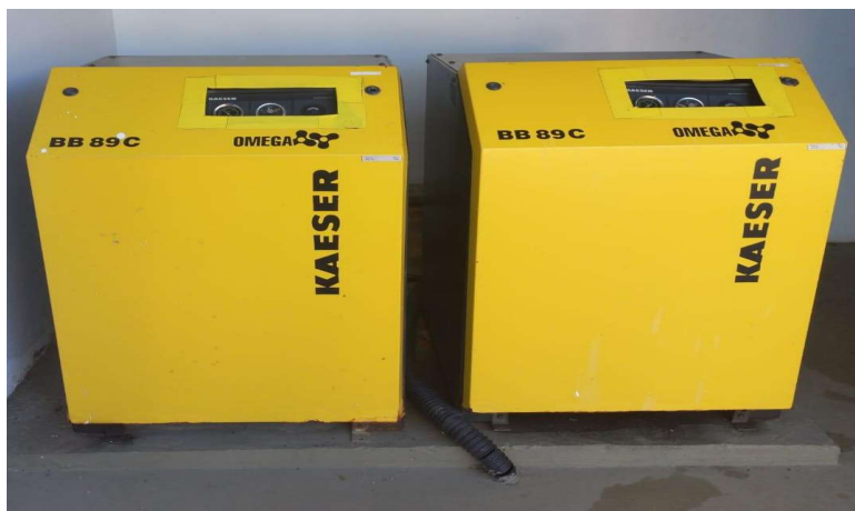
Figura 13 – Instalações de apoio: sopradores enclausurados com abafador de ruído para aeração do RANOX
