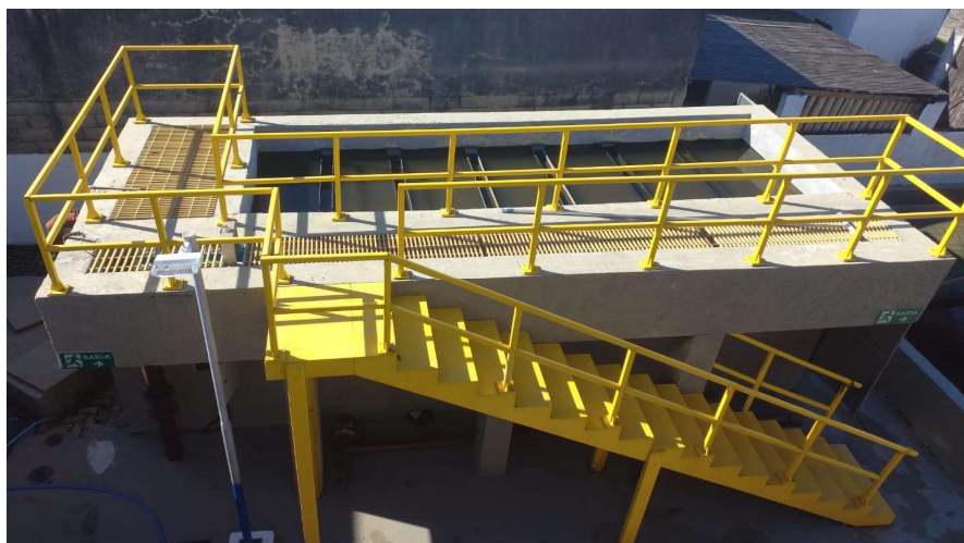
Figura 11 – Tratamento secundário e terciário: decantador terciário tipo lamelar com fluxo ascendente e com aplicação do PAC para remoção de fósforo (nutriente).
