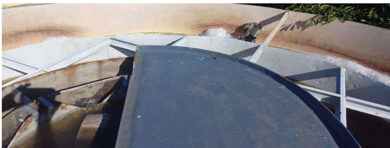
Figura 6 – Tratamento primário e secundário no Tanque RANOX: caixa de distribuição com a entrada do recalque de esgoto pré-tratado pelo eixo central, que é distribuído em oito saídas com vertedores triangulares V90° seguidos de grades metálicas (tipo cesto) com abertura de malha fina.
