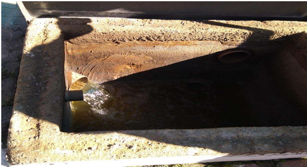
Figura 3 – Caixa de chegada dos afluentes da ETE Saquarema.
