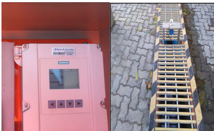
Figura 12 – Saída do efluente tratado: medidor de vazão tipo calha parshall com sensor ultrassônico (vazão instantânea = 3,94 L/s) e régua inox (vazão instantânea \approx 20\text{ m}^3/\text{h} \approx 5,55\text{ L/s} , e vazão máxima histórica \approx 50\text{ m}^3/\text{h} \approx 14\text{ L/s} )
