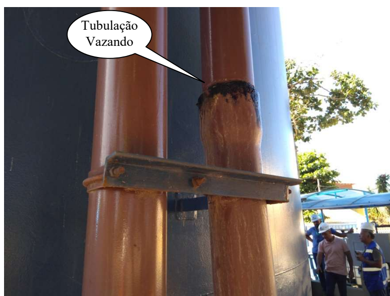
Figura 9 – Tratamento secundário no tanque RANOX: vazamento na base do tanque (visível processo de corrosão).
