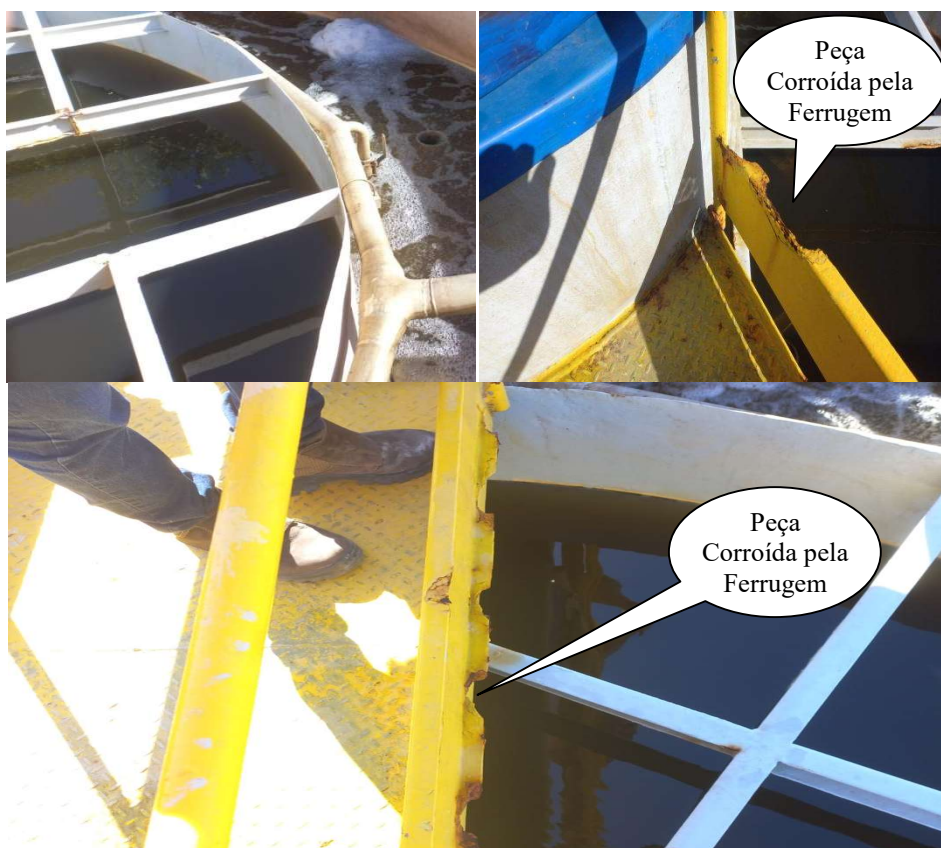
Figura 7 – Tratamento secundário no Tanque RANOX: tanque em aço pintado com corrosão em alguns pontos.
