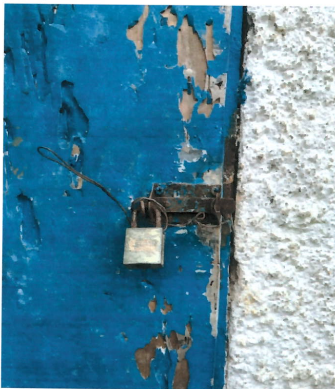
Foto 15 - Porta da entrada da casa de química com cadeado, arame e trinco (foto tirada em 14/09/2022)
