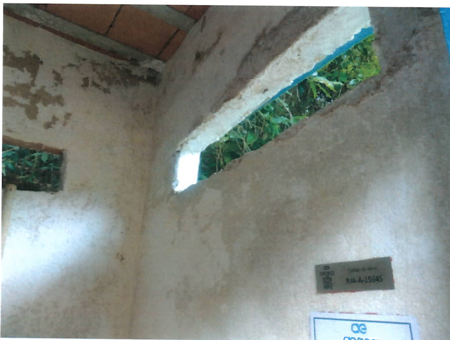
Foto 18 – Janela de ventilação, sem proteção, situada na casa de química
