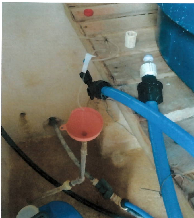
Foto 10 – Cloro injetado diretamente na tubulação tronco através de uma tubulação de 1/2"
