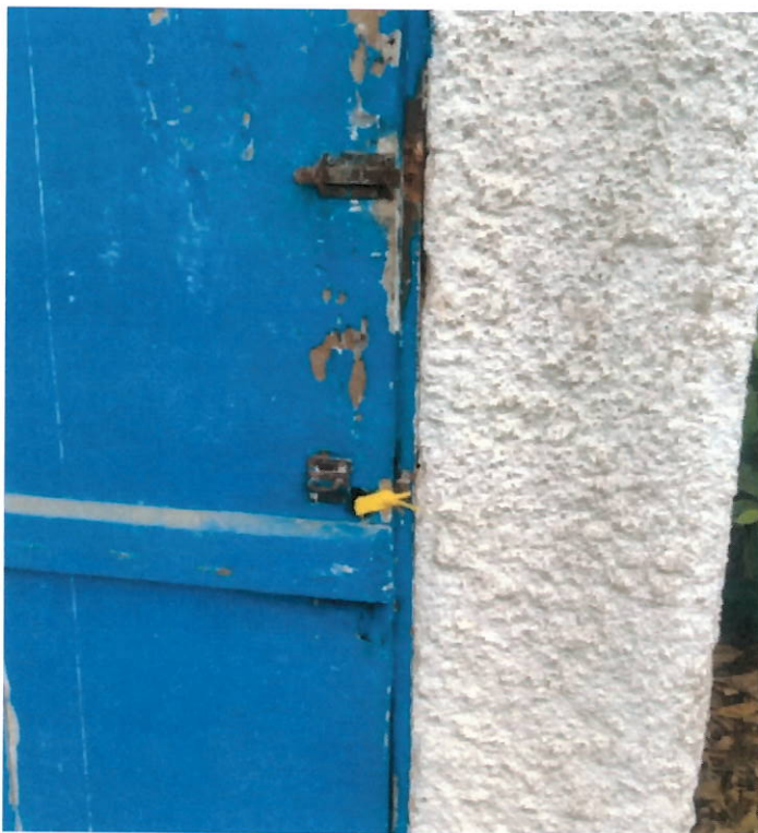
Foto 16 - Porta da entrada da casa de química sem o cadeado, arame e parte do trinco (foto tirada em 21/09/2022)
