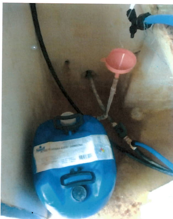
Foto 13 - Dosador de cloro
