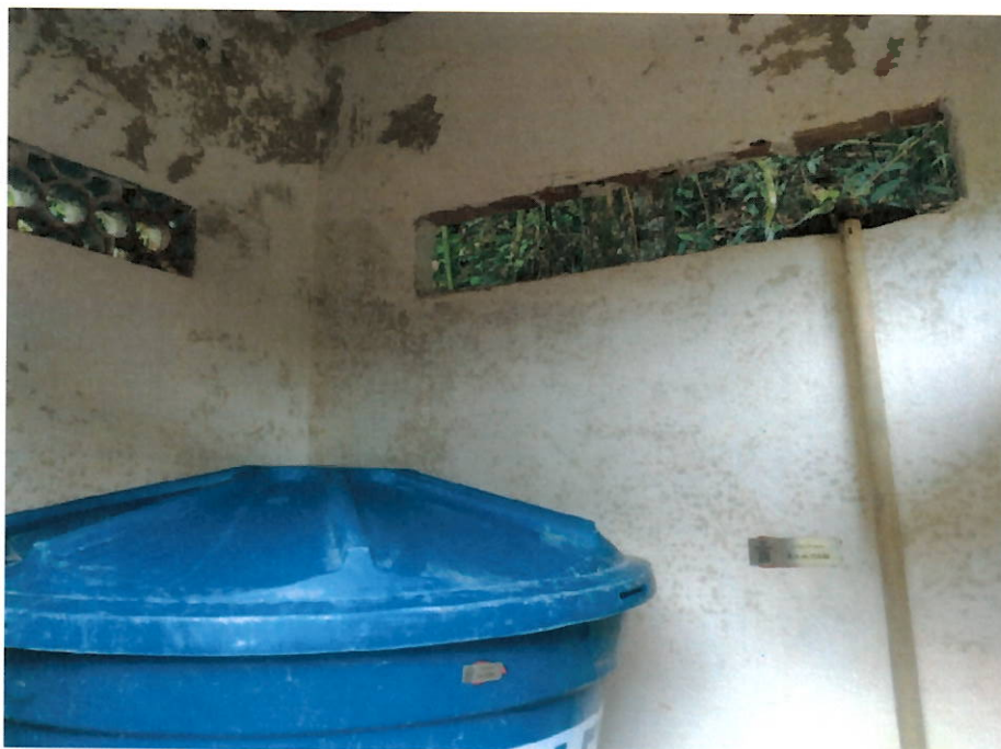
Foto 17 – Janela de ventilação, sem proteção, situada na casa de química
