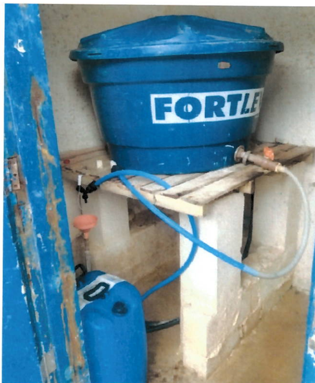
Foto 06 – Reservatório onde é colocado o cloro e tubulação que leva o cloro até o dosador
