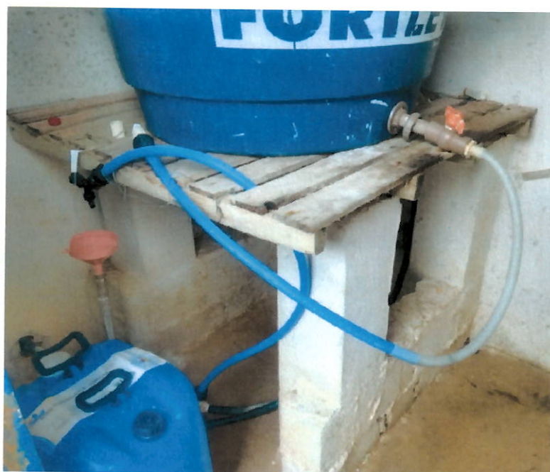
Foto 07 – Reservatório onde é colocado o cloro e tubulação que leva o cloro até o dosador
