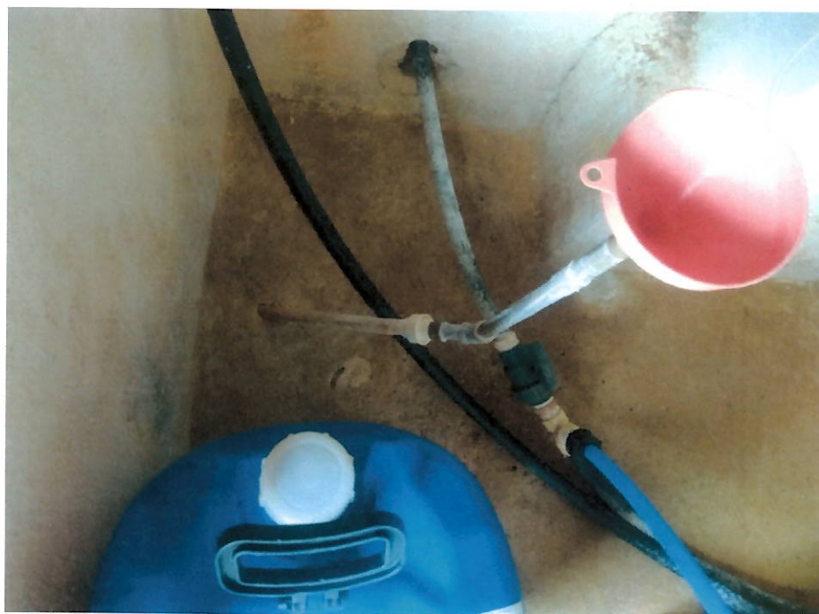
Foto 11 – Cloro injetado diretamente na tubulação tronco através de uma tubulação de 1/2"
