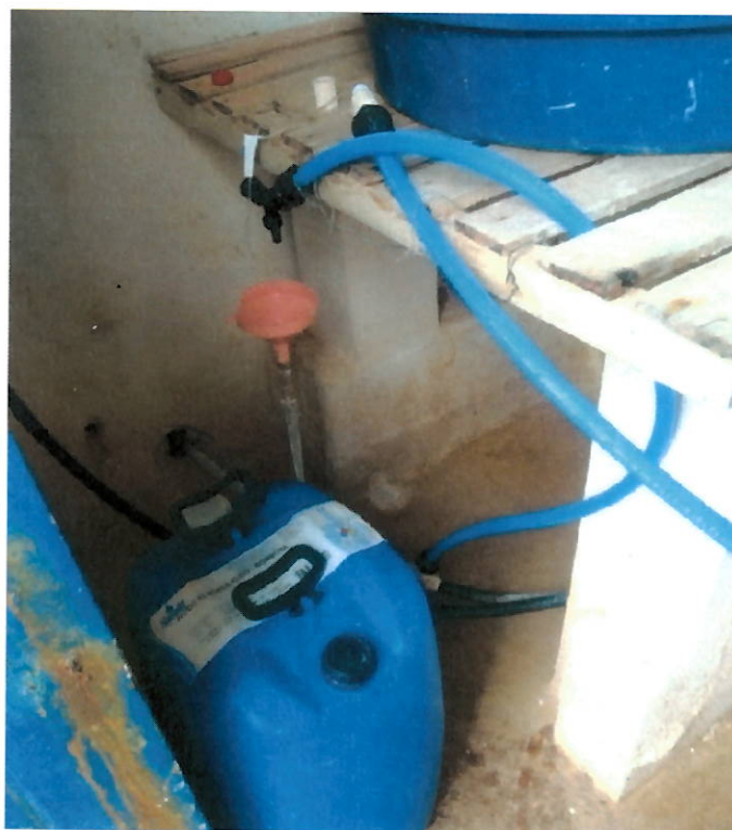
Foto 12 – Dosador de cloro
