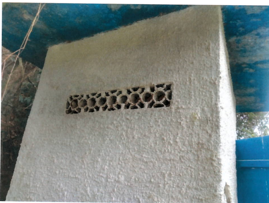
Foto 19 – Janela de ventilação, com proteção, situada na casa de química
