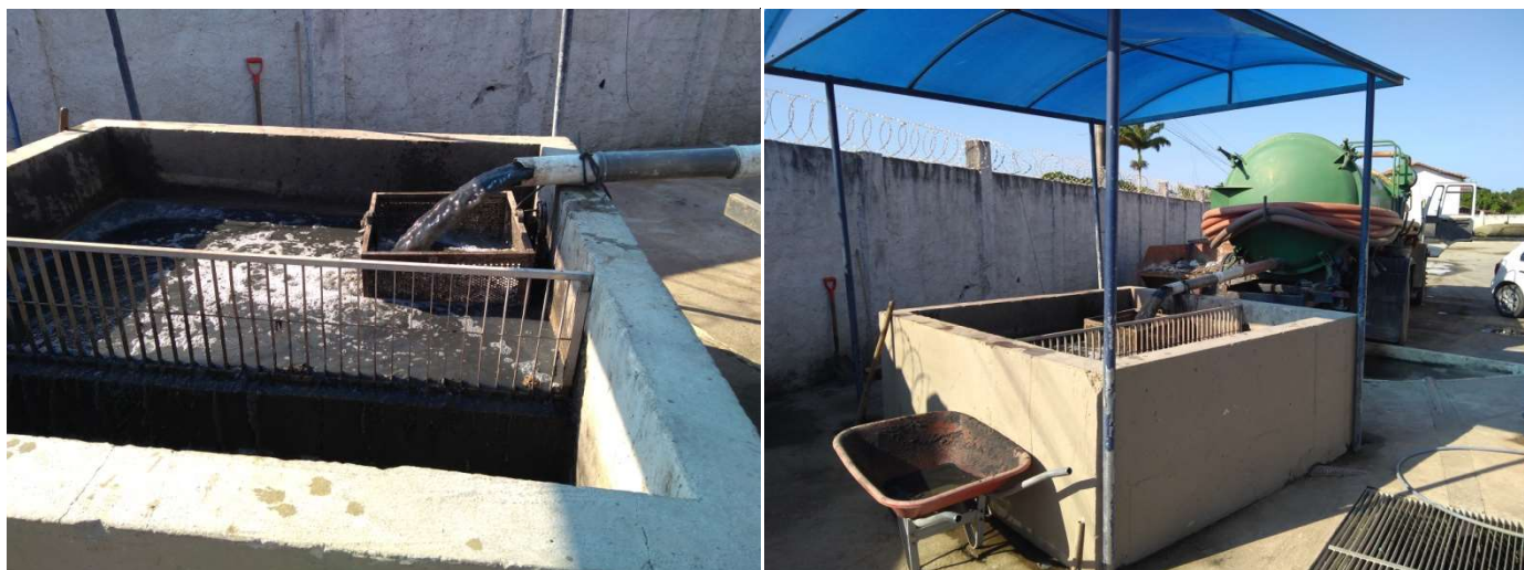
Foto 24 – Tanque de Despejo de Caminhão Vacoll
