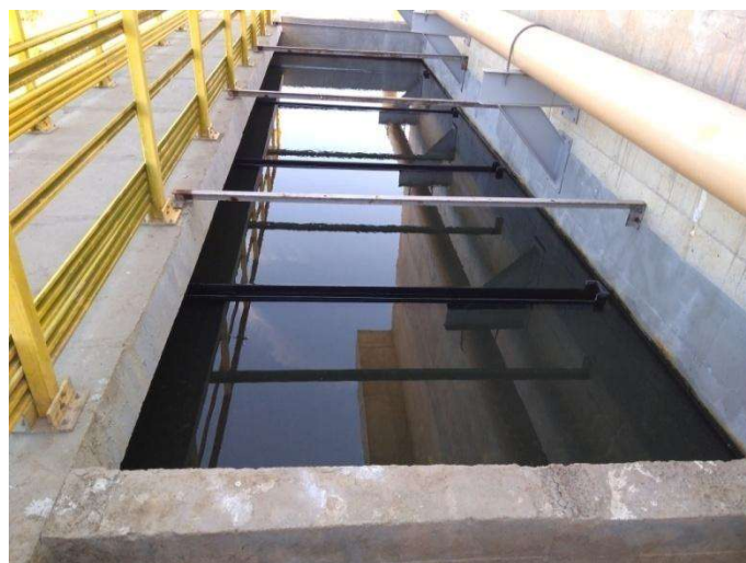
Foto 21 – Tanque de Decantação Secundário
