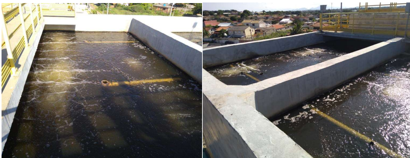
Foto 12 – Tanque de Aeração
