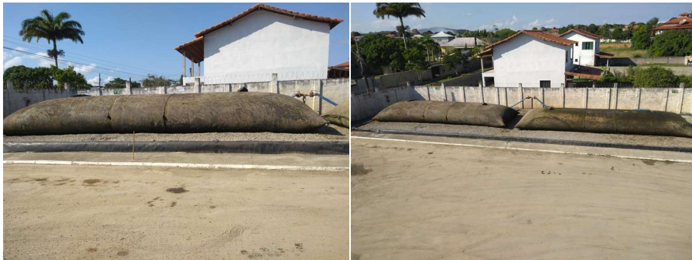
Foto 19 – Bags Armazenamento de Lodo
