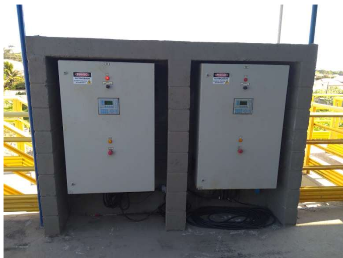
Foto 05 – Quadro de Comando dos PTRAT
