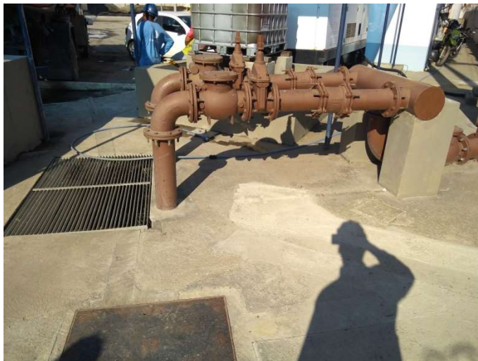
Foto 25 – Elevatória do Tanque de Efluente Despejado por Caminhão Vacoll
