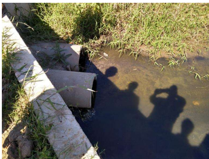
Foto 27 – Saída do Esgoto Tratado no Rio Salgado
