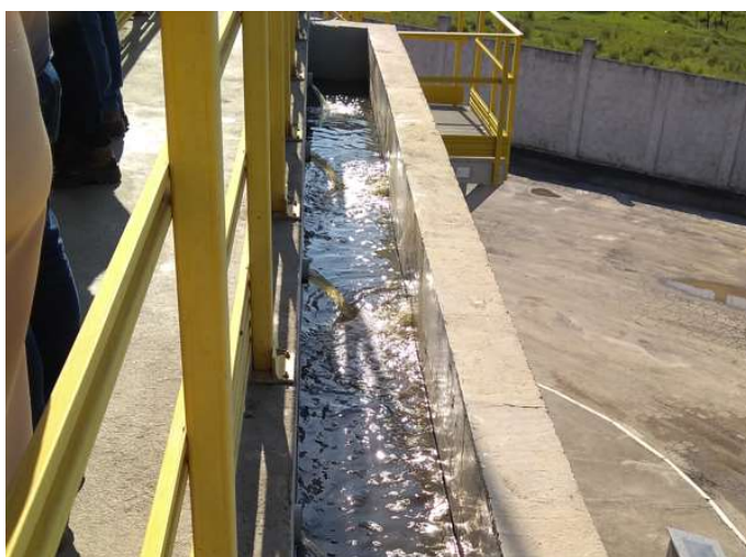
Foto 09 – Saída do Tanque de Decantação Primária
