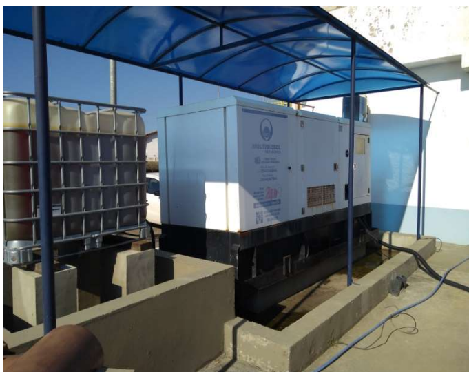
Foto 23 – Gerador e Reservatório de Diesel
