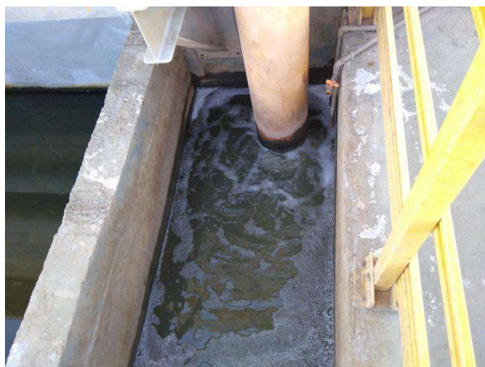
Foto 20 – Chegada do Esgoto Tratado no Decantador Secundário
