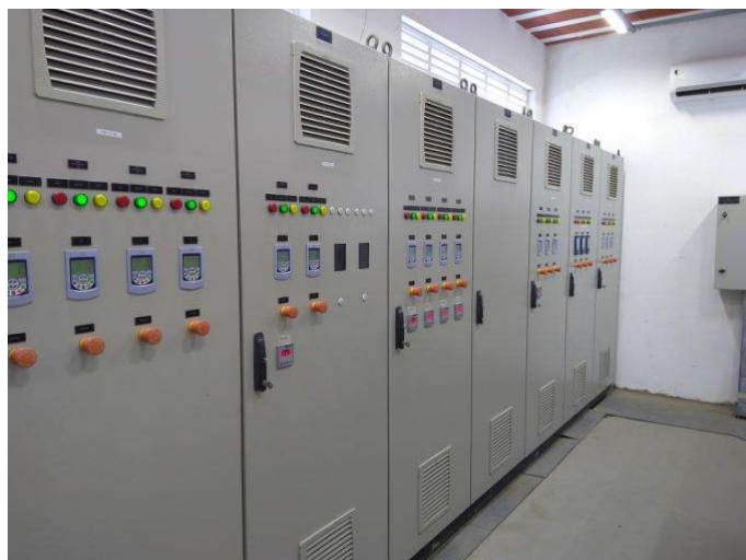
Foto 16 – Quadro de Comando de Toda Estação
