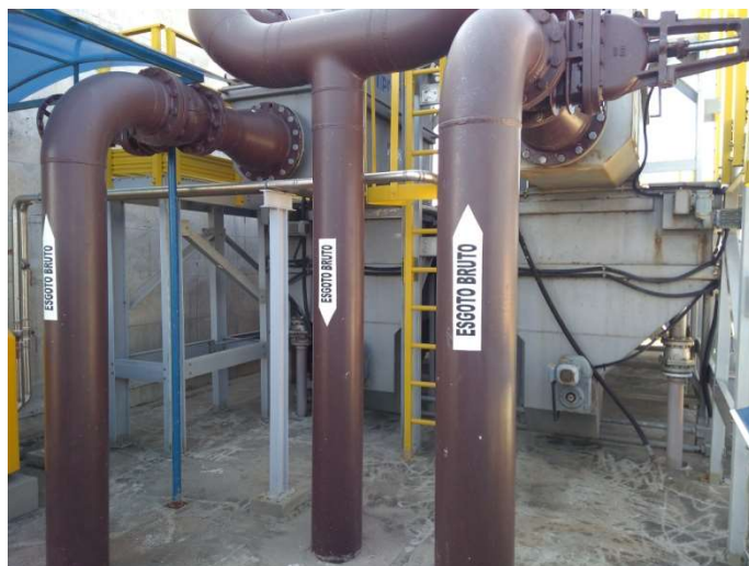
Foto 03 – Entrada do Esgoto Bruto nos PTRAT
