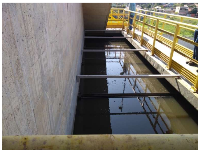
Foto 08 – Tanque de Decantação Primária
