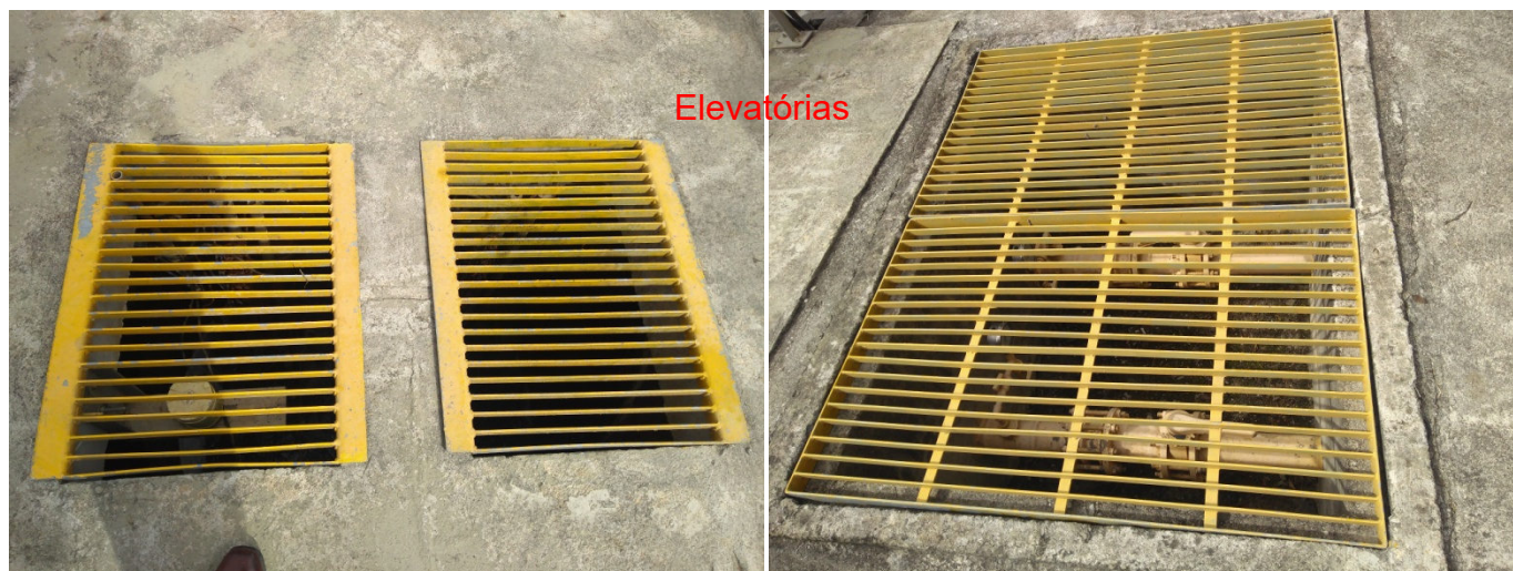
Foto 9 – Elevatória de esgoto pré-tratado com bombas submersíveis
