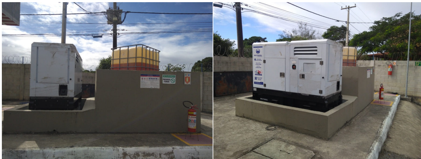
Foto 17 – Gerador, reservatório de combustível diesel e baia de contenção
