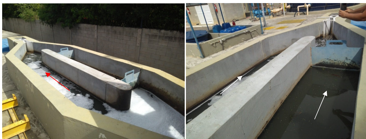
Foto 4 – Tratamento preliminar: desarenadores de limpeza manual
