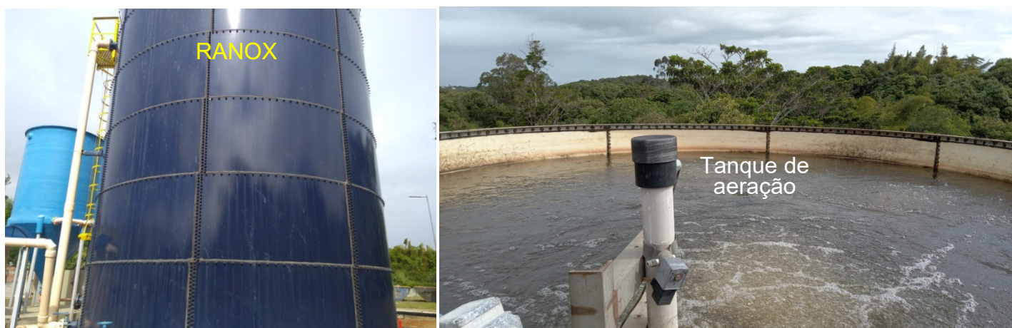
Foto 7 – Tratamento secundário: reator compacto anóxico (parte inferior) e aeróbico (parte superior) – RANOX (vistas laterais e superior)
