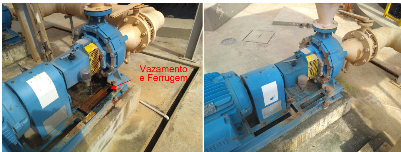
Foto10 – Bombas da elevatória de recirculação de esgotos para o reator RANOX (vazamento e ferrugem na base)
