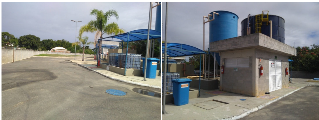
Foto 2 – Área interna da ETE Jacarepiá
