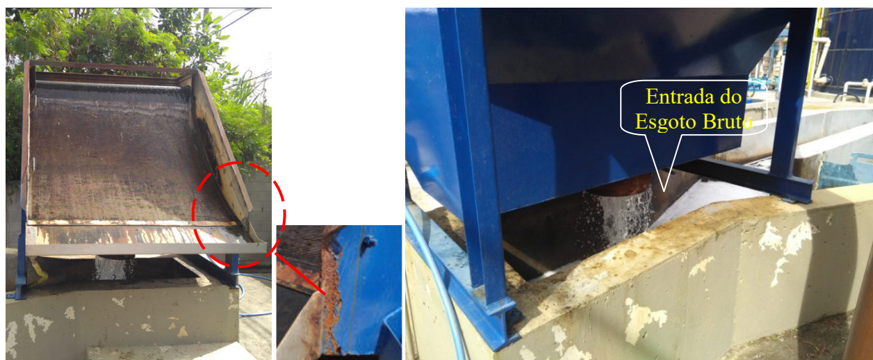
Foto 3 – Tratamento preliminar: entrada do esgoto bruto passando pelo gradeamento tipo peneira estática escalar com abertura em malha fina. (detalhe da corrosão já sinalizada no último relatório)
