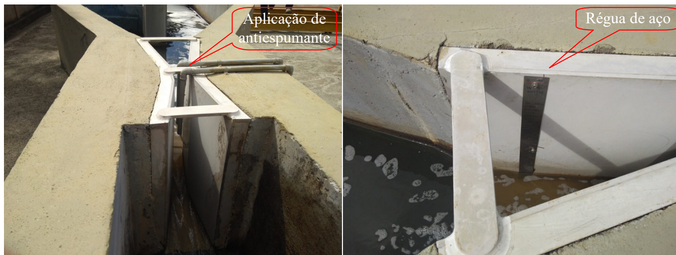
Foto 5 – Medidor de vazão da entrada tipo calha Parshall com régua em aço inox, mas sem sensor ultrassônico . Ponto de aplicação de antiespumante na garganta da calha
