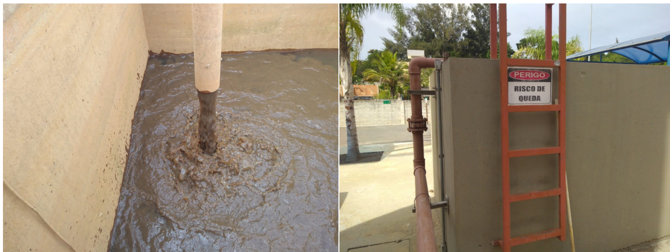
Foto 12 – Tanque de lodo (adensador), advindo do decantador
