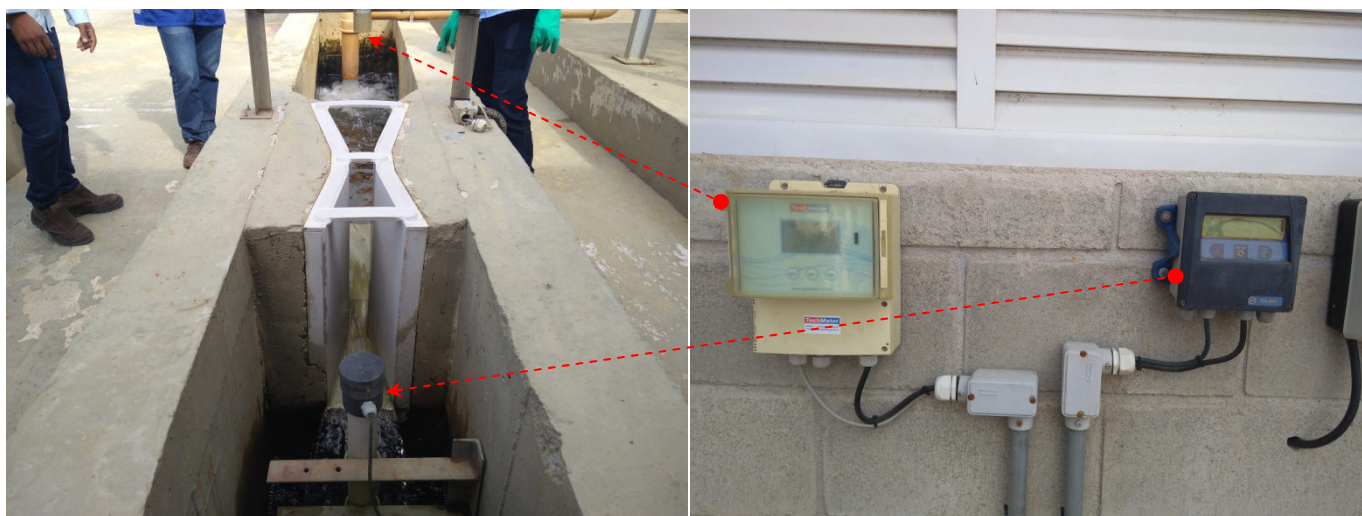
Foto 14 – Medidor de vazão de saída do efluente tratado com sensor ultrassônico e de pH (vazão instantânea = Q_{\text{inst}} = 5,395 \text{ L/s} e \text{pH} = 8,56 )
