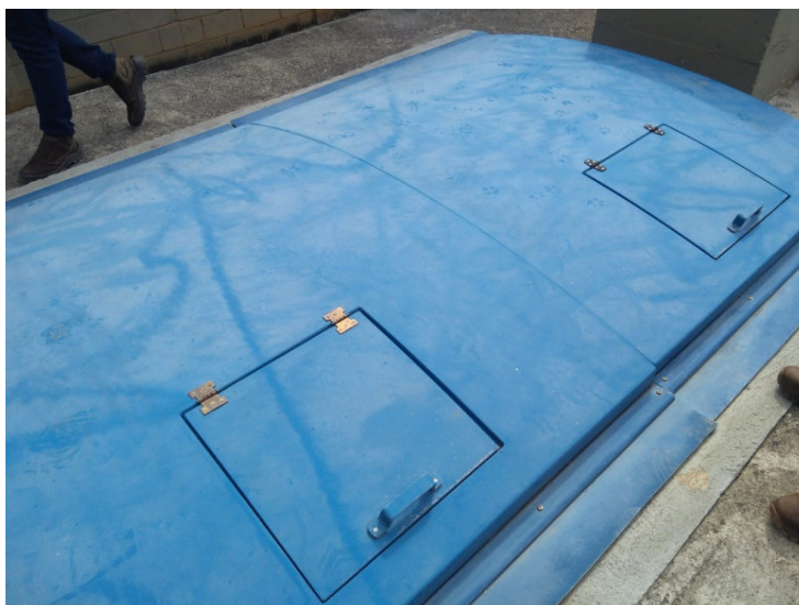
Foto 6 – Tanques com escotilha, caixa de gordura
