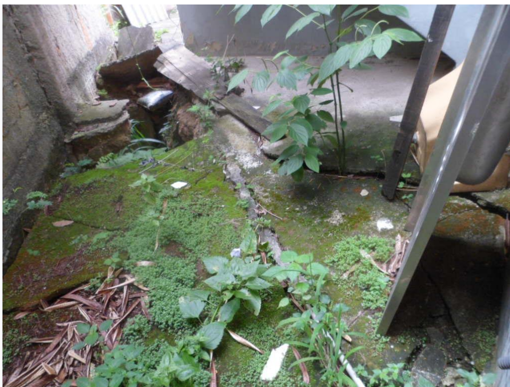
Foto 13 – Assoreamento de todo o piso nos fundos do terreno
