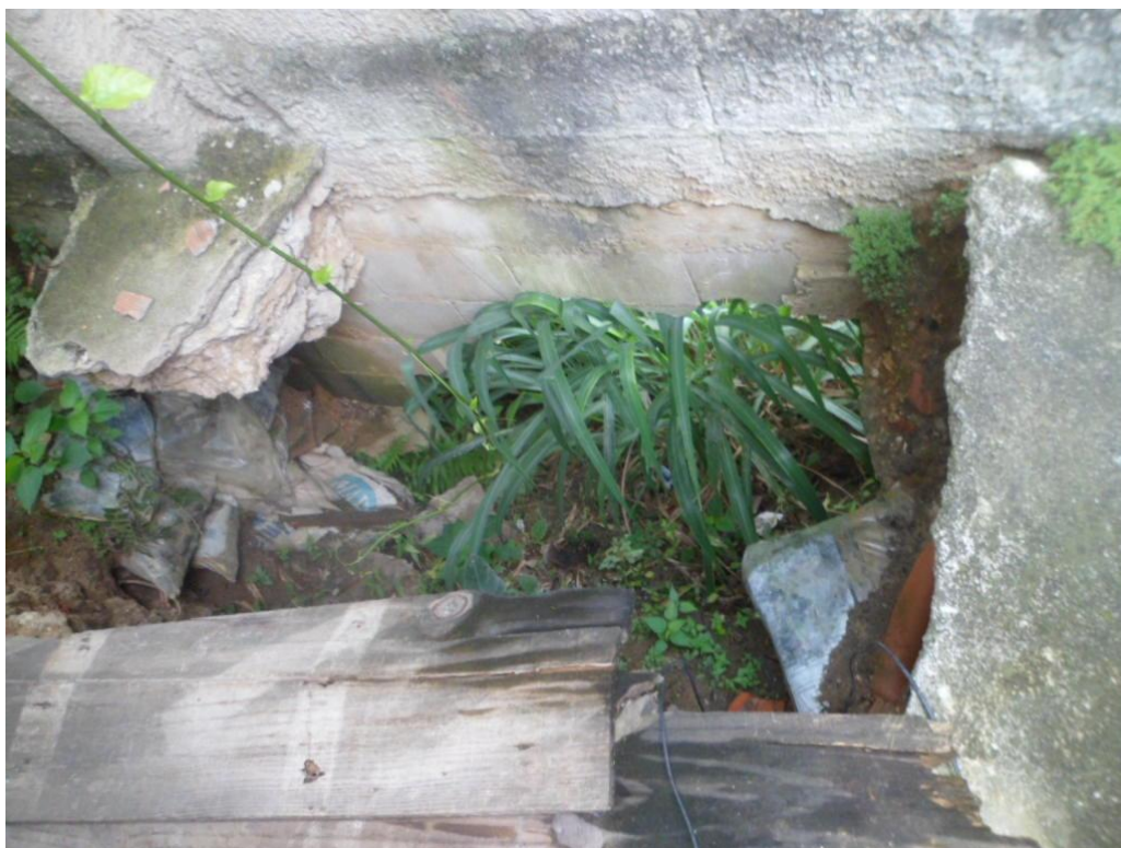
Foto 07 – Sapatas do Muro flutuando, e Terreno preenchido com sacos de entulho
