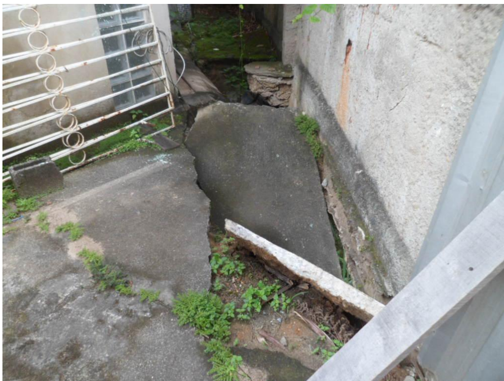
Foto 05 – Piso nos Fundos da Casa afundado
