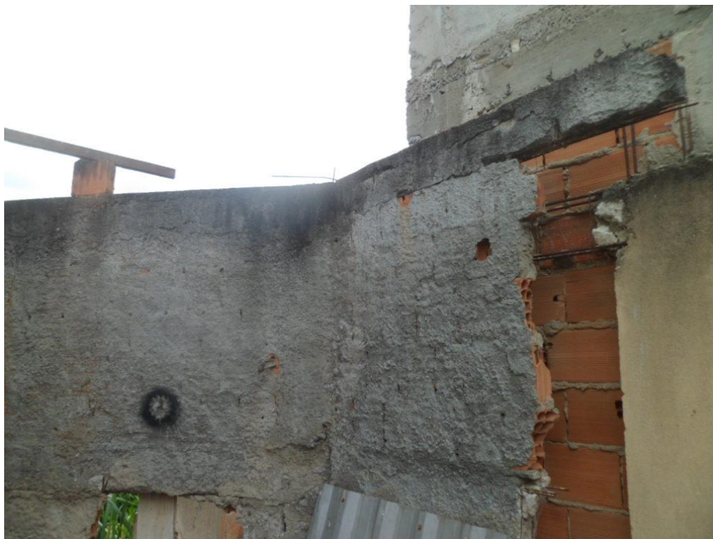
Foto 10 – Vigas deterioradas com ferragens expostas e sem amarração
