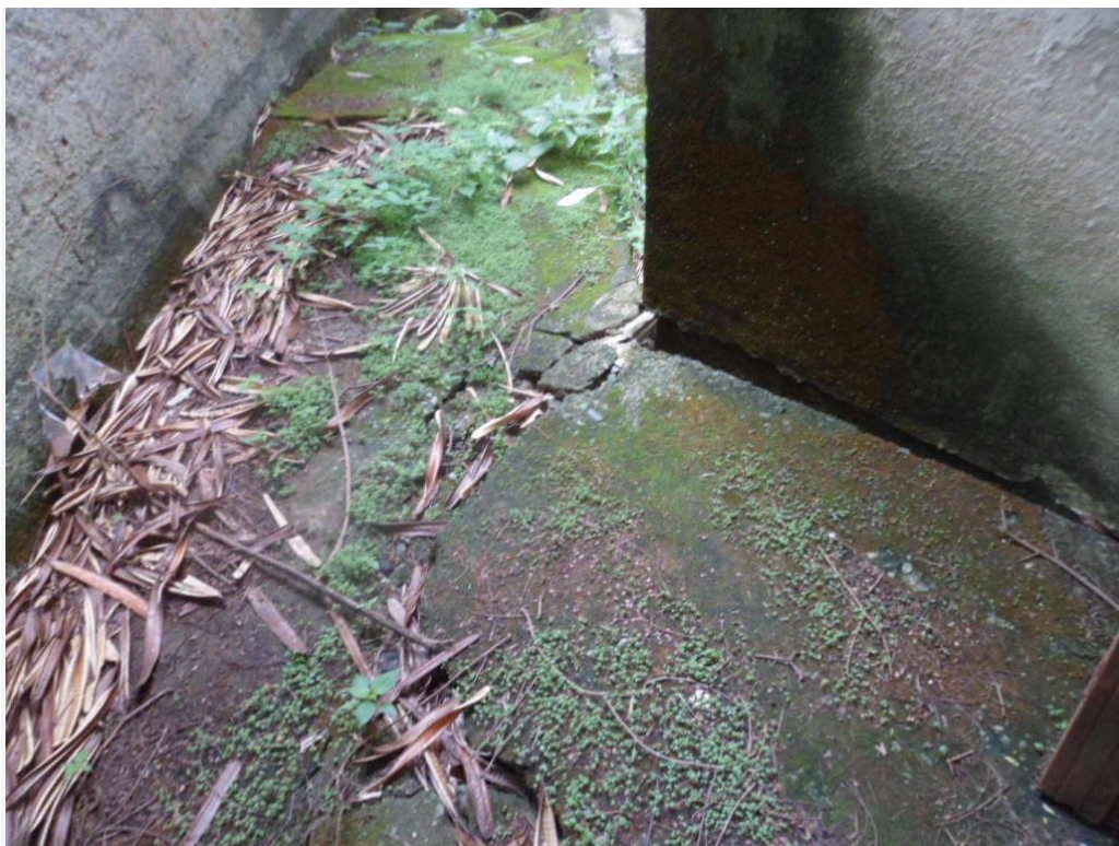
Foto 12 – Afundamento do piso próximo à coluna do imóvel
