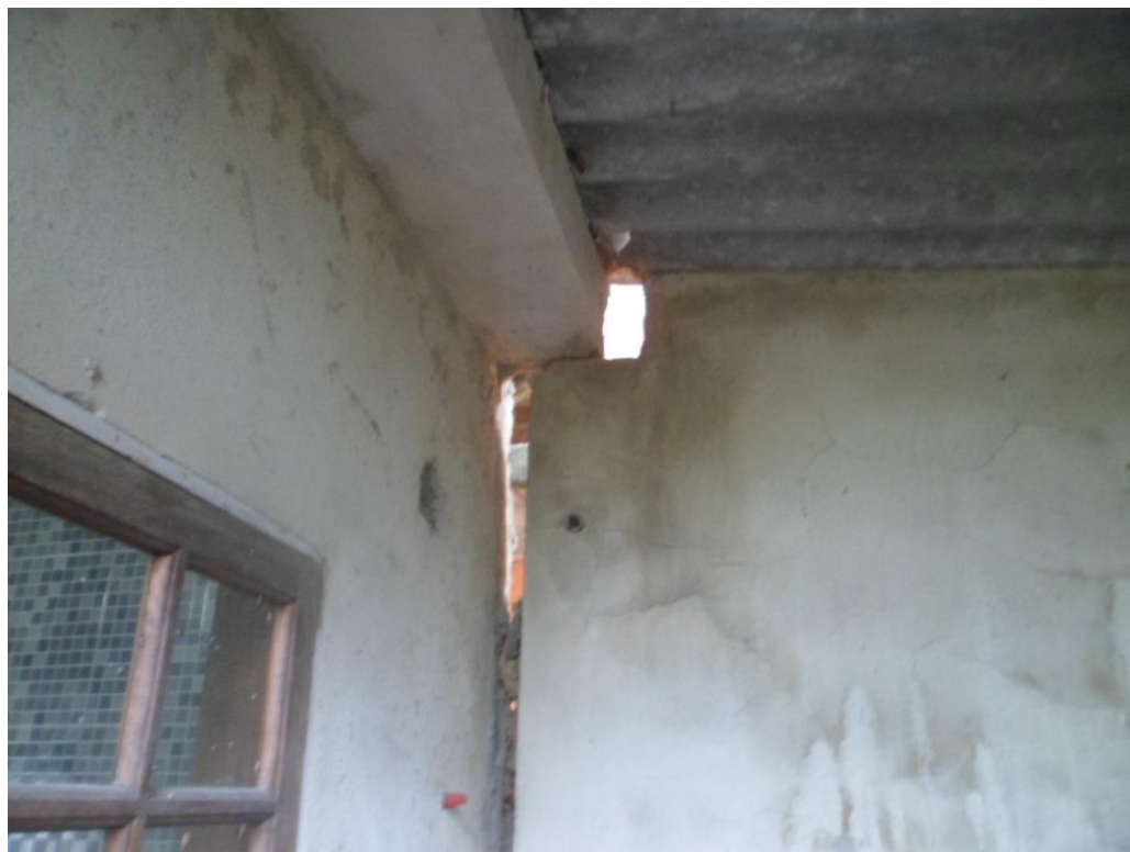
Foto 11 – Dilatação da estrutura de um anexo do imóvel (sem amarração)
