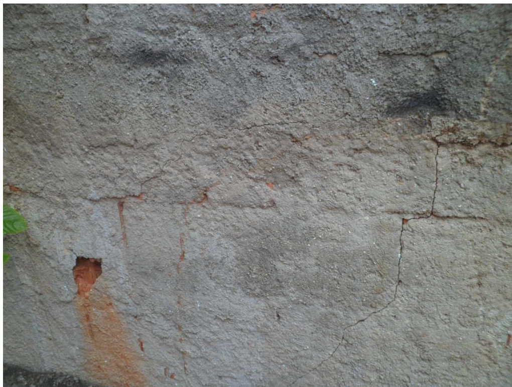
Foto 09 – Rachaduras por todo o muro
