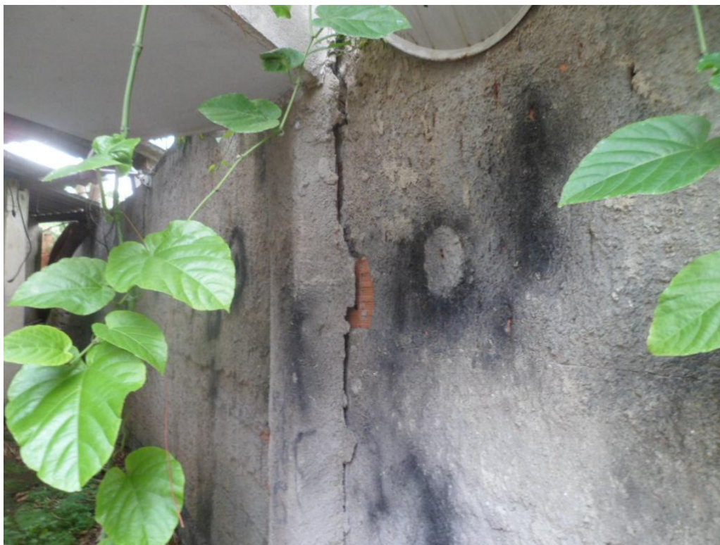
Foto 08 – Rachaduras no muro e coluna desprendendo do muro
