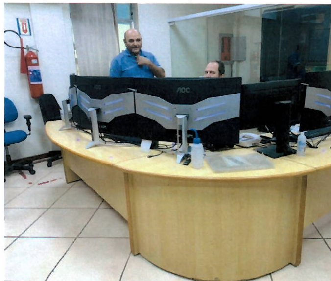
Sala de comando - CCO
