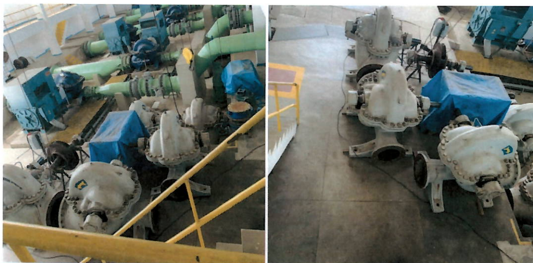
Grupos de bombas
