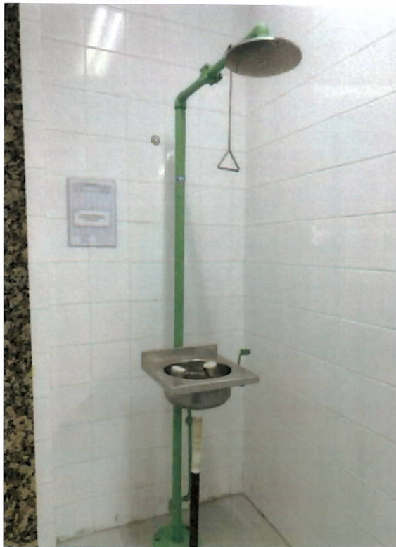
Chuveiro de emergência – Conforme NBR 16291/2014
