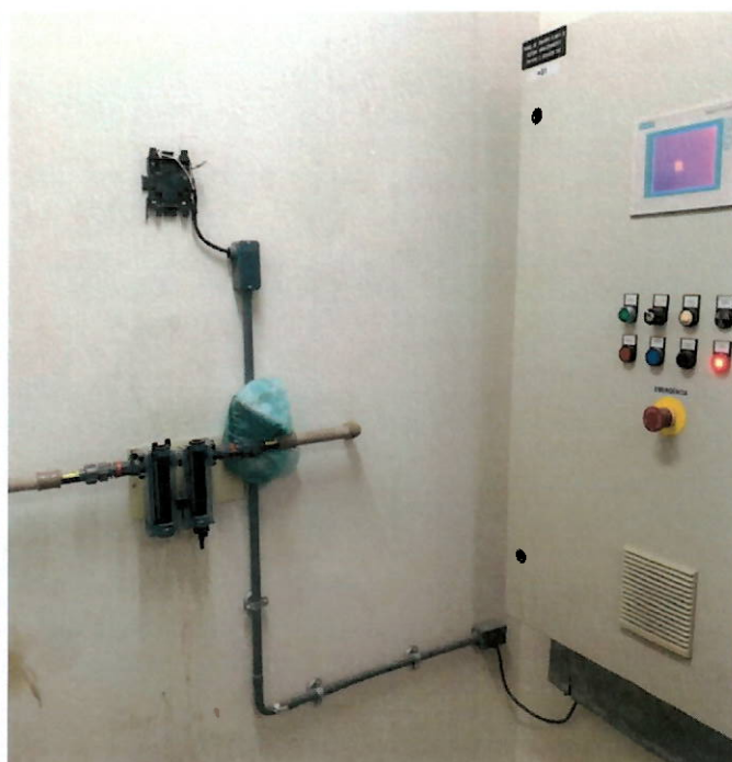
Painel reserva de comando do sistema dosador
