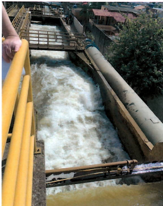
Caixa de entrada de água bruta
