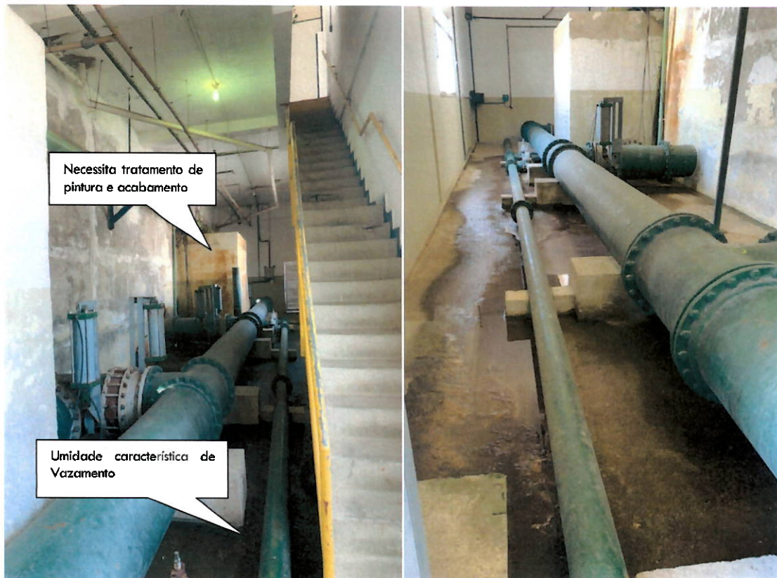
Sistema de lavagem dos filtros + Adução reservatório de água tratada
