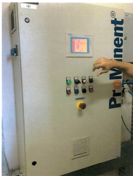
Painel de comando do sistema dosador
