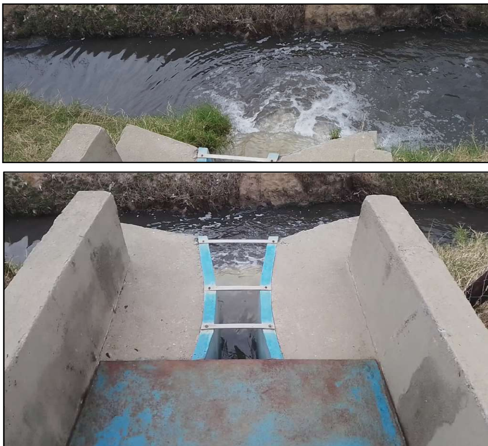
Figura 9 – Medidor de vazão do efluente final tipo Calha Parshall sem sensor ultrassônico e com régua ilegível e a saída do esgoto tratado para o canal Malhado. Efluente final visualmente turvo no momento da vistoria . Chapa metálica sobre o medidor com corrosão
