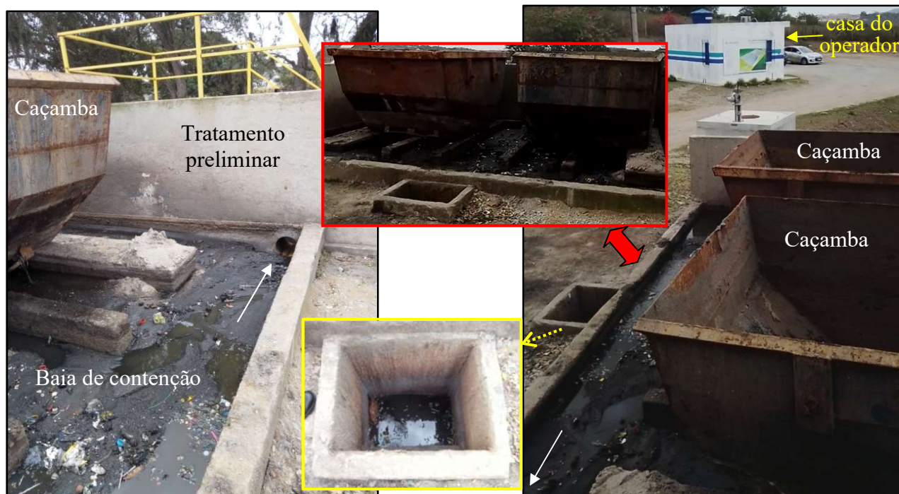
Figura 4 – Duas caçambas para recebimento de esgoto bruto de caminhões limpa-fossa e armazenamento de resíduos sólidos e areia da entrada da ETE. Em estado precário de conservação (caçambas enferrujadas ) e de limpeza pelos terceiros que lançam (lodo e resíduos a céu aberto)
