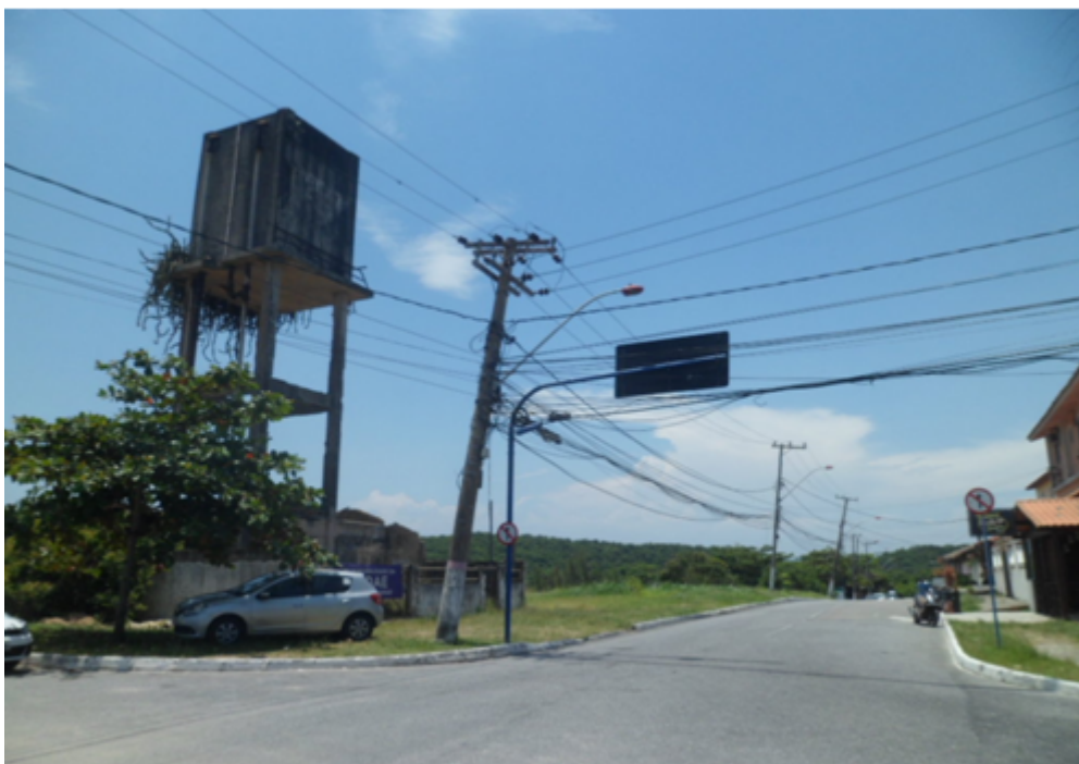
Foto 03 – Reservatório próximo à rua (risco aos pedestres e aos automóveis)
