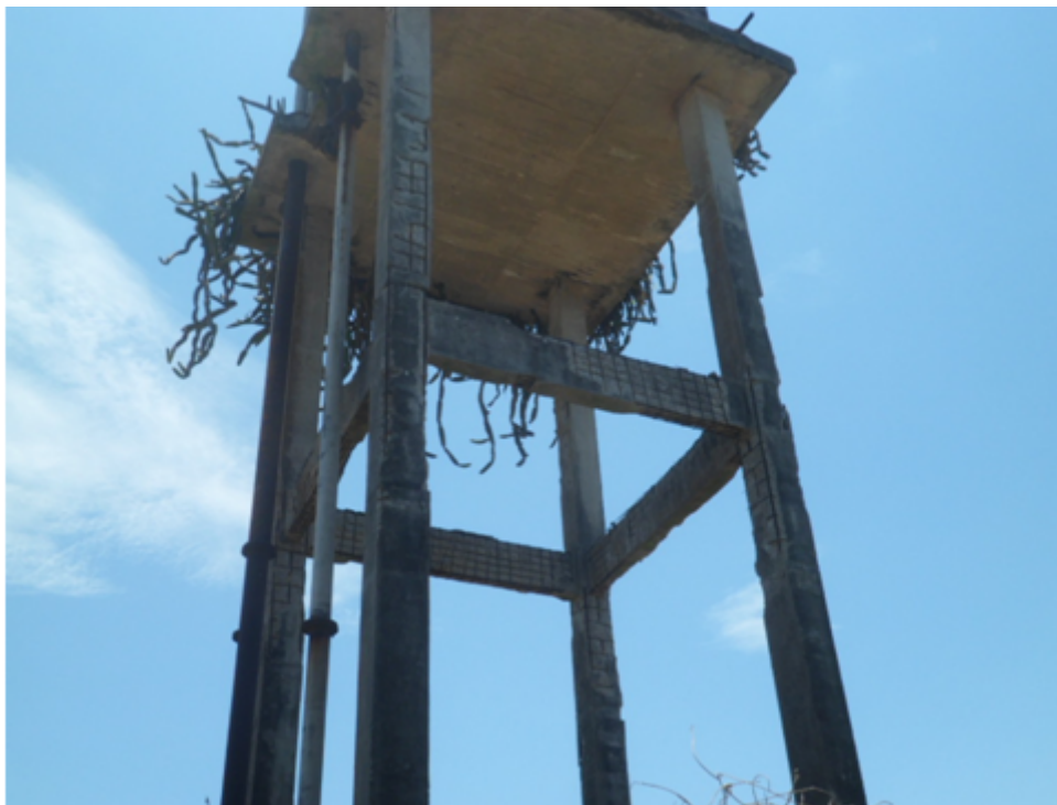
Foto 13 – Vigas e colunas deterioradas com ferragens expostas
