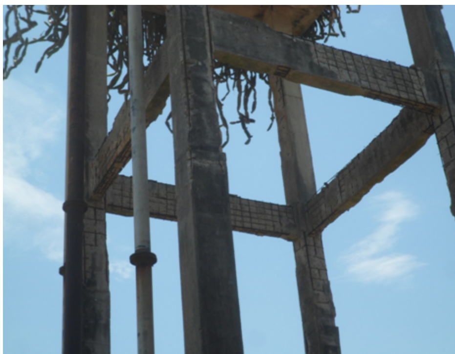
Foto 12 – Vigas e colunas deterioradas com ferragens expostas
