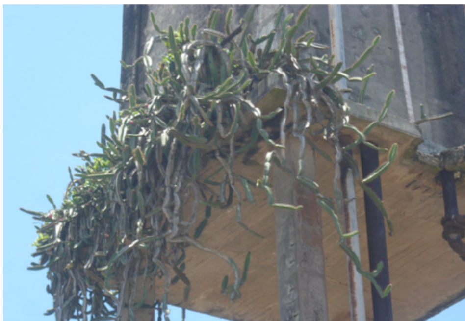
Foto 14 – Grande concentração de vegetação na estrutura do reservatório
