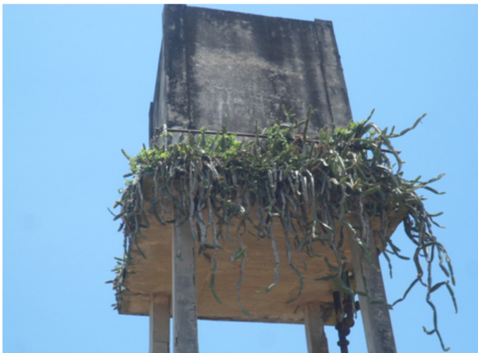
Foto 15 – Grande concentração de vegetação na estrutura do reservatório
