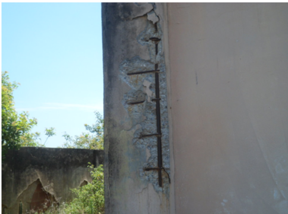
Foto 09 – Coluna da base deteriorada
