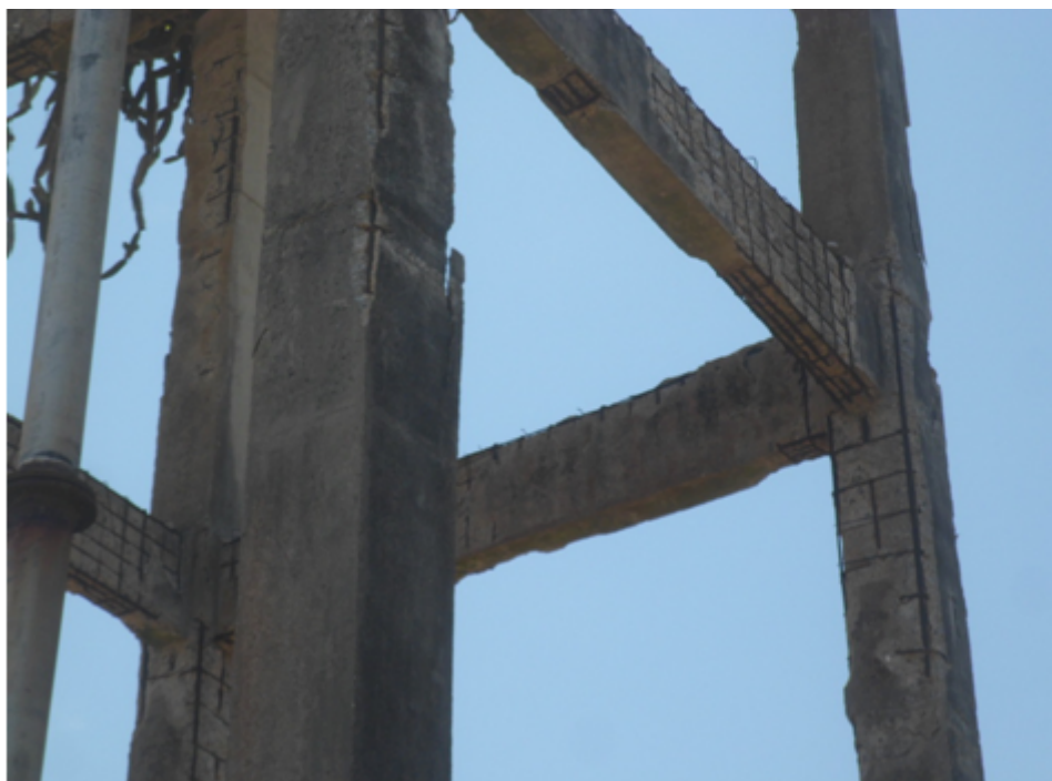
Foto 11 – Vigas e colunas deterioradas com ferragens expostas
