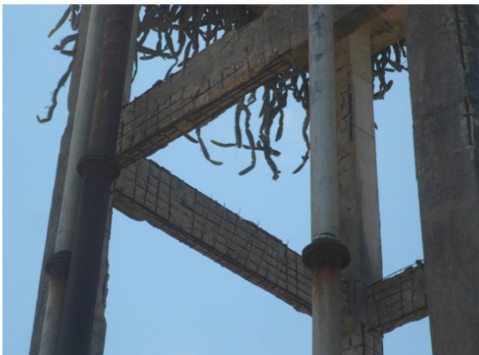
Foto 10 – Vigas deterioradas com ferragens expostas
