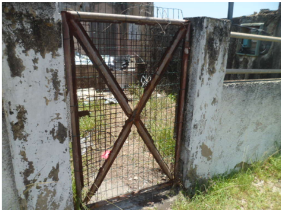
Foto 07 – Portão de entrada em deterioração
