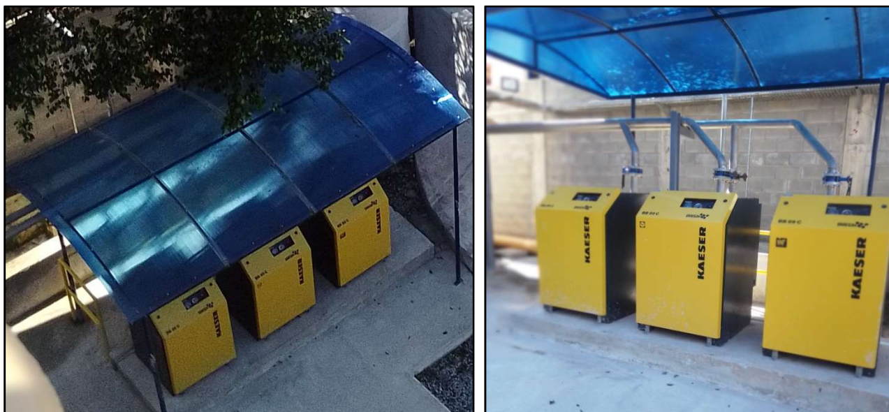
Figura 8 – Sopradores de ar para o Tanque RANOX da ETE, abrigados sobre base em concreto e enclausurados com abafadores de ruído, mas com som ainda elevado para a vizinhança
