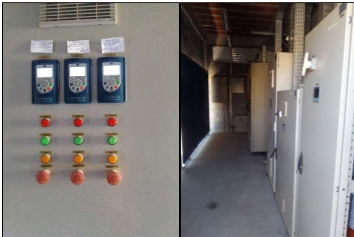
Figura 9 – Sala dos painéis de comando elétrico dos motores da ETE Itaúna
