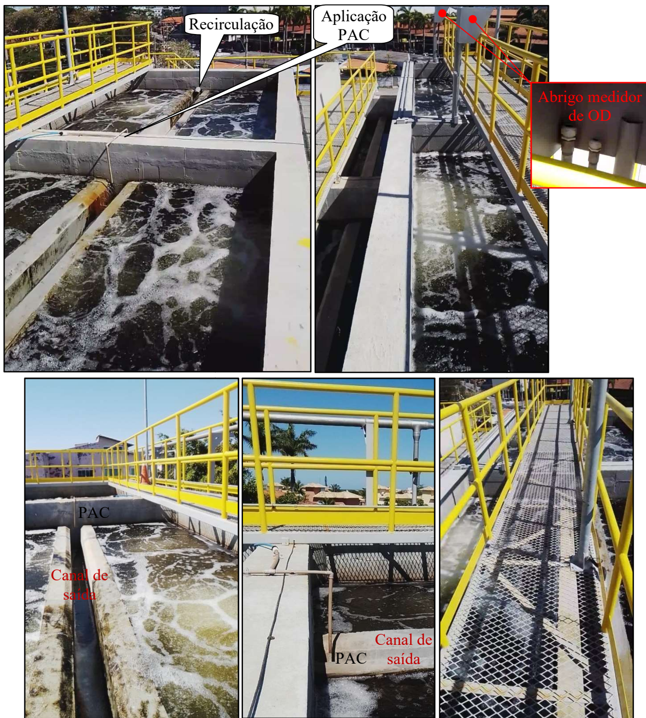
Figura 5 - Tratamento primário-secundário em reator de concreto armado, sendo anóxico (parte inferior) e aeróbico (parte superior) – RANOX: Dois tanques de aeração (4 câmaras cada) sem vertedores (“caminhos preferenciais”) para o canal de saída e sem automação do controle do oxigênio dissolvido ( aparelhos OD ainda não implantados ). Destaques do ponto de aplicação do PAC (tratamento terciário) no canal de saída dos tanques de aeração para os decantadores secundários (e terciários) no centro, e do ponto de recirculação do efluente ( ainda fora de carga )
