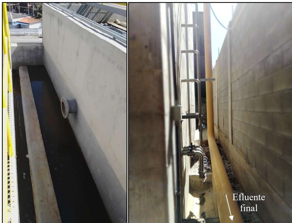
Figura 6 – Decantador secundário-terciário tipo lamelar (parte central no tanque RANOX): entrada ascendente do efluente do Tanque de Aeração no fundo já com o PAC (vista superior na imagem da esquerda); saída do efluente final tratado do Decantador e saídas dos diversos pontos (alturas) de amostragem de lodo do RANOX - anóxico e decantador (vista lateral na imagem da direita)
