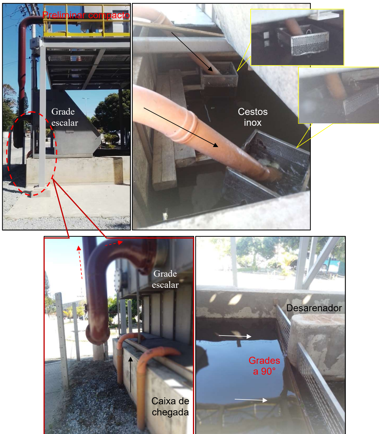
Figura 1 – Entrada dos recalques de esgoto bruto no tratamento preliminar da ETE: previsão ( fora de carga ) de entrada no sistema de tratamento preliminar compacto (gradeamento, caixa de areia e remoção de óleo e graxas) e no gradeamento tipo peneira estática escalar com abertura em malha fina; caixa de entrada com dois cestos inox com abertura de malha fina; duas grades fixas em aço inox a 90° de abertura de malha fina à montante dos desarenadores. Destaque para a improvisação de cestos soltos na caixa de entrada.
