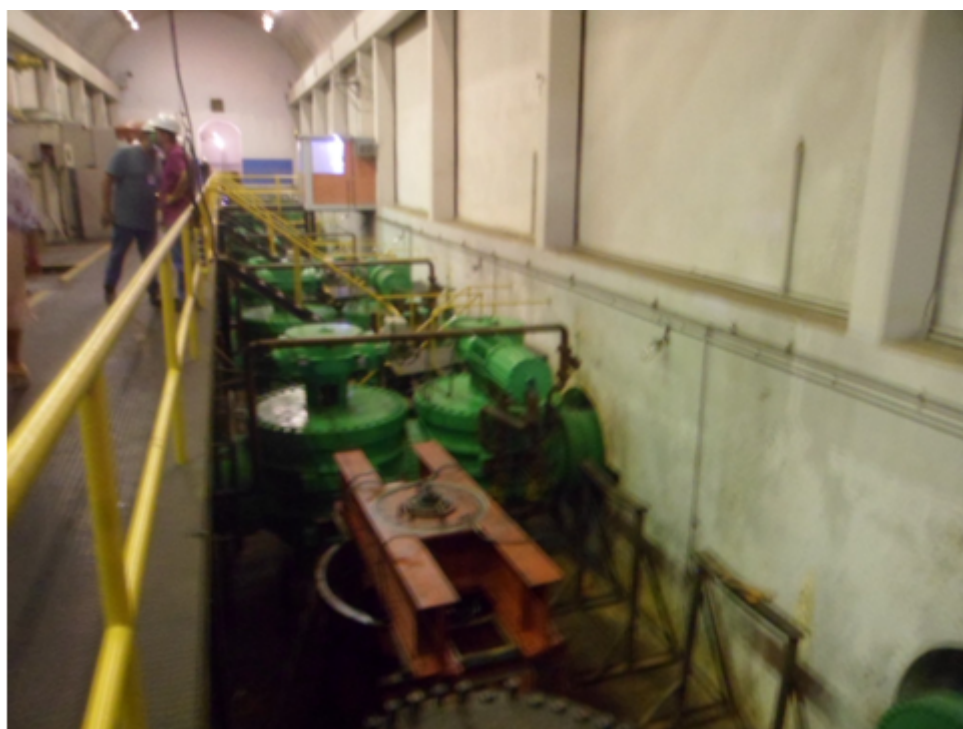
Foto 05 – Galeria de Válvulas
