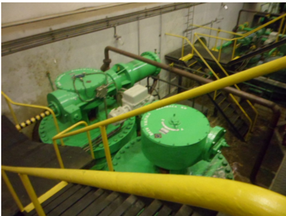
Foto 06 – Conjunto Válvulas (Elétrica e Hidráulica)
