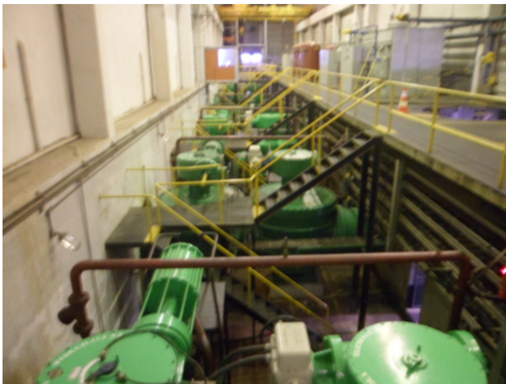
Foto 03 – Galeria de Bombas
