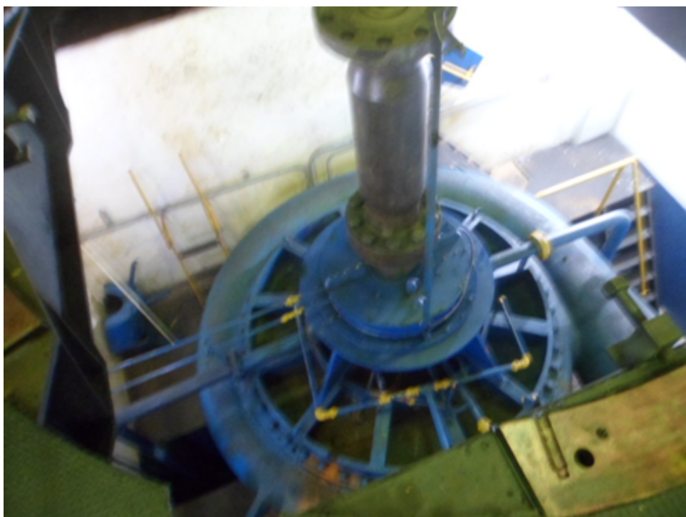
Foto 07 – Bomba de recalque
