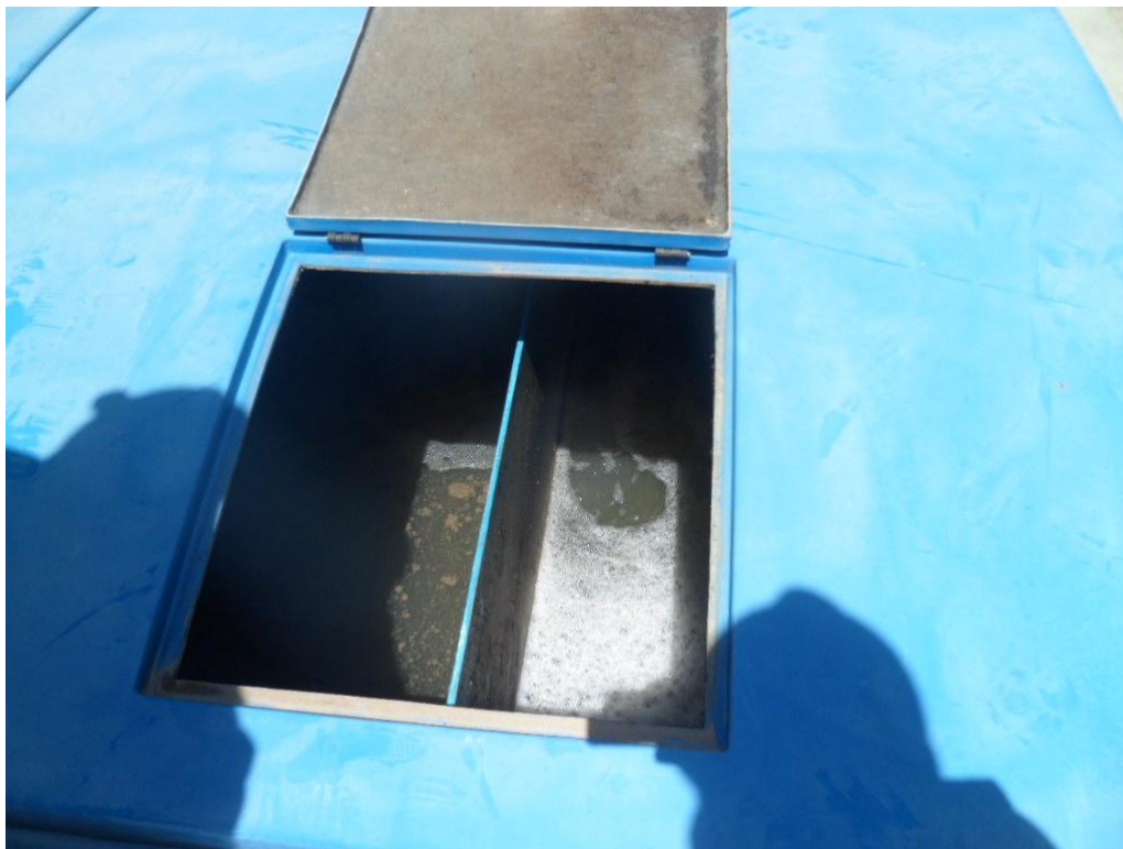
Foto 07 – Caixa de Gordura
