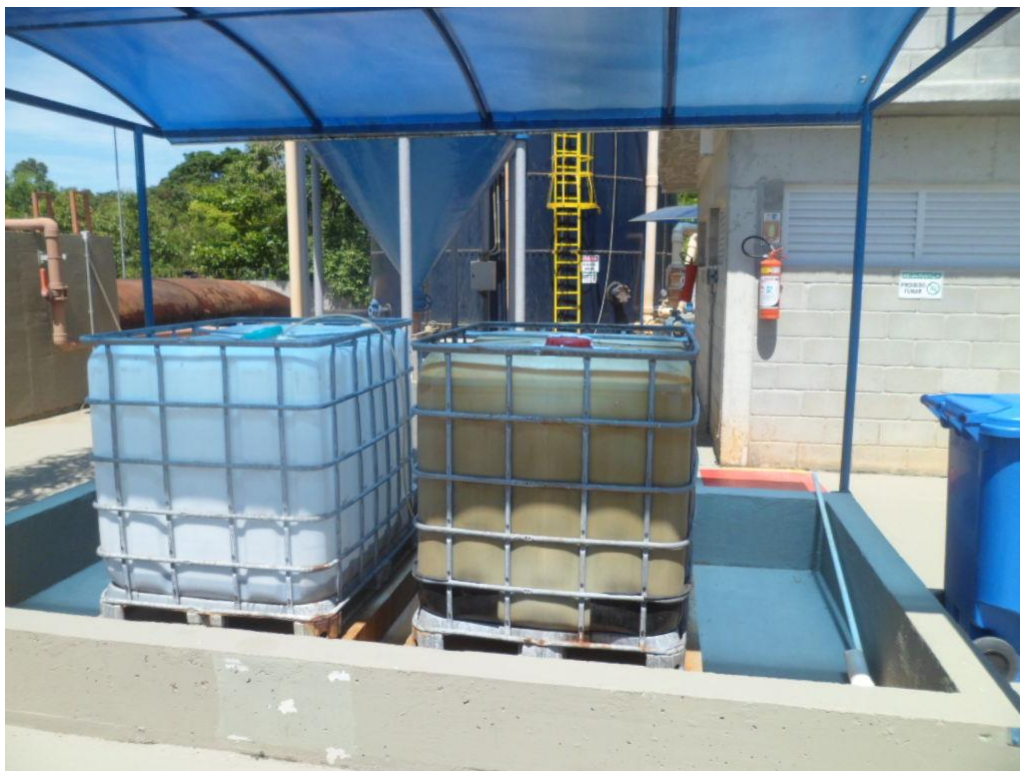
Foto 08 – Reservatórios de Policloreto de Alumínio (PAC)
