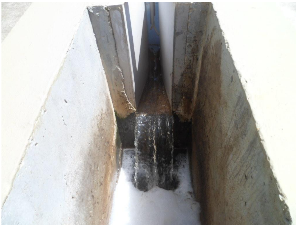
Foto 06 – Medidor de Vazão (Calha Parshall)
