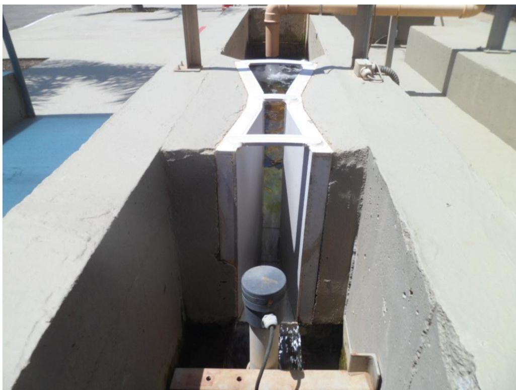
Foto 17 – Calha Parshall, Medidor de Vazão Ultrassônico e Saída do Esgoto Tratado
