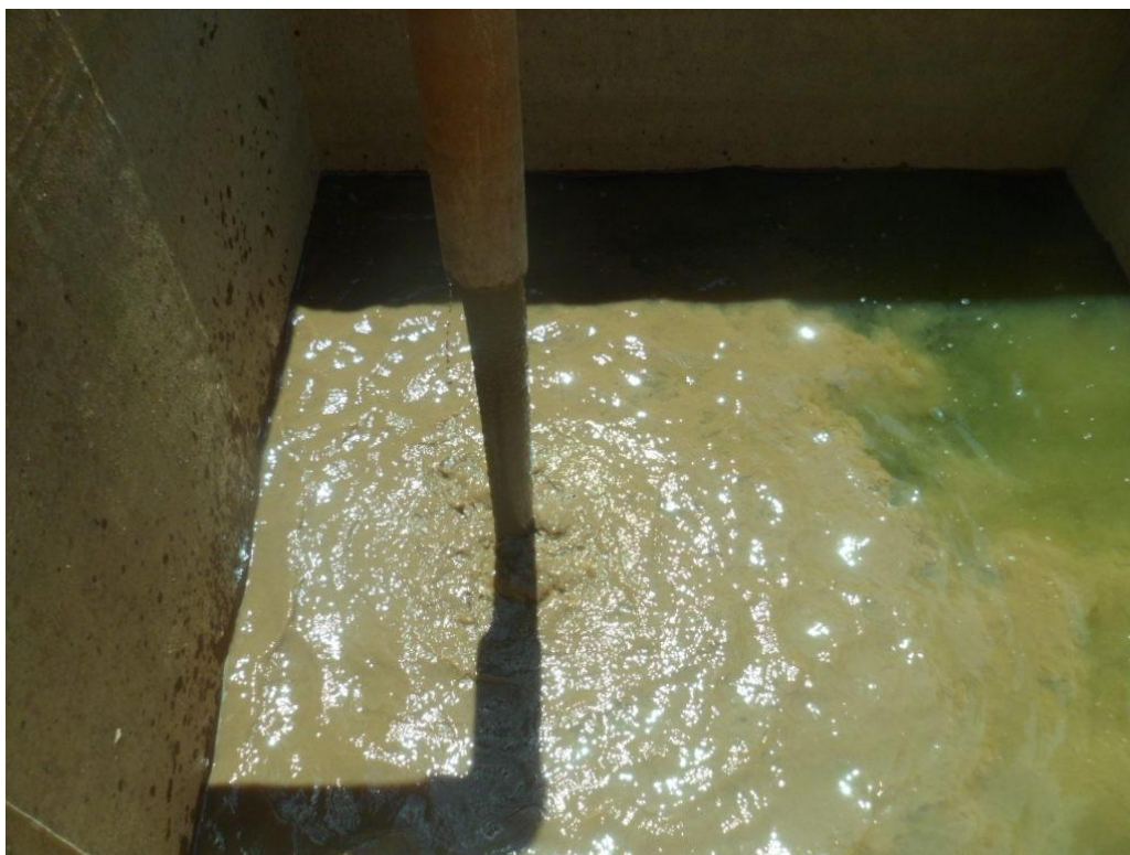
Foto 13 – Saída do Lodo do Fundo do Decantador
