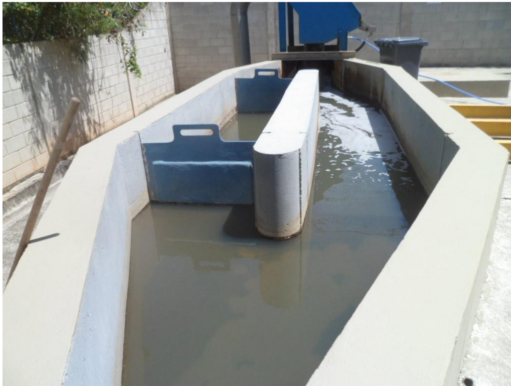
Foto 05 – Caixas de Areia
