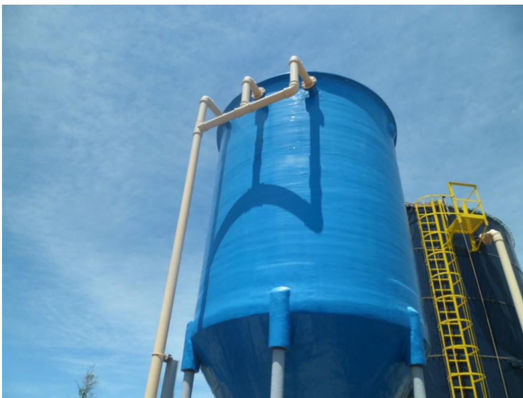
Foto 11 – Tanque de Decantação
