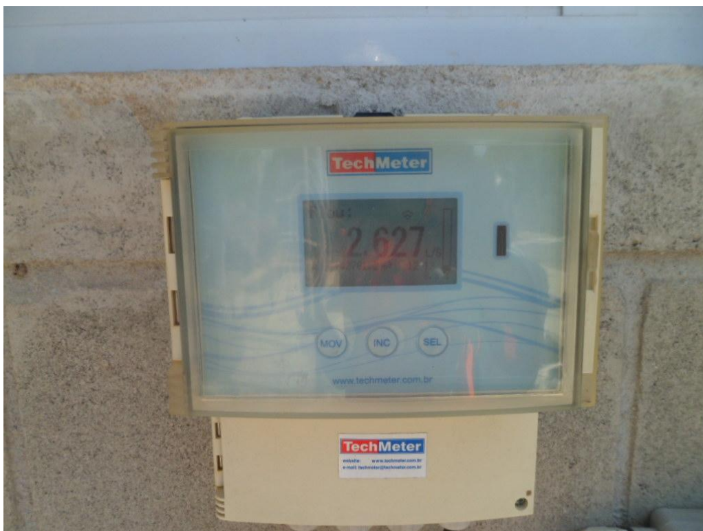
Foto 18 – Medidor de Vazão Ultrassônico Saída do Esgoto Tratada 2,627 l/s
