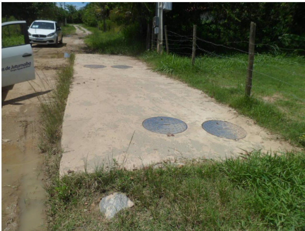
Foto 21 – Elevatória Arraia que Recalca para ETE Jacarepiá
