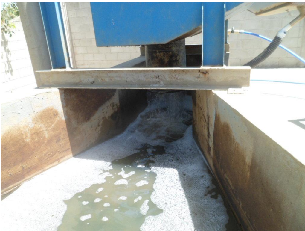
Foto 04 – Entrada do Esgoto Bruto (In Natura)
