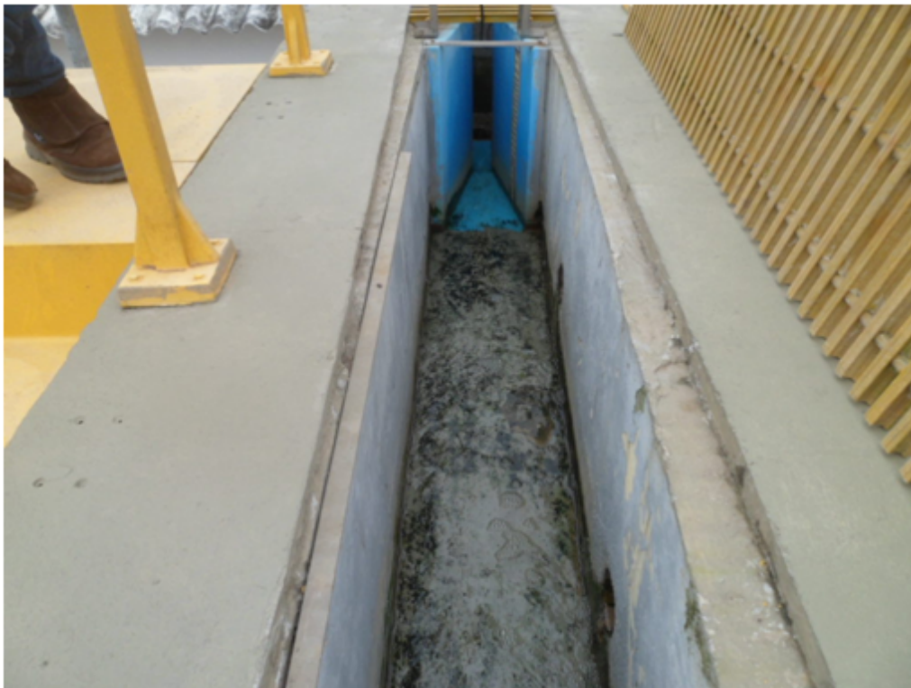
Foto 18 – Calha Parshall Medindo de Vazão Saída do Esgoto Tratado
