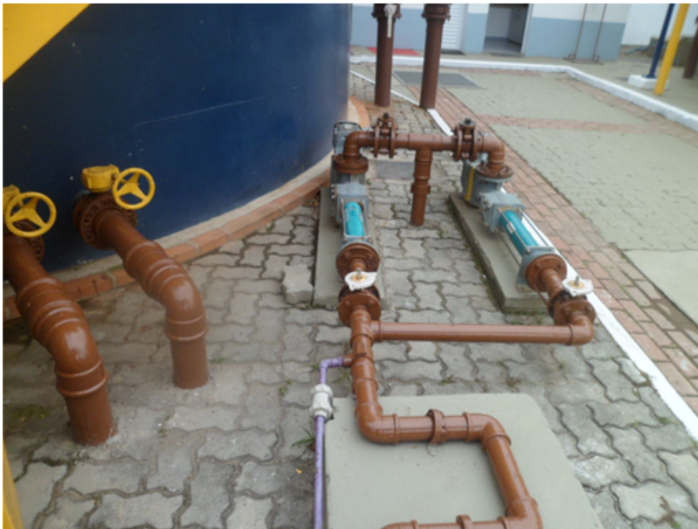
Foto 20 – Registros de Controle da Saída do Lodo
