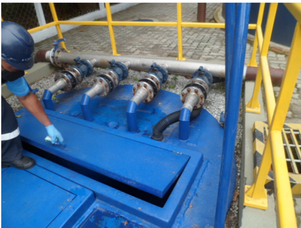
Foto 09 – 03 (três) Bombas que recalcam o Esgoto Bruto para o Tanque de Aeração e 01(uma) de Reserva
