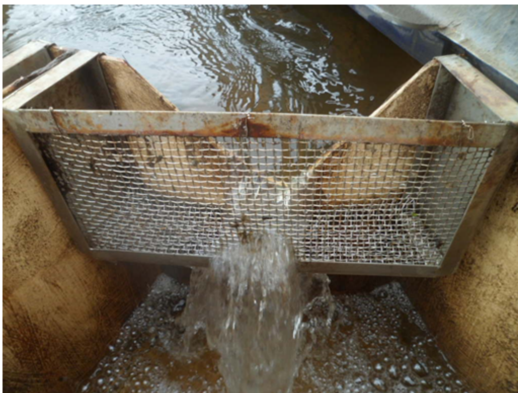
Foto 15 – Tanque de Aeração, Grades de Retenção de Resíduos Menores
