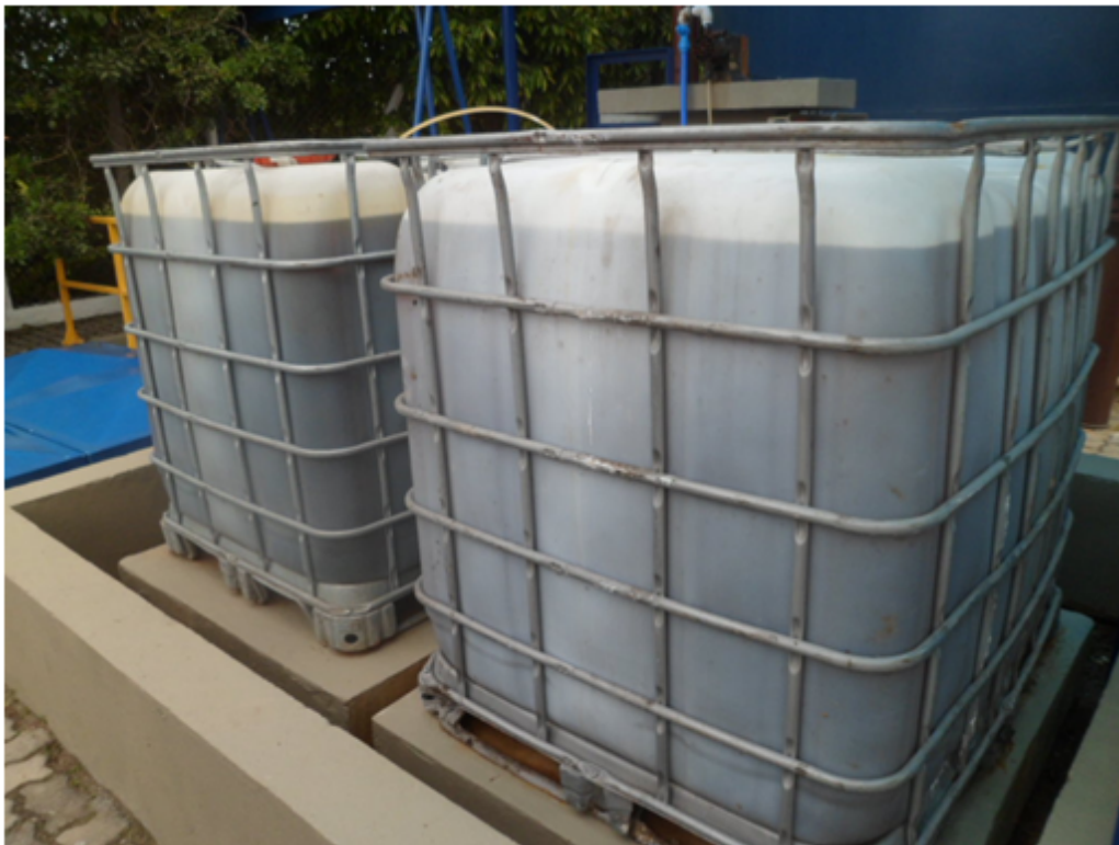
Foto 12 – Reservatórios de Policloreto de Alumínio (PAC)
