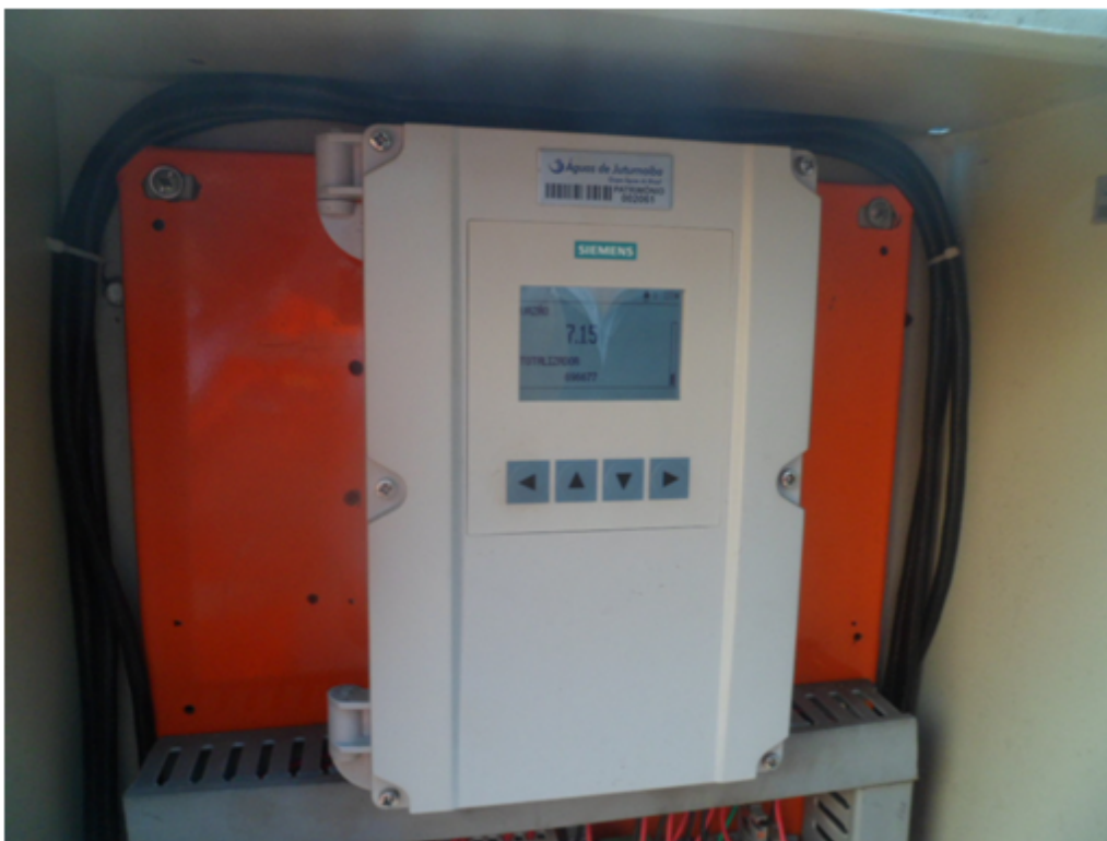
Foto 08 – Medidor de Vazão Ultrassônico 7,15 l/s
