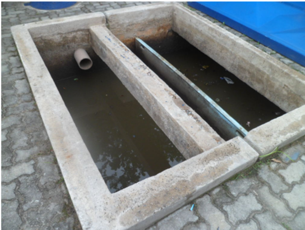
Foto 06 – Caixas de Gordura
