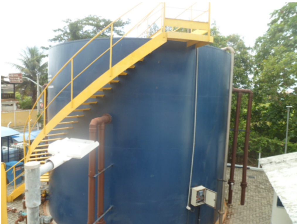
Foto 14 – Tanque de Aeração Vista Lateral
