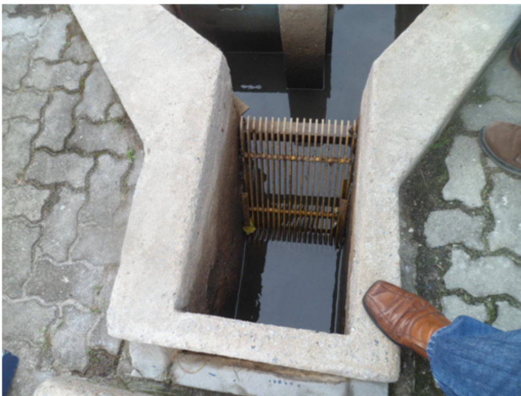
Foto 04 – Gradeamento para Retenção de Resíduos Sólidos
