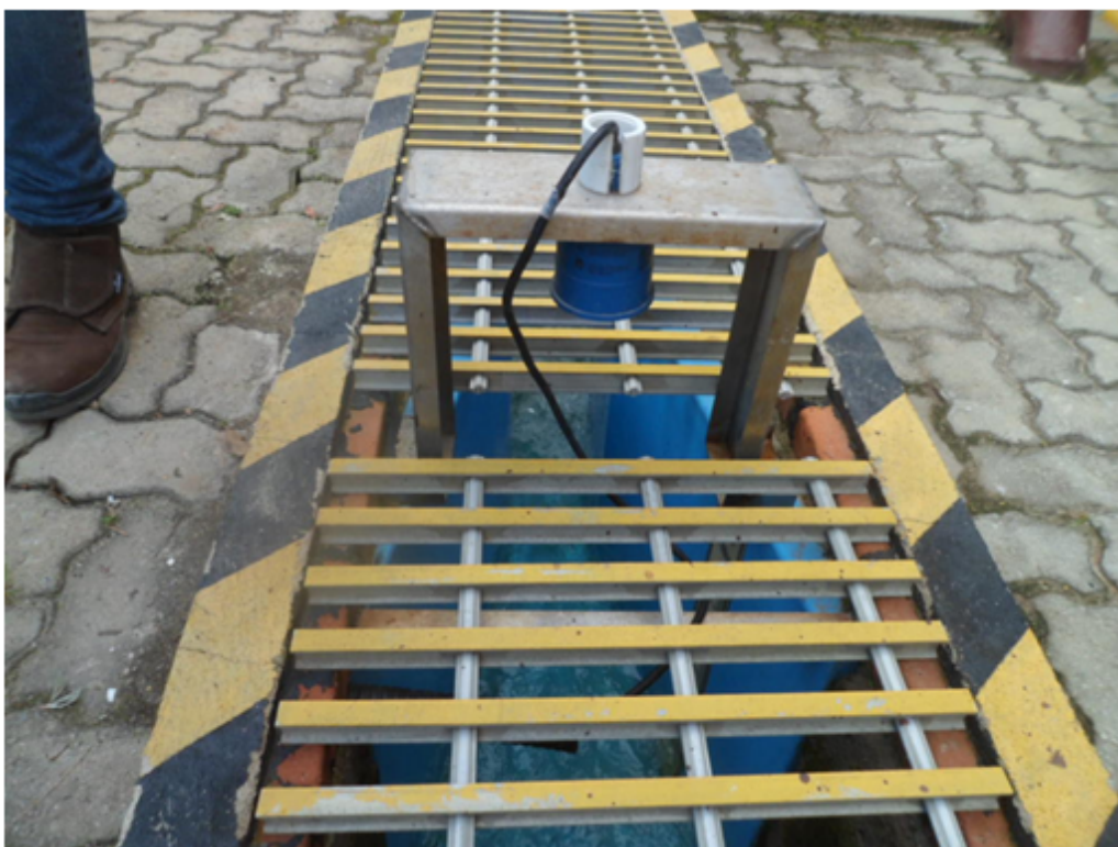
Foto 07 – Medidor de Vazão Ultrassônico na Calha Parshall (Esgoto In natura)
