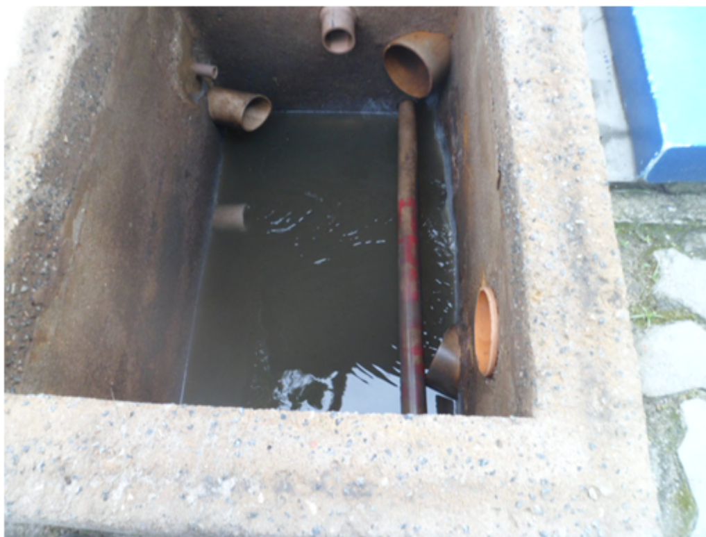
Foto 03 – Caixa Receptora dos Esgotos In Natura Advindo das Elevatórias (Início do Processo)
