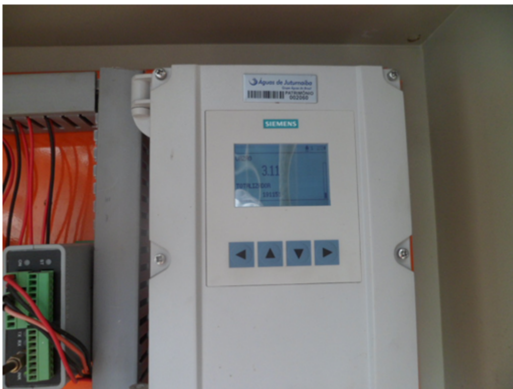
Foto 19 – Medidor de Vazão Ultrassônico Saída do Esgoto Tratada 3,11 l/s
