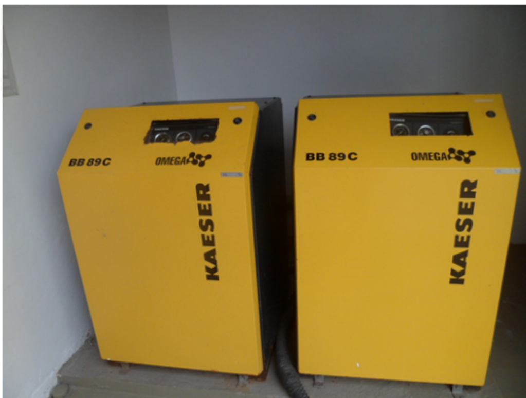
Foto 13 – Soprador que Lança Carga de Ar para os Aeradores
