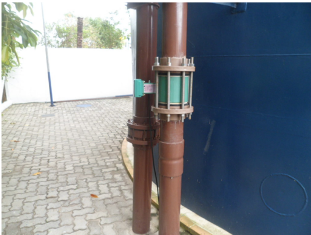
Foto 10 – Tubulação de Entrada e Recirculação com Medidor de Vazão Ultrassônico
