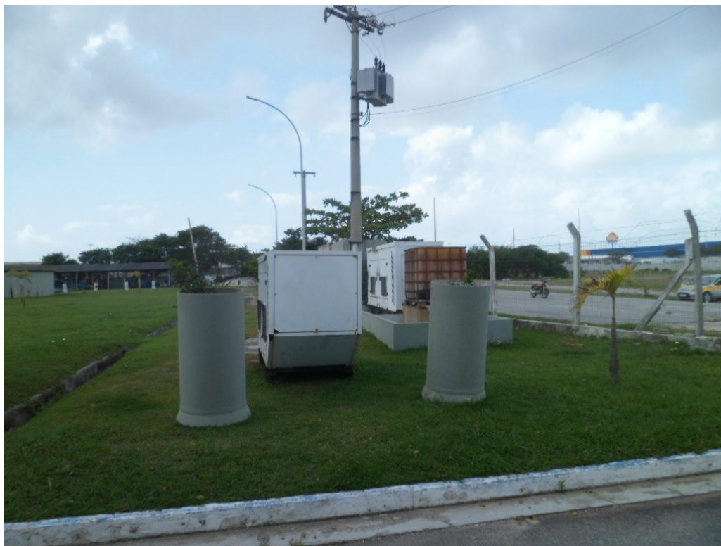
Foto 18 – Geradores para Atendimento a falta de Energia
