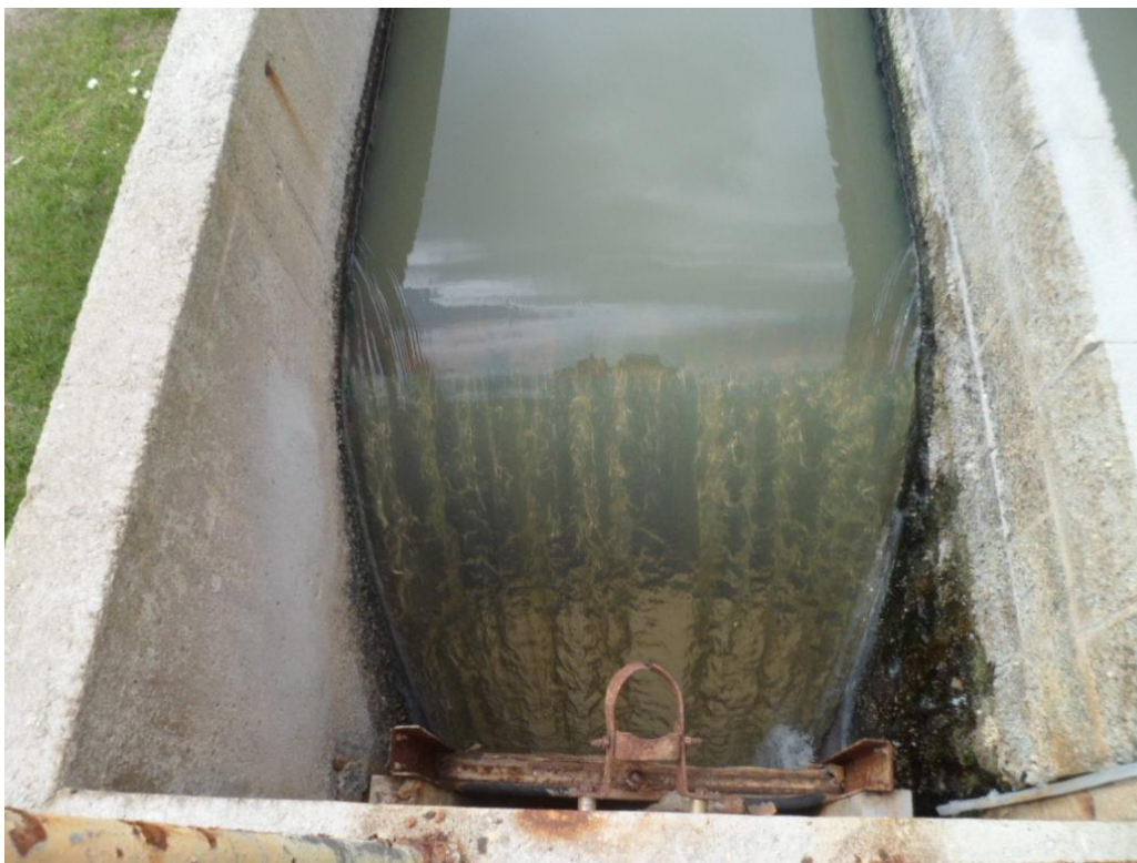
Foto 24 – Câmara de Contato de Desinfecção (Saída do Esgoto Tratado)
