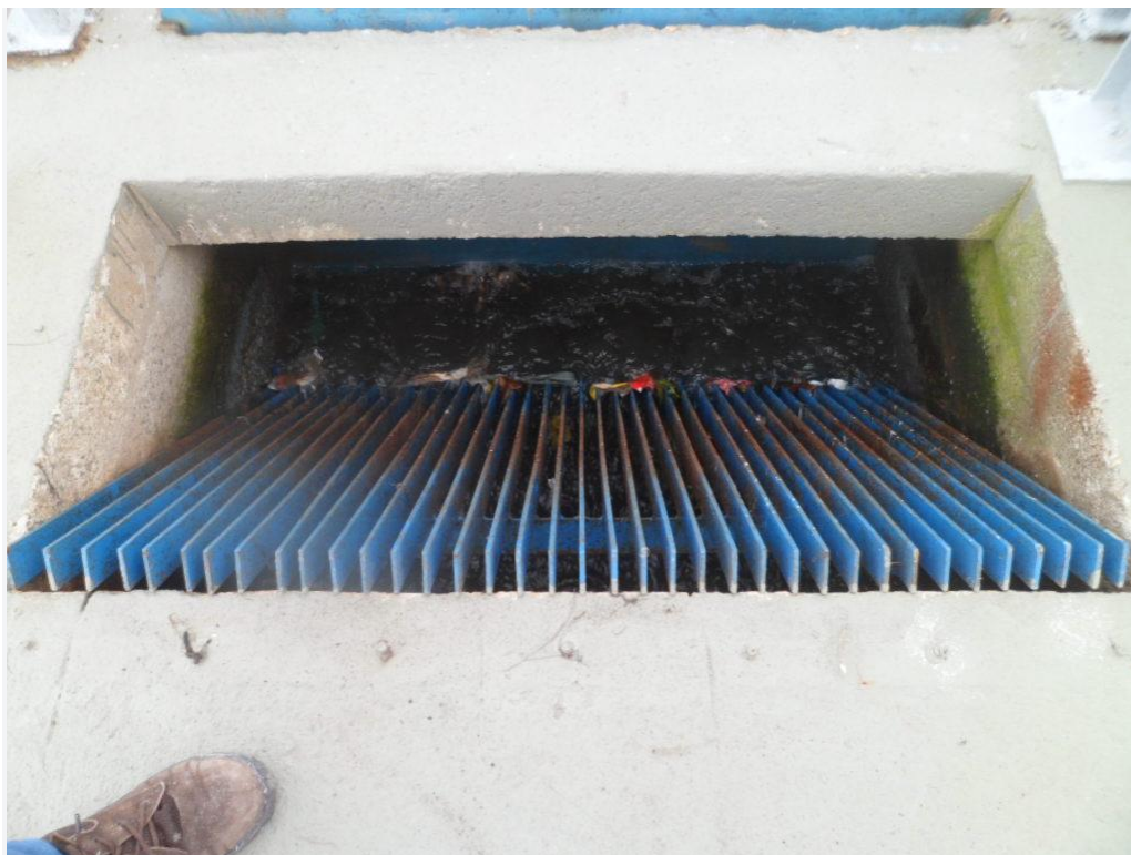
Foto 03 – Entrada do Esgoto In Natura e Grade de Retenção de Resíduos Grosseiro
