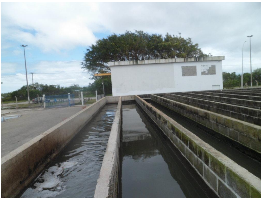
Foto 23– Câmara de Contato de Desinfecção (Entrada do Esgoto Tratado)
