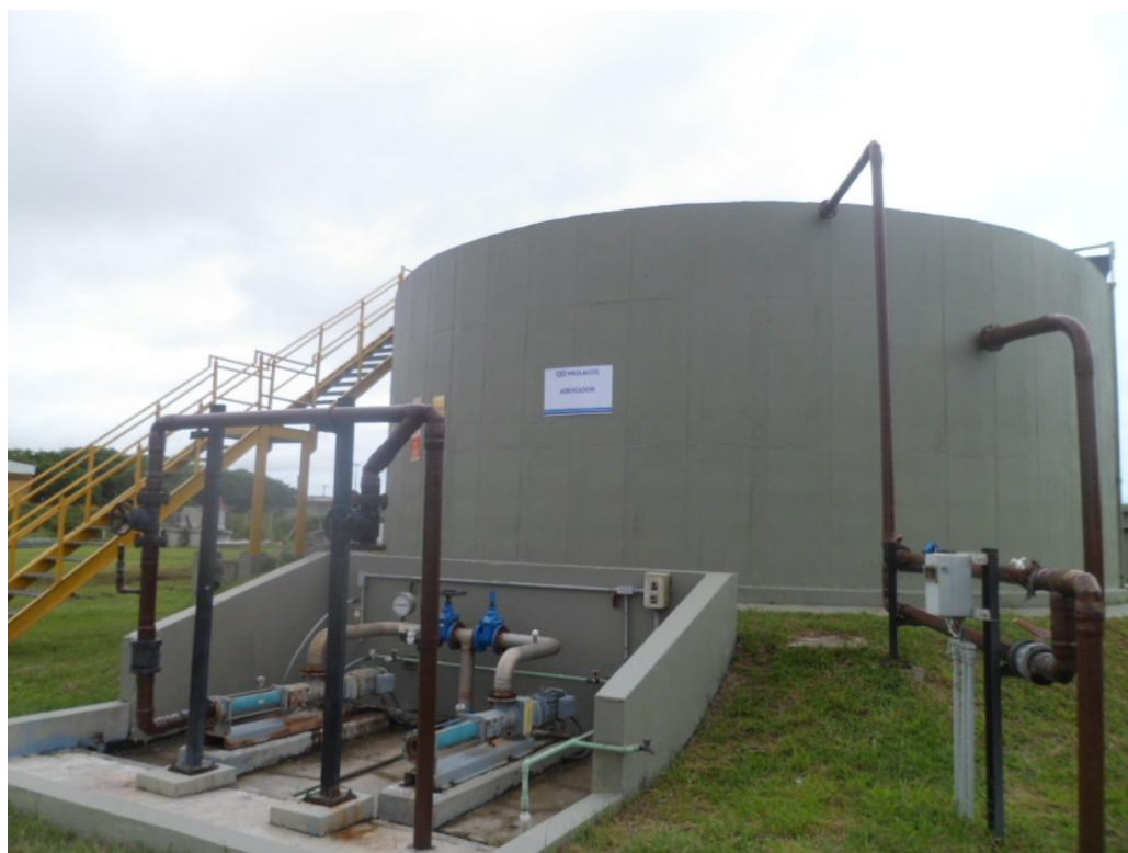
Foto 13 – Tanque de Adensamento do Lodo Vista Lateral
