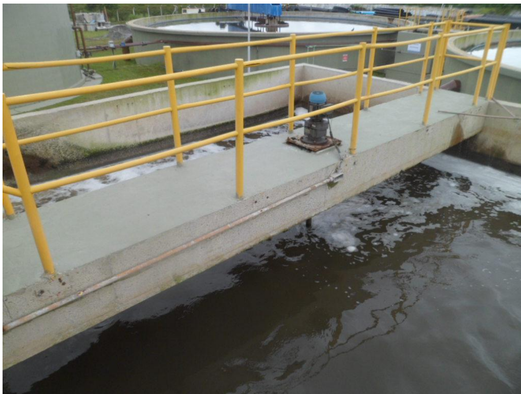
Foto 09 – Tanque de Floculação com Agitador Mecânico
