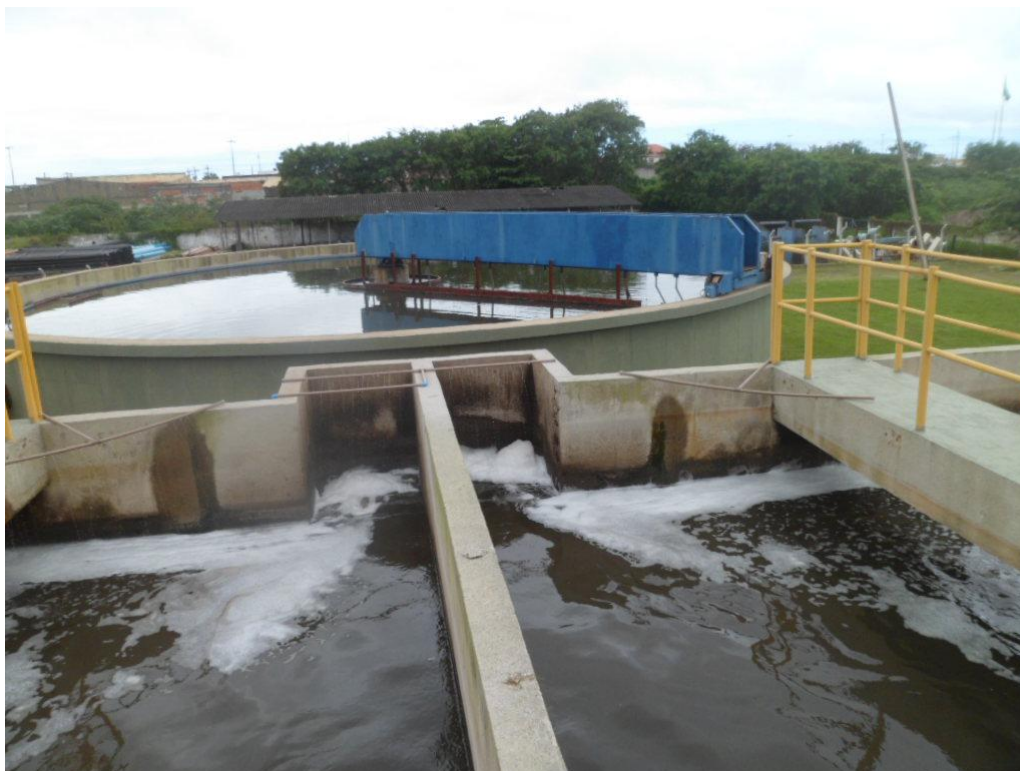
Foto 10 – 02 Tanques de Floculação
