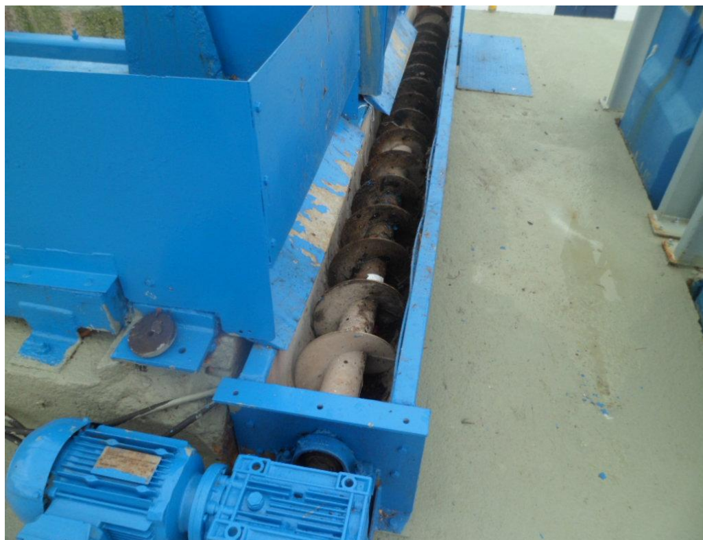
Foto 05 – Rosca Transportadora de Resíduos
