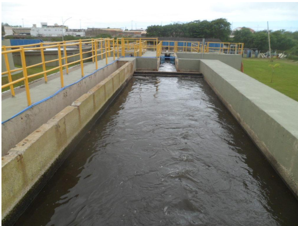
Foto 07 – Após o Gradeamento, Caixa de Areia com Aplicação de PAC
