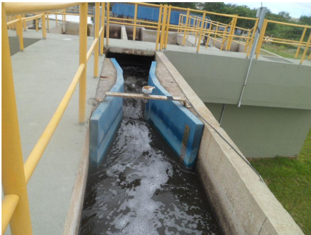
Foto 08– Calha Parshall com Medidor de Vazão Ultrassônico
