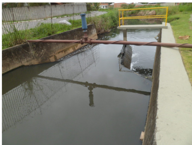
Foto 03 – Interceptor no Rio Bacaxá (Extravasando por Conta das Chuvas) a Jusante
