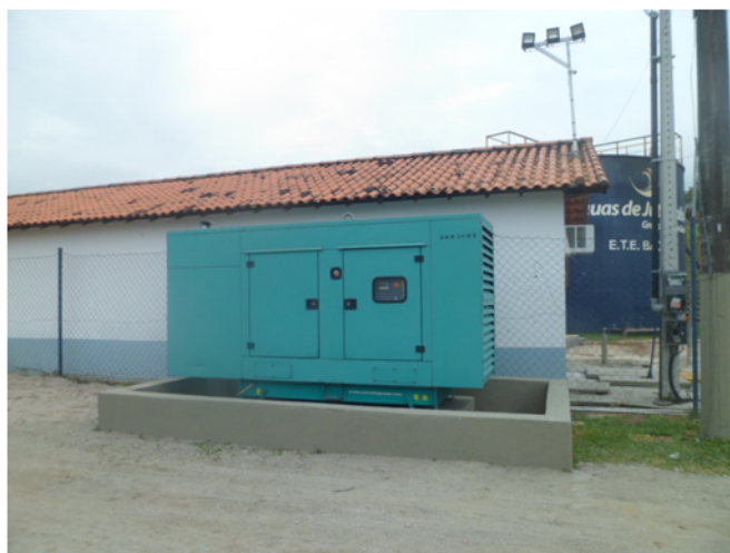
Foto 27 – Gerador para Falta de Energia
