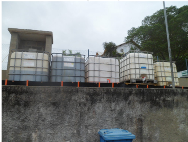
Foto 13 – Reservatórios de Policloreto de Alumínio
