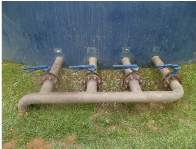
Foto 21 – Registros de Controle da Saída do Lodo
