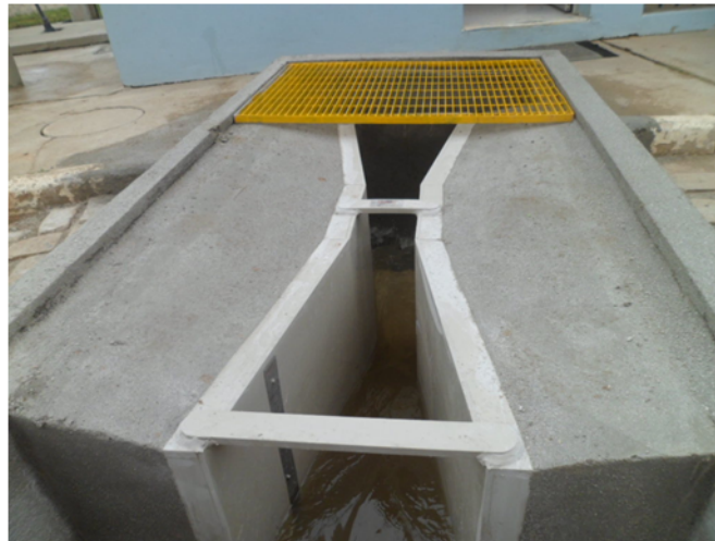
Foto 30 – Calha Parshall Medindo Saída do Esgoto Tratado
