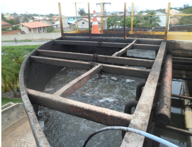
Foto 17 – Tanque de Aeração 1
