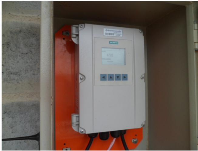
Foto 11 – Medidor de Vazão Ultrassônico 47,01 l/s
