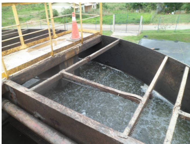
Foto 18 – Tanque de Aeração 2
