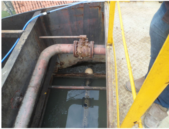
Foto 20 – Saída do Tanque de Decantação
