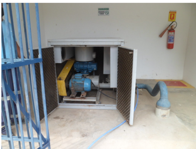
Foto 15 – Soprador que Lança Carga de Ar para os Aeradores
