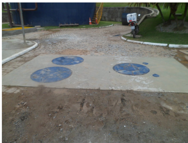
Foto 05 – Tampas sobre a Elevatória na entrada da ETE
