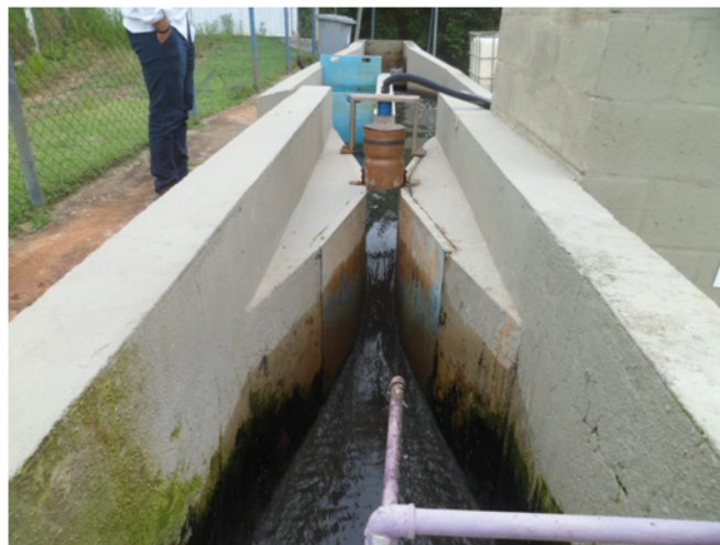
Foto 10 – Medidor de Vazão Ultrassônico na Calha Parshall
