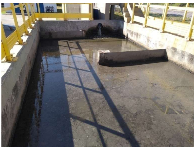
Foto 05 – Caixa de Gordura
