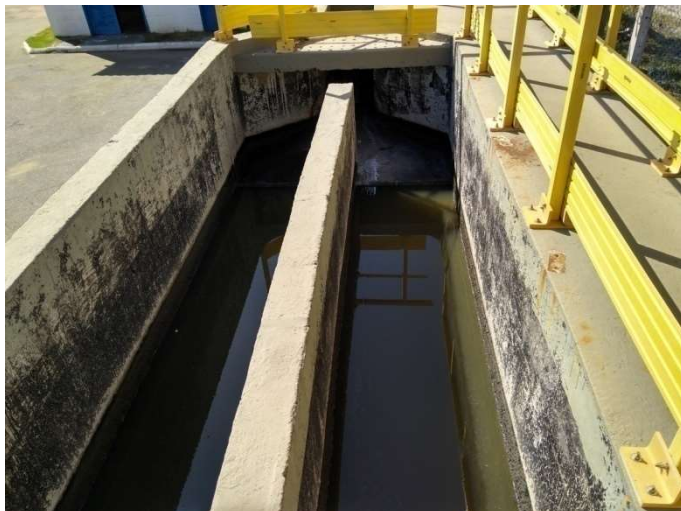
Foto 03 – Caixas de Areia (desarenador)
