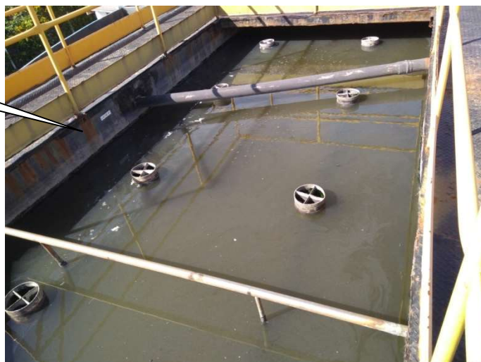
Foto 09 – Tanques Reatores UASB
