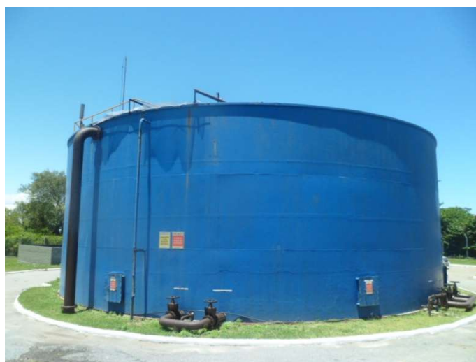
Foto 07 – Reator de Tratamento Biológico
