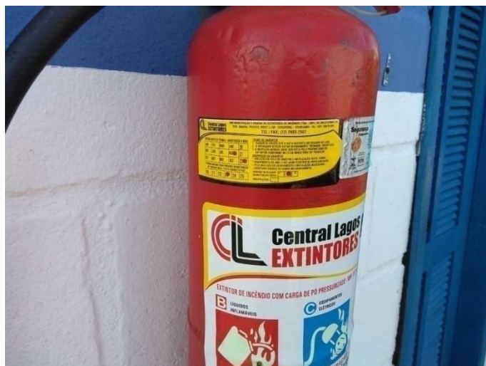
Foto 18 – Extintor de Incêndio
