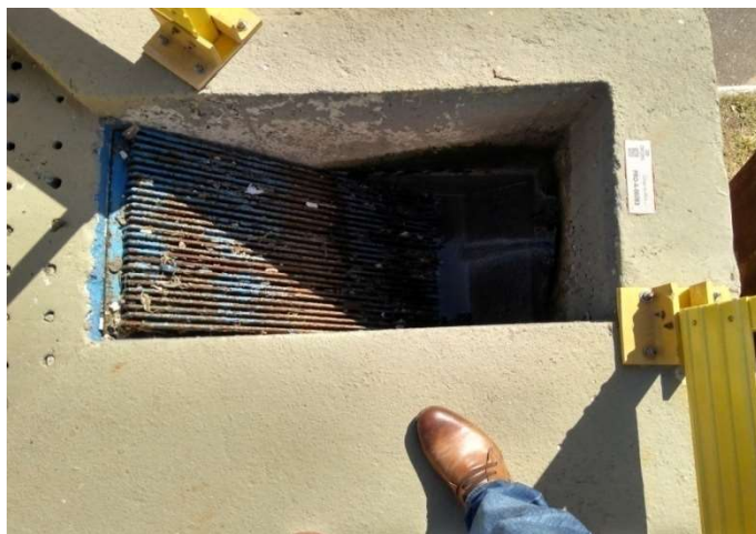
Foto 02 – Entrada do Esgoto Bruto e Gradeamento Grosso
