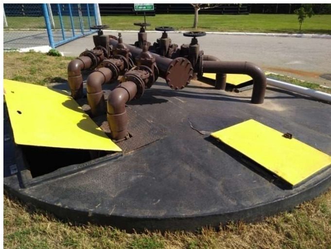
Foto 06 – Elevatória dentro da Estação
