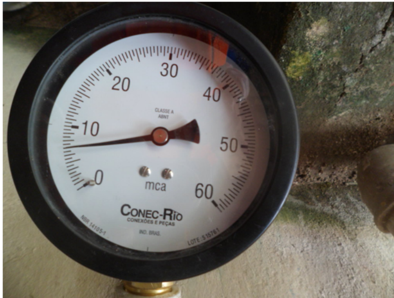
Foto 08 – Manômetro Marcando 07 M.C.A (Metros de Coluna D'água) no Último Imóvel da Rua
