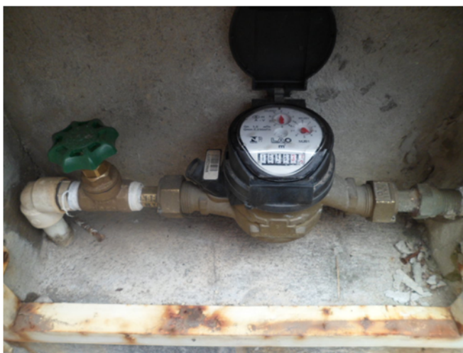
Foto 03 – Hidrômetro da Casa, Rua Modesto de Souza, 130
