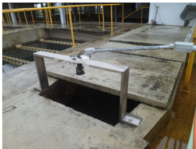
Foto 15 – Medidores de Vazão Ultrassônico na Calha Parshall
