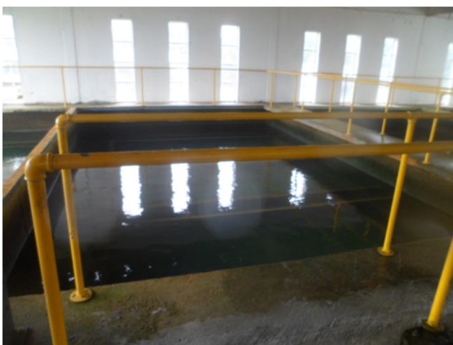
Foto 18 – Tanques de Filtros
