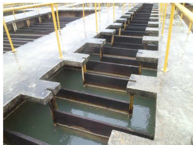
Foto 16– Tanque de Floculação
