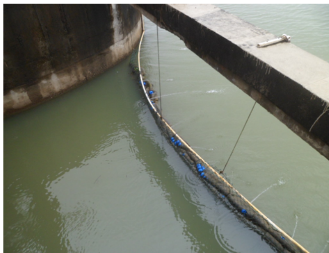
Foto 12 – Ecobarreira com Esguichos Instalados na Entrada da Captação da Água Bruta
