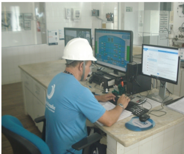
Foto 07 – Centro de Comando de Operações da ETA
