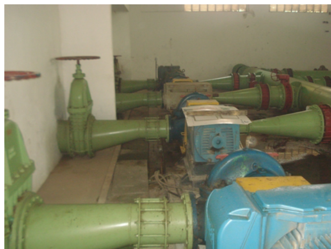
Foto 22 – Bombas e Adutoras do Alto Recalque
