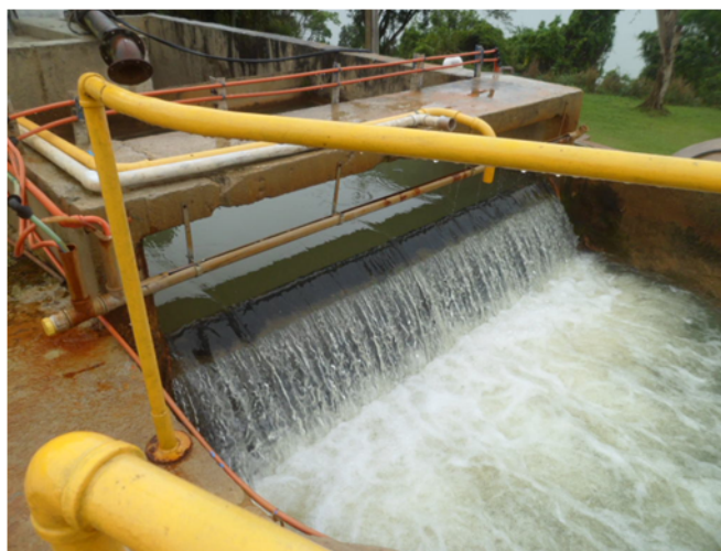
Foto 14 – Entrada de Água Bruta na ETA
