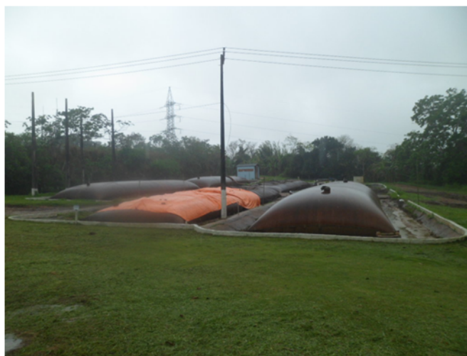
Foto 23 – Bags – Armazenamento do Lodo
