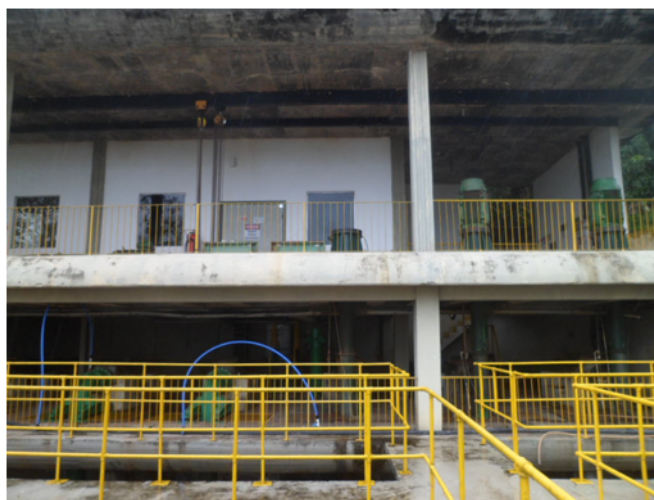
Foto 13 – Conjunto de 05 Moto Bombas na Entrada de Água Bruta Recalcando para ETA
