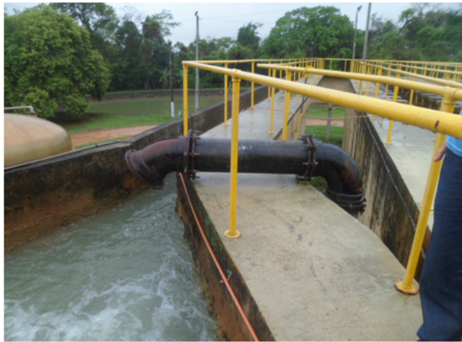
Foto 26 – Tubulação de Águas Recalcadas para o Início do Processo de Tratamento
