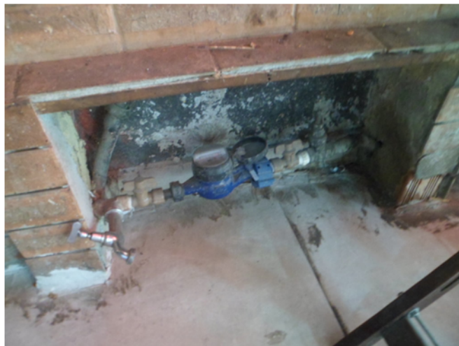
Foto 07 – Hidrômetro da Loja 2169 A
