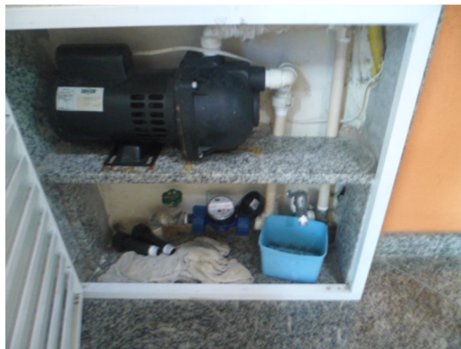
Foto 06 – Hidrômetro da Loja 2191 B
