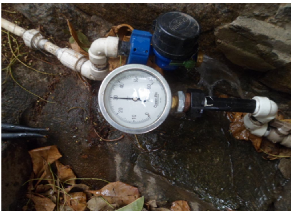
Foto 12 – Manômetro Marcando 30 M.C.A (Metros de Coluna D'água).
