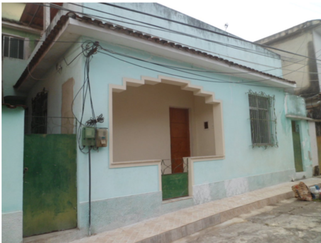
Foto 11 – Vila, Casa 17 - Foco da Denúncia, Aproximadamente a 30 m do nível da Rua
