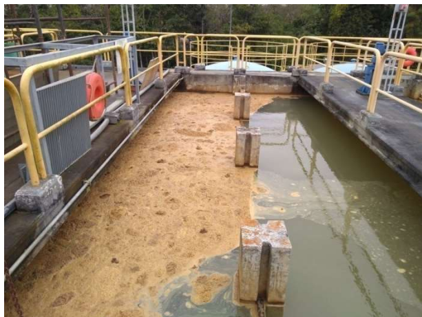
Foto 06 – Tanques de Flocculação
