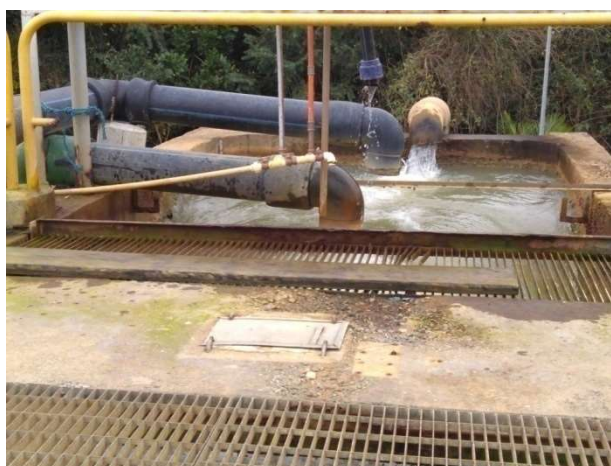
Foto 05 – Entrada da Água Bruta na ETA
