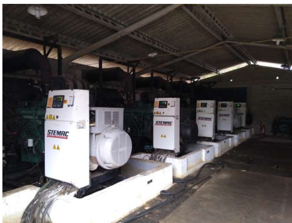
Foto 29 – Total de 07 (sete) Geradores para Atendimento da ETA
