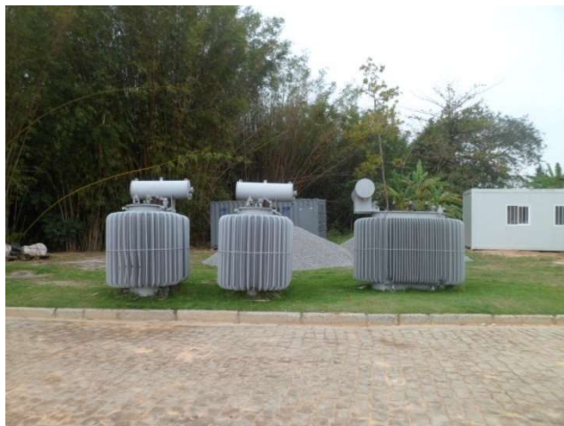
Foto 39 – 03 (três) Transformadores para Ampliação da ETA
