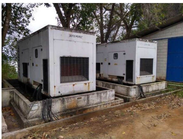
Foto 28 – Geradores da ETA
