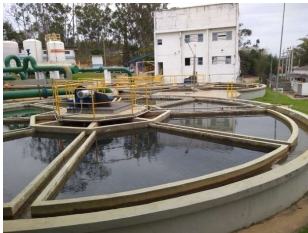
Foto 09 – Tanques de Decantação da ETA 1
