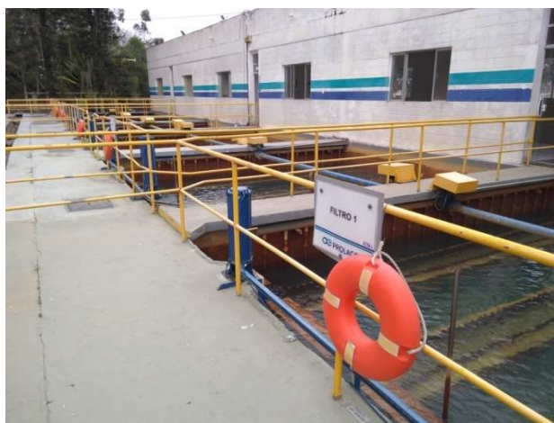
Foto 10 – Tanques de filtros – Sistema de Filtração da ETA1
