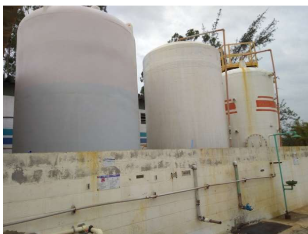
Foto 11 – Tanques Policloreto de Alumínio (PAC) e Fluor
