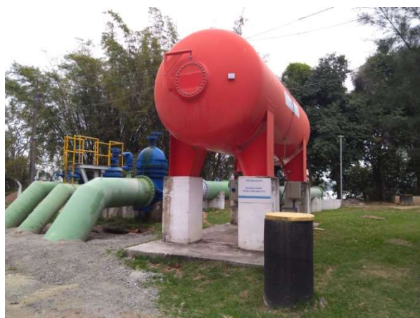
Foto 26 – Tanque Hidropneumático – Atua como Amortecedor
