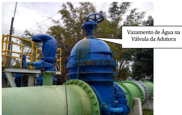
Foto 42 – Válvula da Adutora com Vazamento
