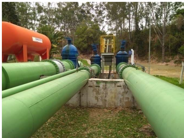
Foto 27 – Adutoras com Macromedidores que Abastecem as Cidades Atendidas pela PROLAGOS
