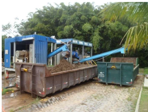
Foto 20 – Centrífugas para Desidratação do Lodo e Lançamento do Lodo Desidratado nas Caçambas 7m 3 Cada
