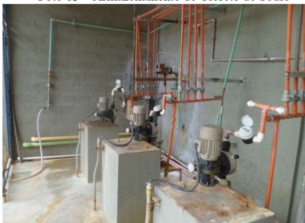
Foto 14 – Bombas Dosadoras Automatizadas de hipoclorito de sódio
