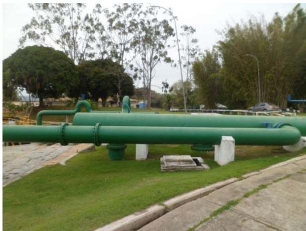
Foto 03 – Adutoras da ETA – 1
