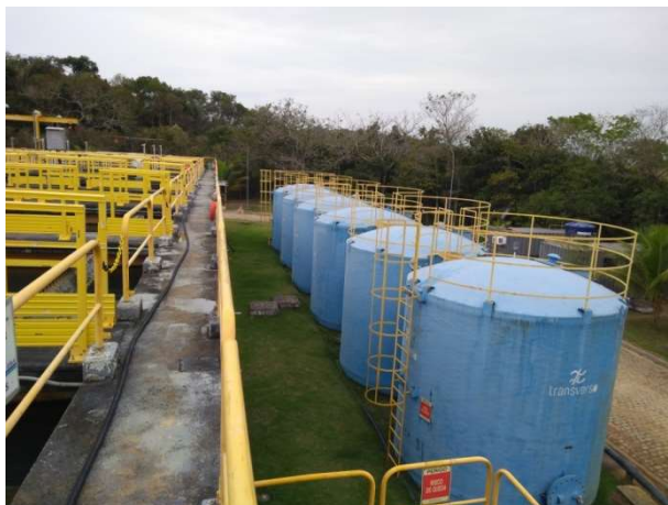
Foto 18 – Reservatórios Azuis de Armazenamento de Lodo 50.000 Litros Cada
