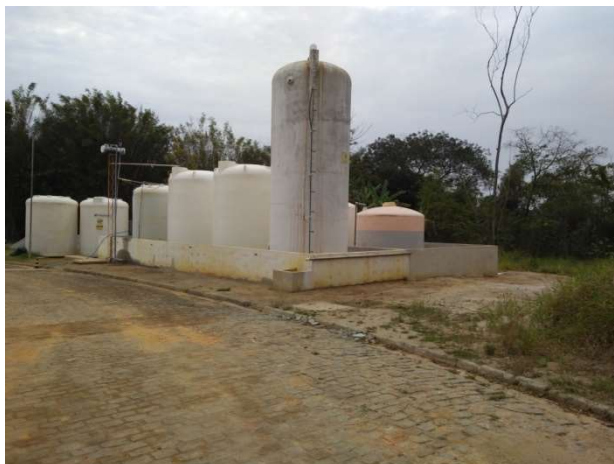
Foto 15 – Reservatórios: 3 hipoclorito de sódio e 4 PAC
