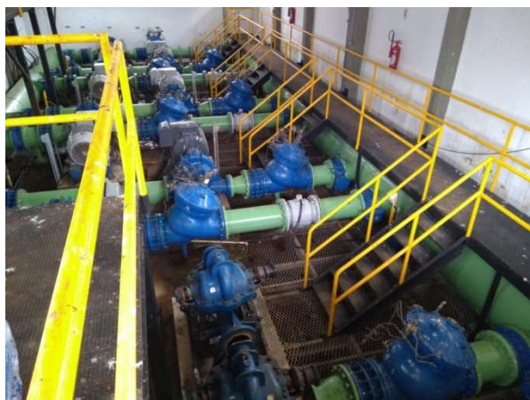
Foto 25 – 08 (oito) Bombas e Adutoras do Alto Recalque
