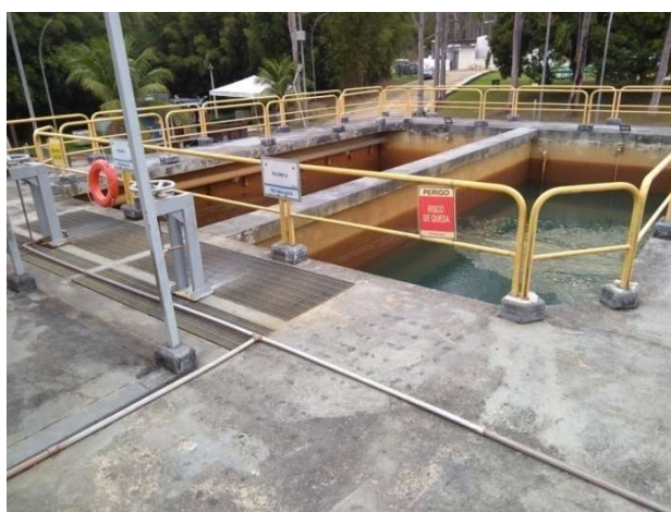
Foto 08 – Tanques de filtros – Sistema de Filtração da ETA2
