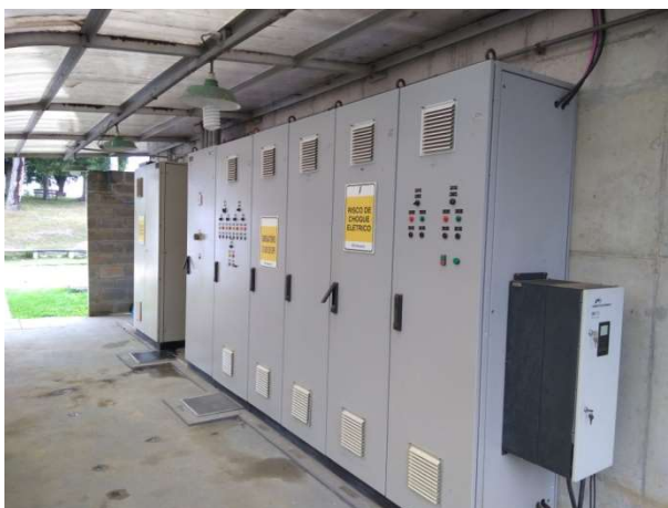
Foto 17 – Painéis de Comando das lavagens dos Filtros Comandadas pelo CCO
