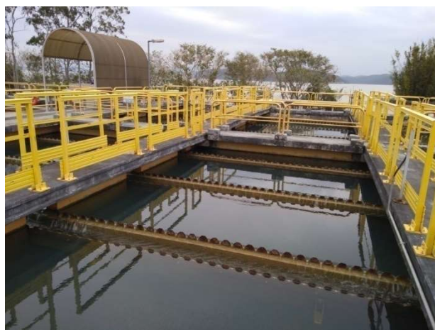
Foto 07 – Tanques de Decantação da ETA 2
