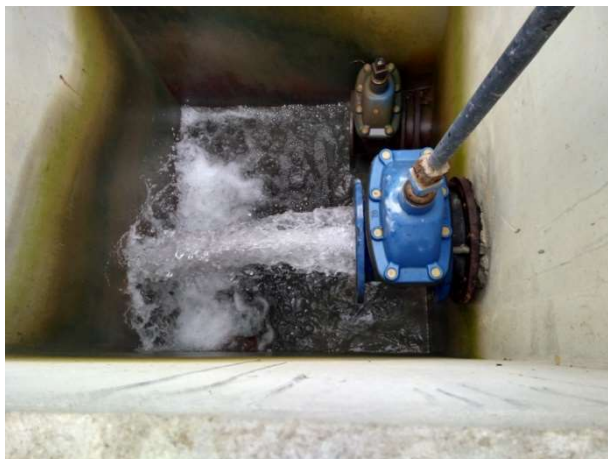
Foto 24 – Água da Lagoa de Lavagem dos Filtros para o Início do Processo de Tratamento
