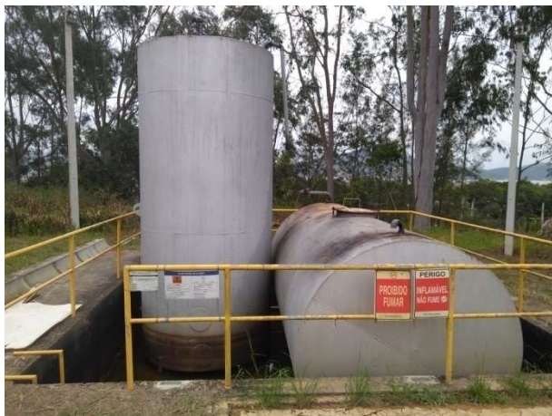
Foto 30 – Tanques de Diesel, Abastecimento dos Geradores da ETA
