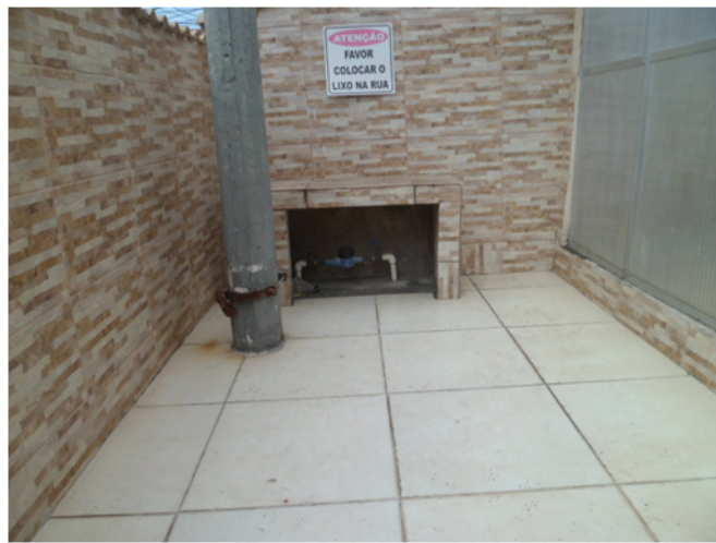
Foto 02 – Caixa do Hidrômetro
