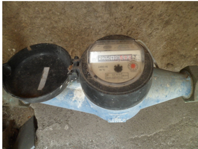
Foto 03 – Hidrômetro do Imóvel
