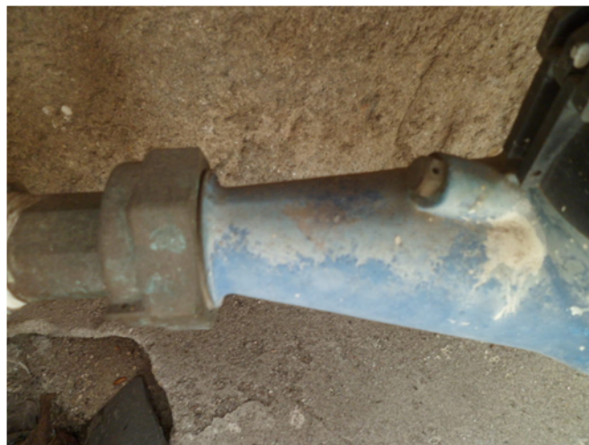
Foto 04 – Hidrômetro sem o lacre
