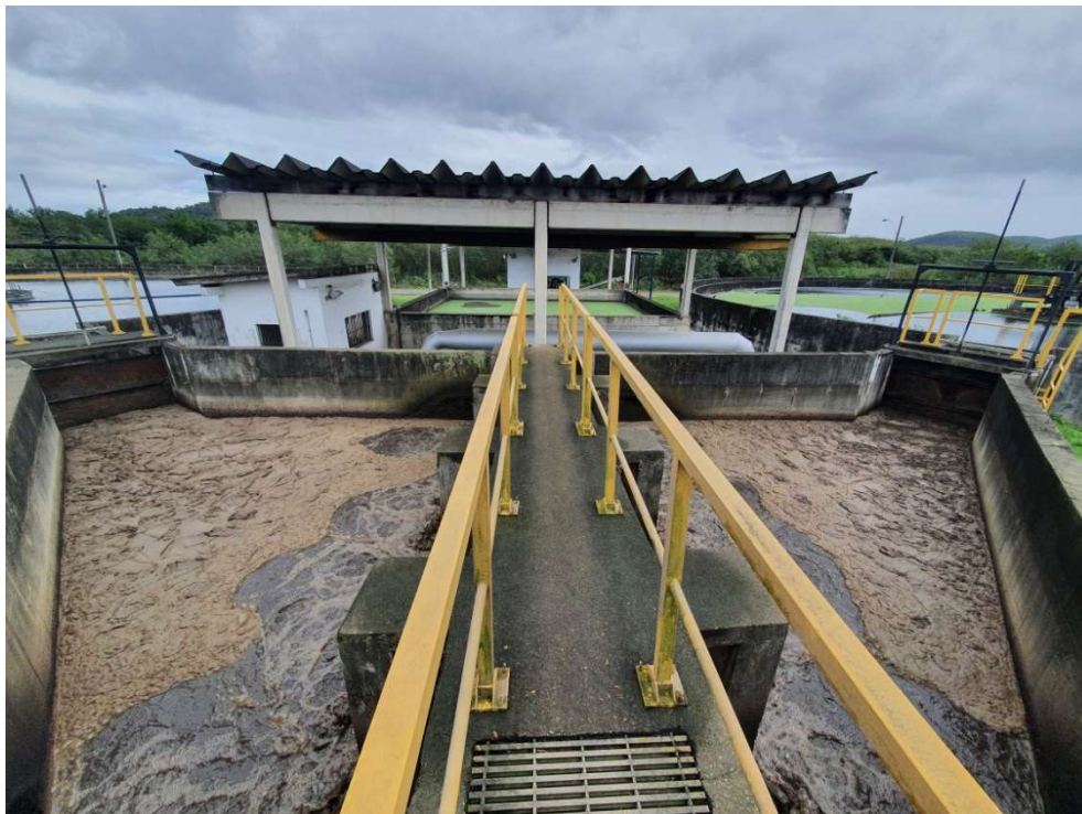
Foto 19 – Caixa de transição
