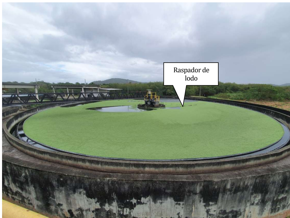
Foto 21 – Decantador secundário inoperante
