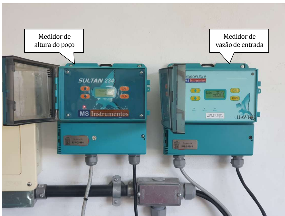
Foto 38 – Medidor de vazão e de altura do poço
