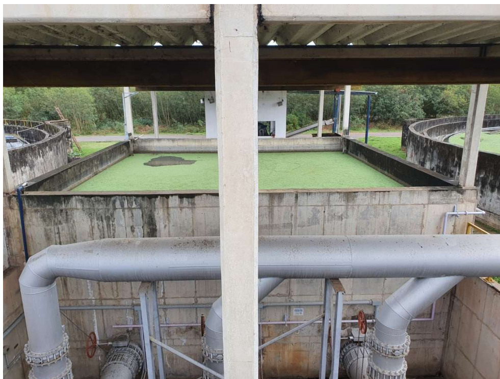
Foto 22 – Tanque de recirculação
