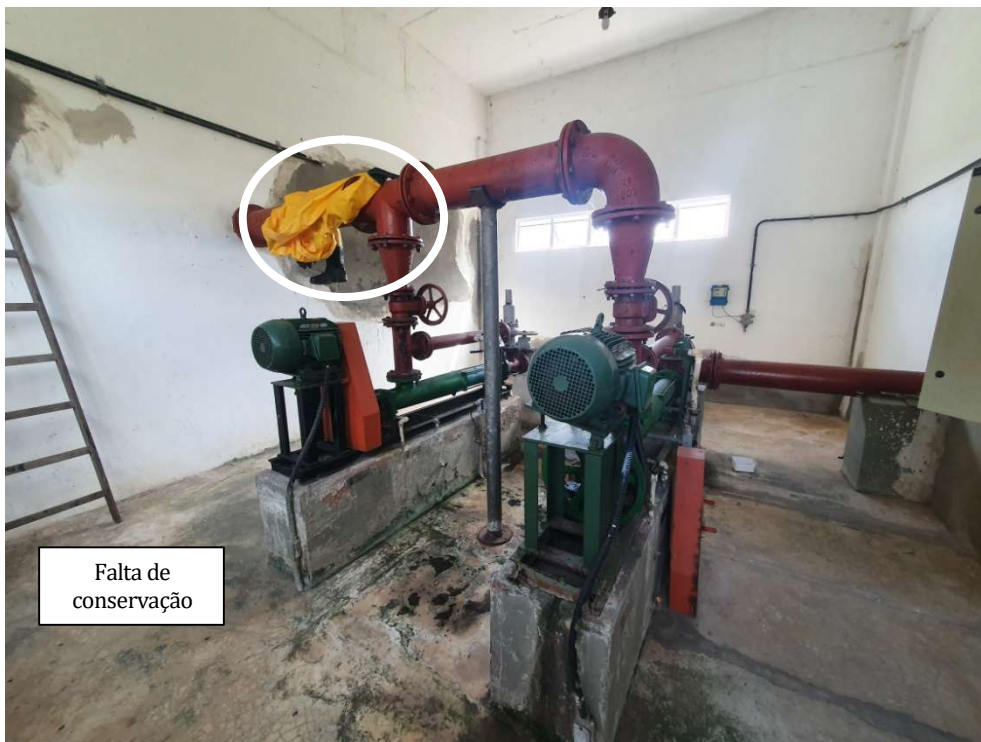
Foto 28 – Casa de bombas
