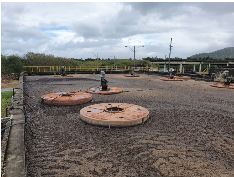
Foto 17 – tanque de aeração
