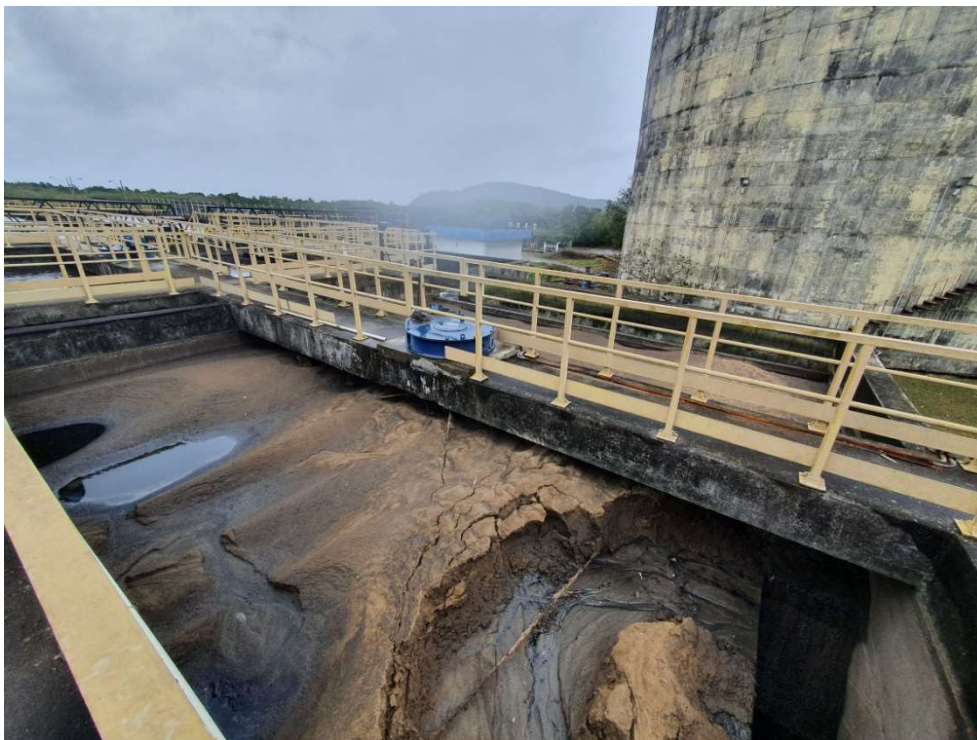
Foto 07 – Desarenador inoperante, raspador em manutenção
