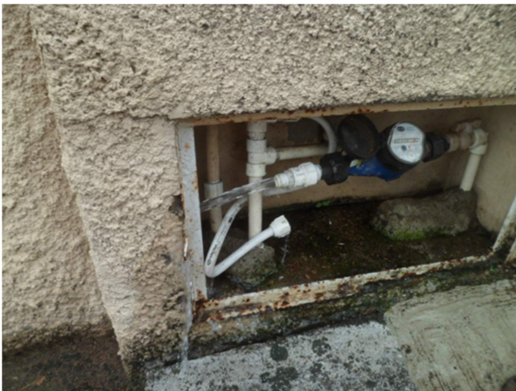
Foto 05 – Hidrômetro com Fornecimento de Água normalizado
