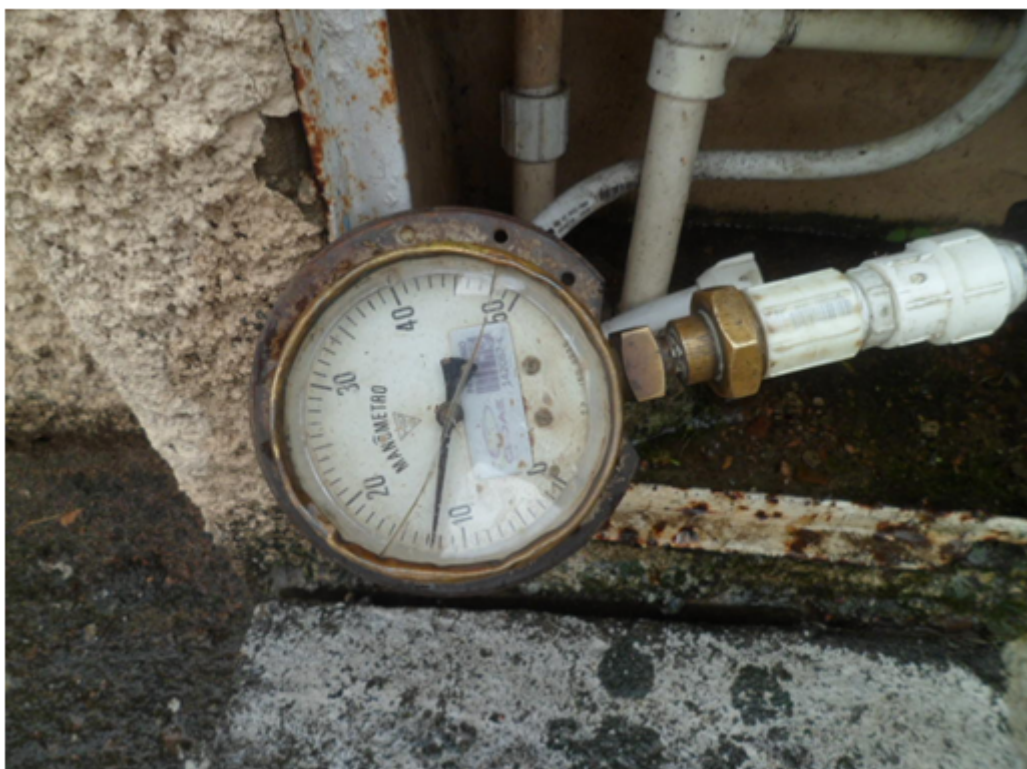
Foto 06 – Manômetro Marcando 13 M.C.A (Metros de Coluna D'água).
