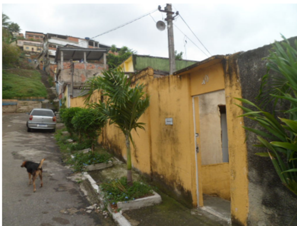
Foto 08 – Possível vazamento em frente ao número 40
