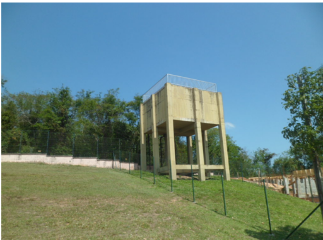
Foto 05 – Castelo de Abastecimento do Condomínio Alphaville 3, com capacidade de 97.000 Lt.
