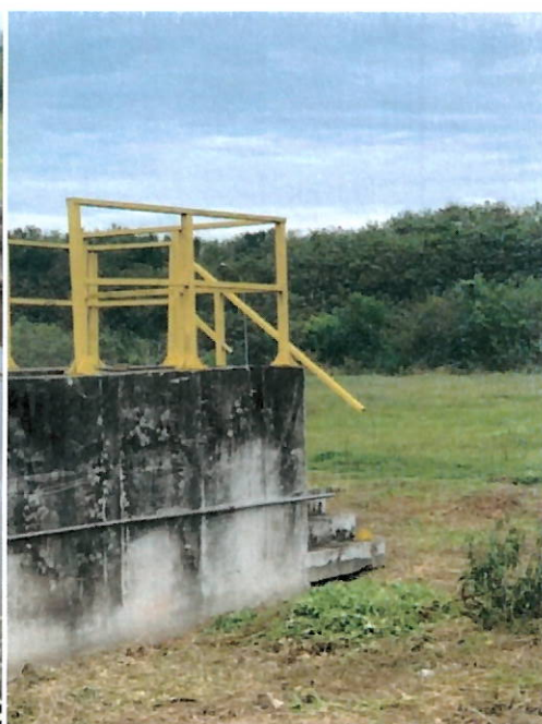
Escada lateral avariada
