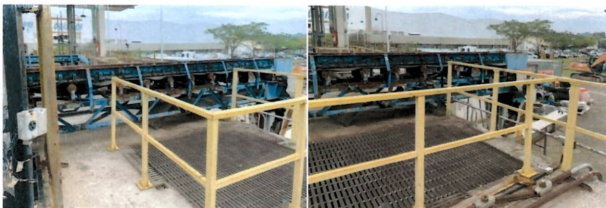
Esteira que transporta areia retirada deteriorada e com falhas na estrutura
