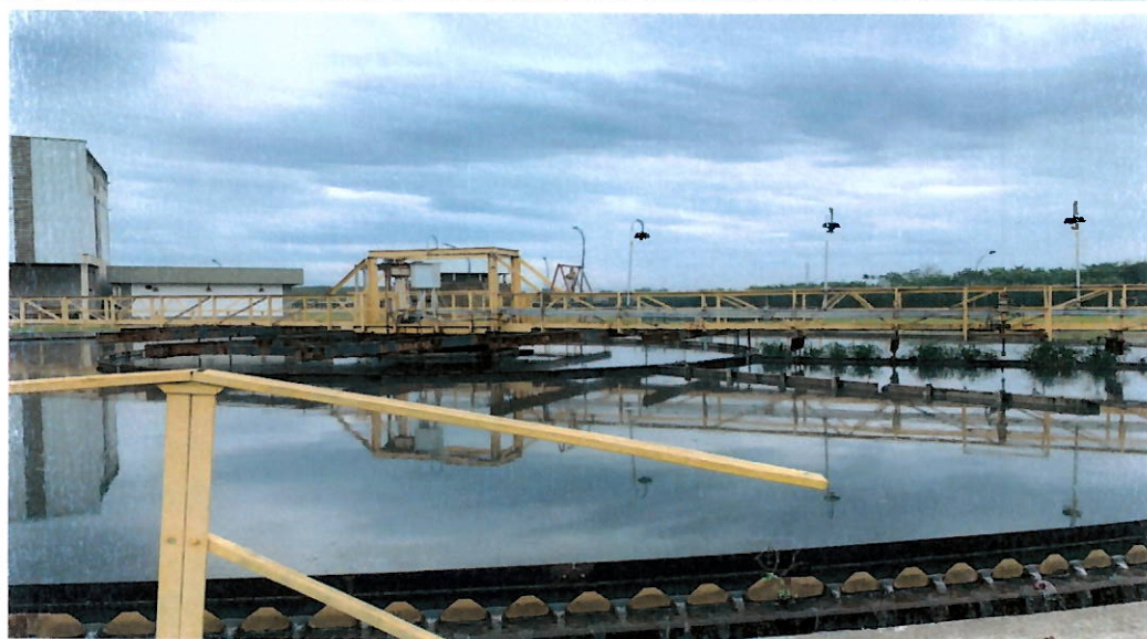
Decantador primário em operação com grade quebrada
