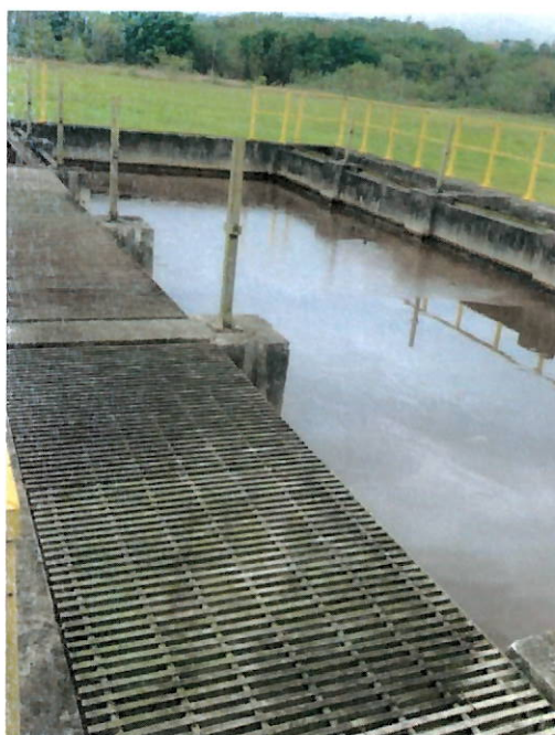
Tanque para recirculação do lodo
