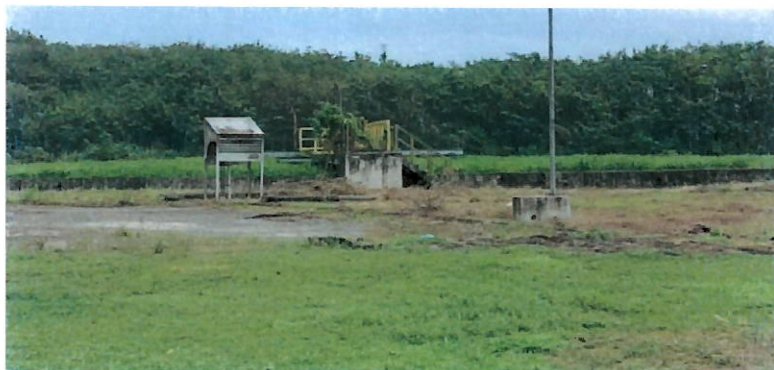
Decantador secundário em desuso com vegetação crescendo livremente
