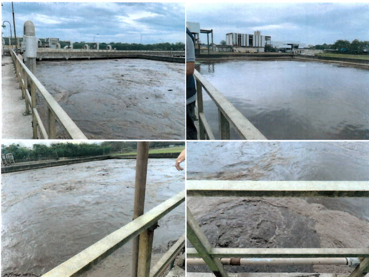
Tanque de aeração em funcionamento
