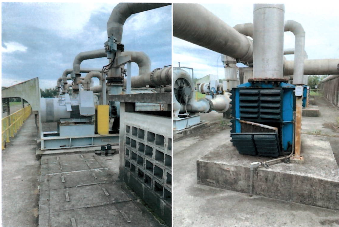
Compressor do tanque de aeração
