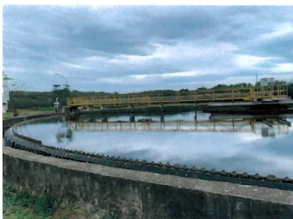
Decantador secundário operando
