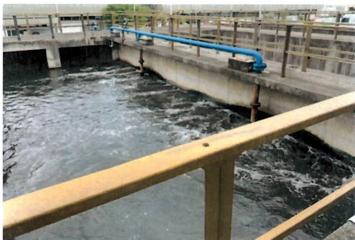
Desarenador em operação
