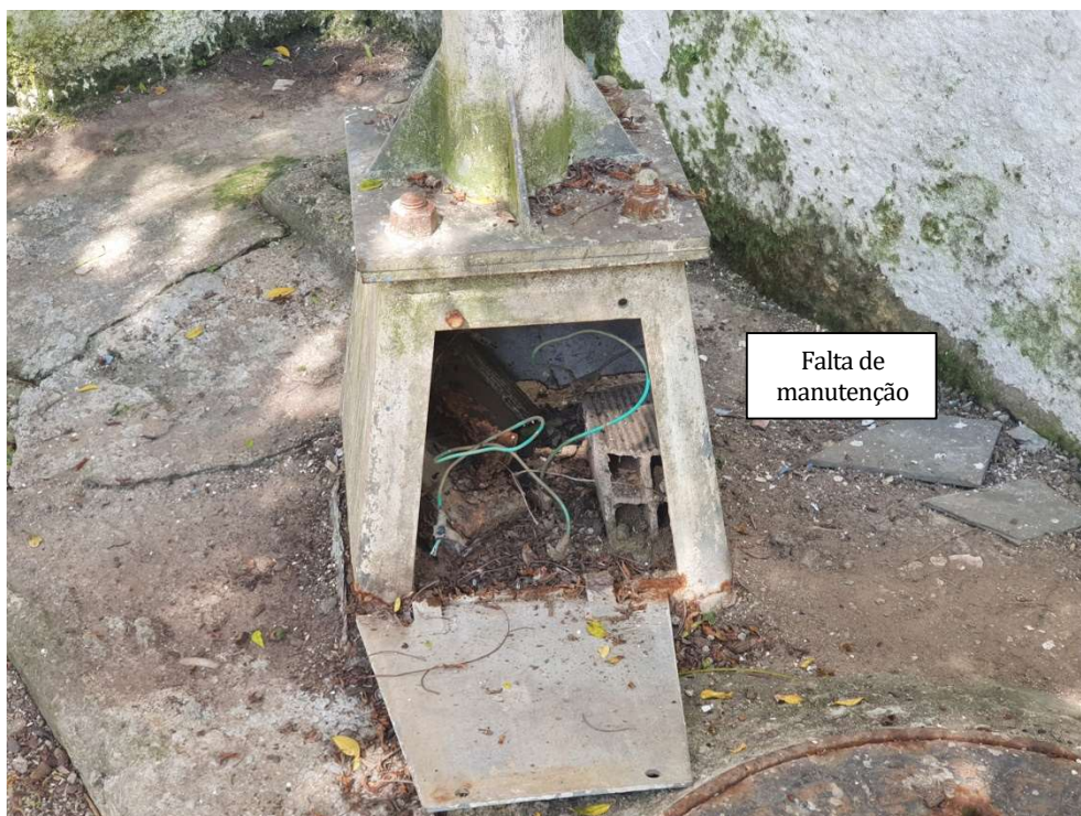
Foto 13 – Fios do poste de iluminação expostos ao tempo
