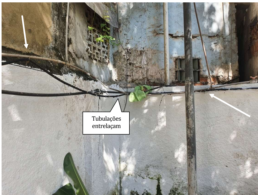
Foto 18 – Eletroduto próximo a rede de água
