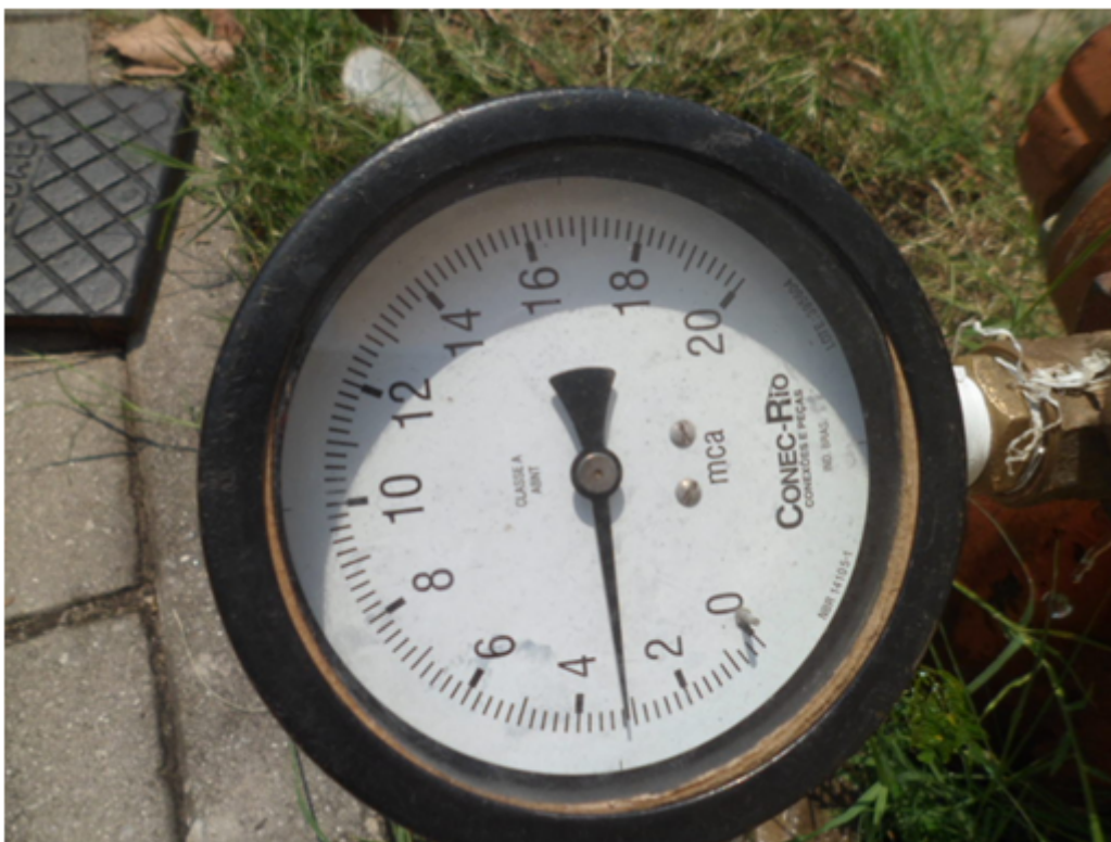
Foto 05 – Manômetro Marcando 3,2 M.C.A (Metros de Coluna D'água)
