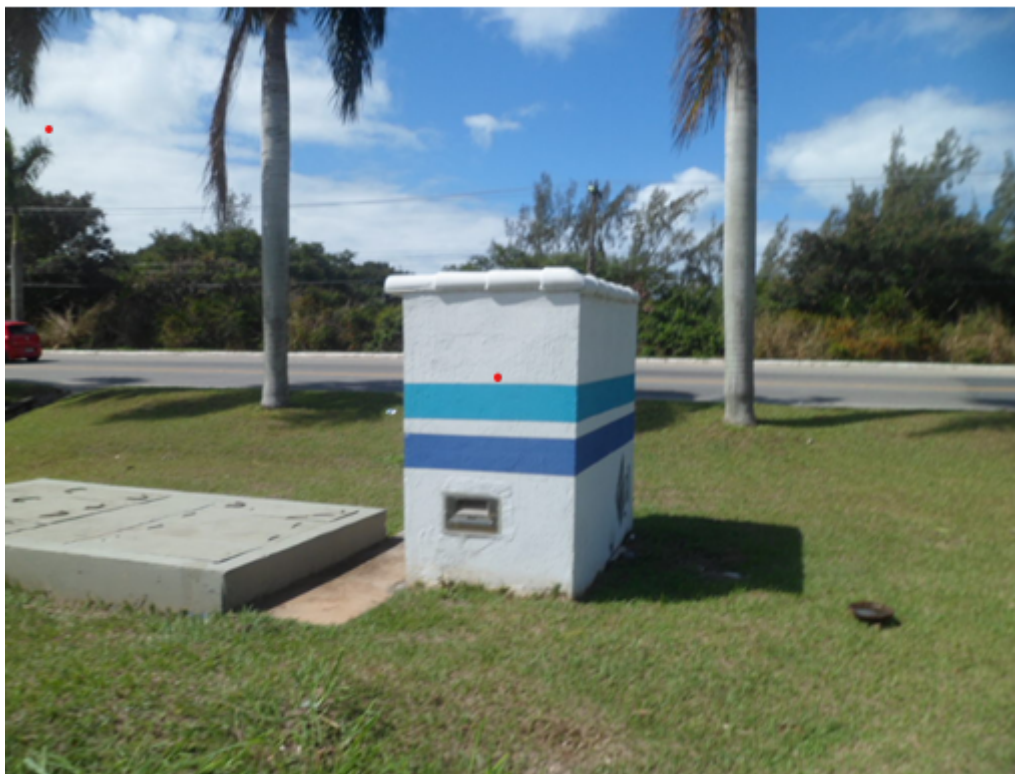
Foto 01 – Estação Elevatória de Esgoto em frente a Ocorrência, Av. Amaral Peixoto 61
