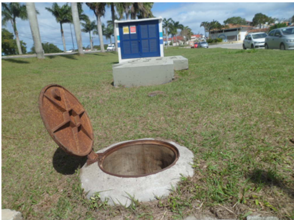
Foto 04 – Caixa de Passagem para EEE
