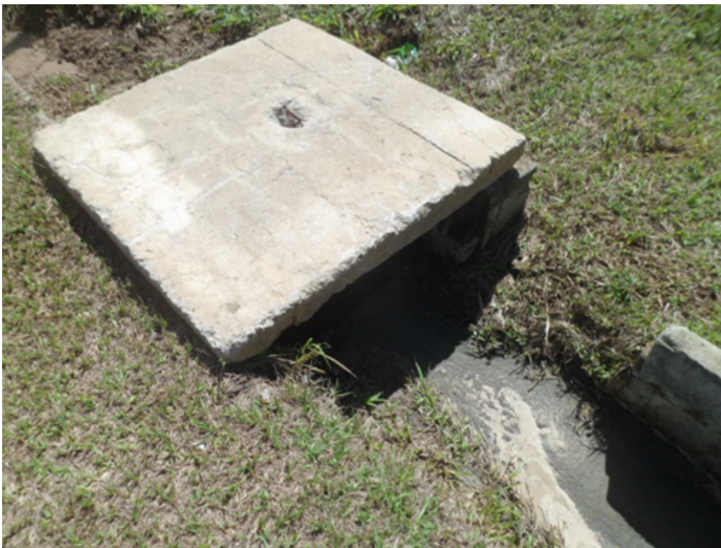
Foto 06 – Calha e Caixa de Areia
