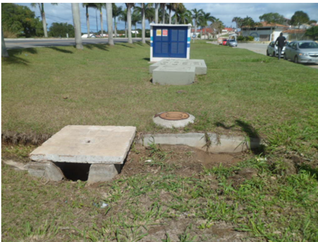
Foto 03 – Caixa de Areia e Caixa de Passagem para EEE.
