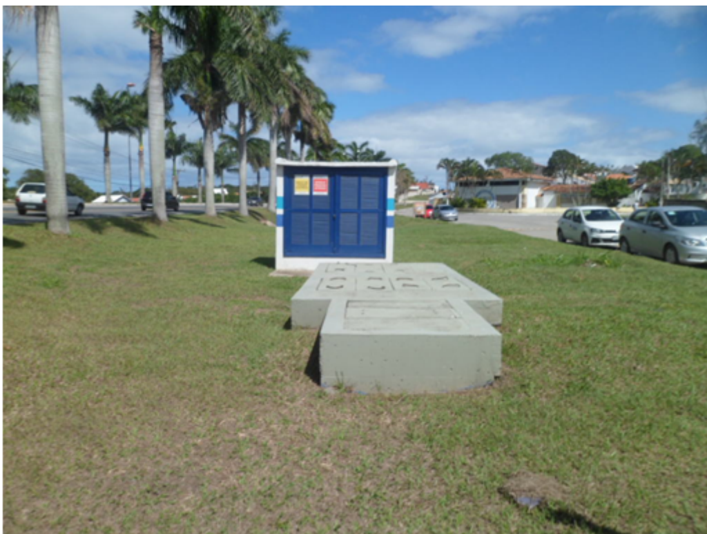
Foto 02 – Estação Elevatória de Esgoto vista de frente
