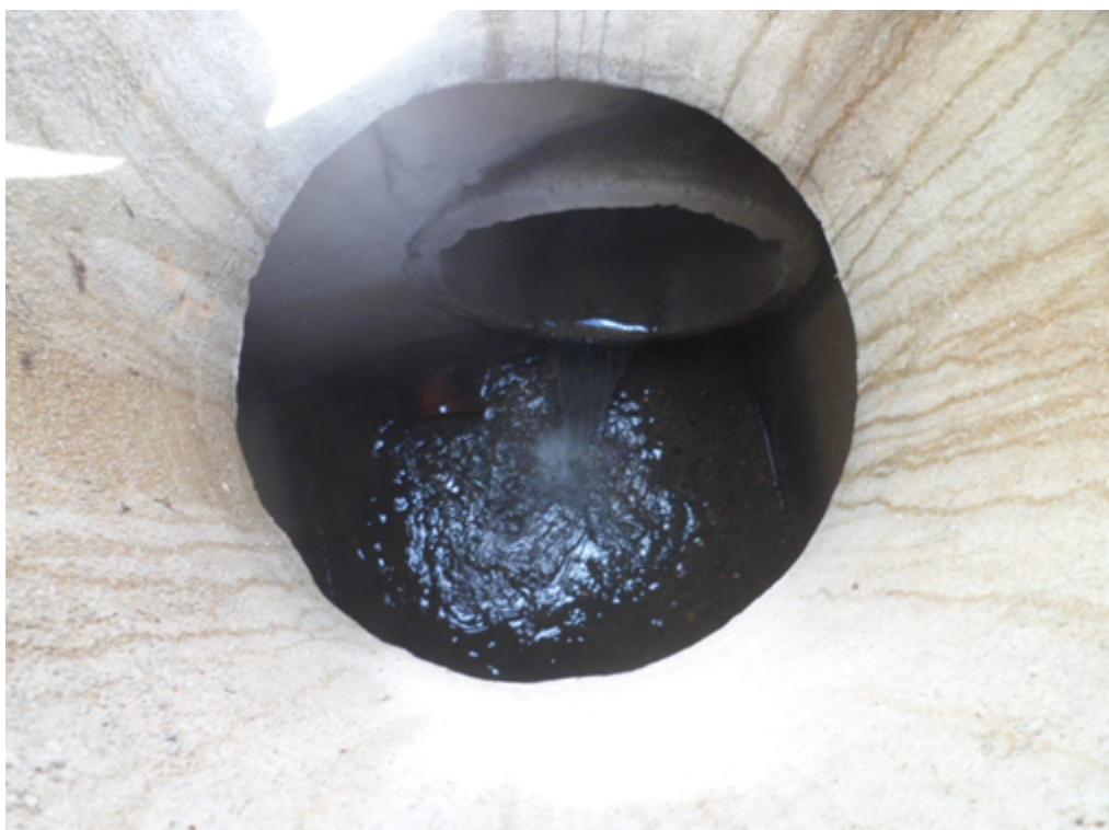
Foto 05 – Caixa de Passagem para EEE, com fluxo de água
