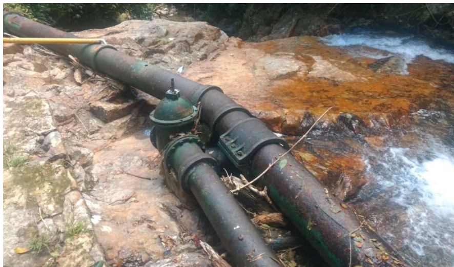
Tubulação de adução DN 400 mm da captação Mendanha
