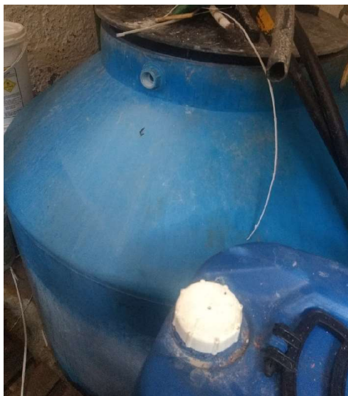
Tanque onde armazena o flúor
