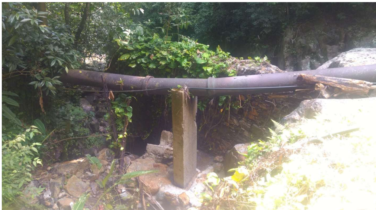
Tubulação de adução DN 400 mm da captação Mendanha
