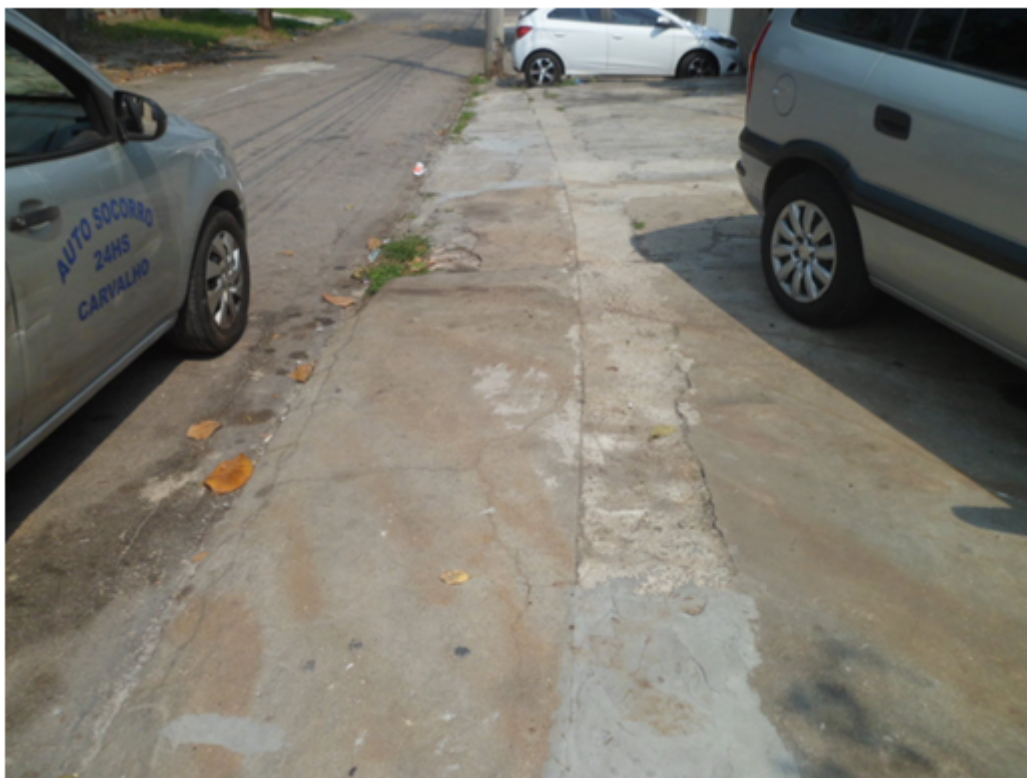
Foto 07 – Rua Capitão Cruz – Marcas da obra de substituição de rede
