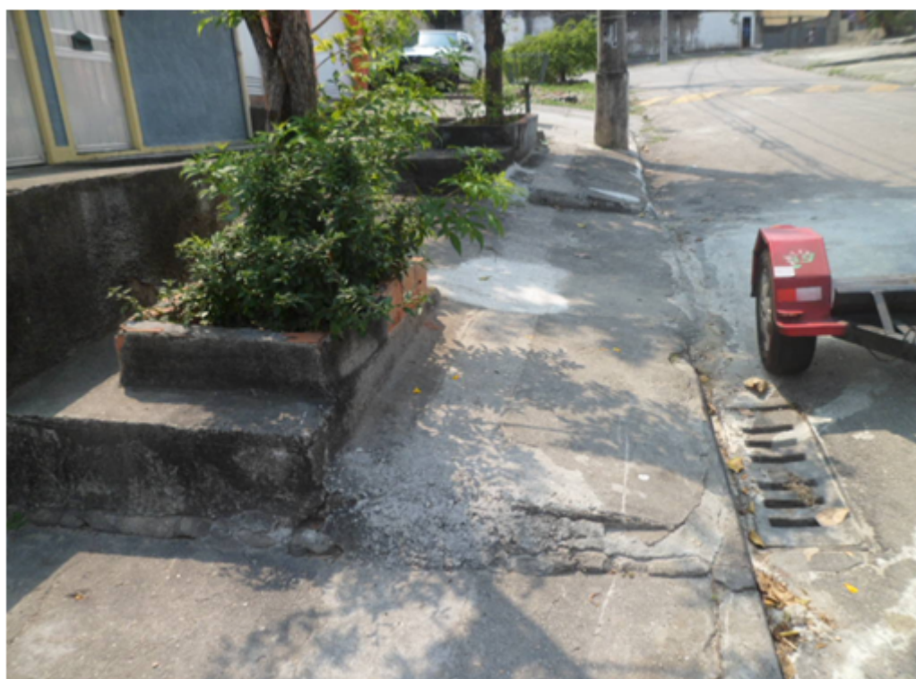
Foto 08 – Rua Capitão Cruz – Marcas da obra de substituição de rede
